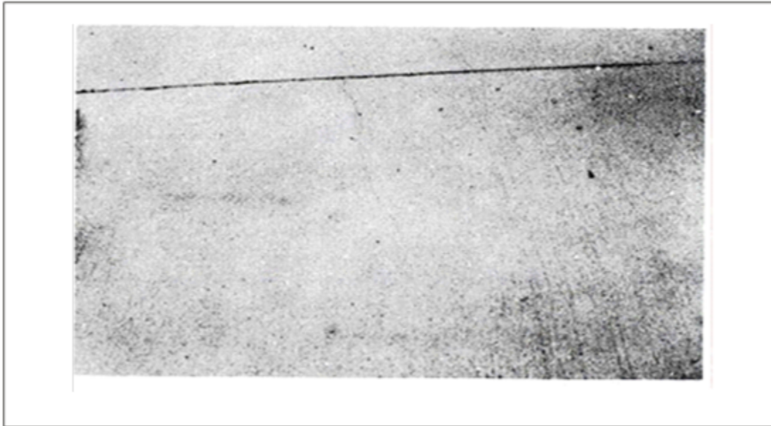
Figura 2.20: Grietas de Contracción.
