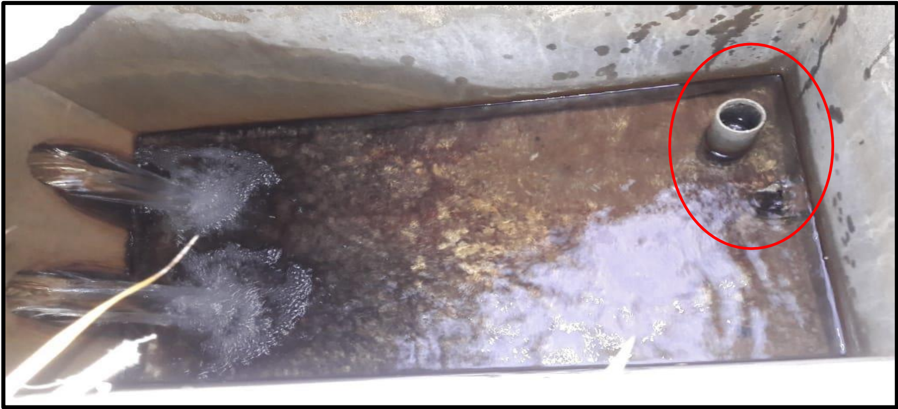
Figura 19: Fotografía, donde se observa la falta de mantenimiento de la captación, al no contar con el cono de rebose, ni canastilla.
