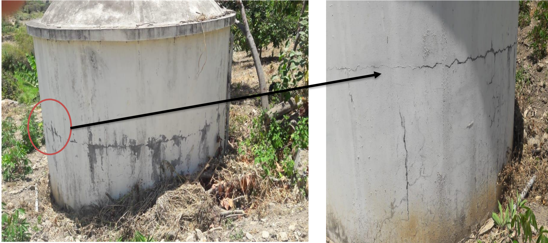
Figura 23 Y 24: Fotografía, donde se observa agrietamiento en reservorio de almacenamiento
