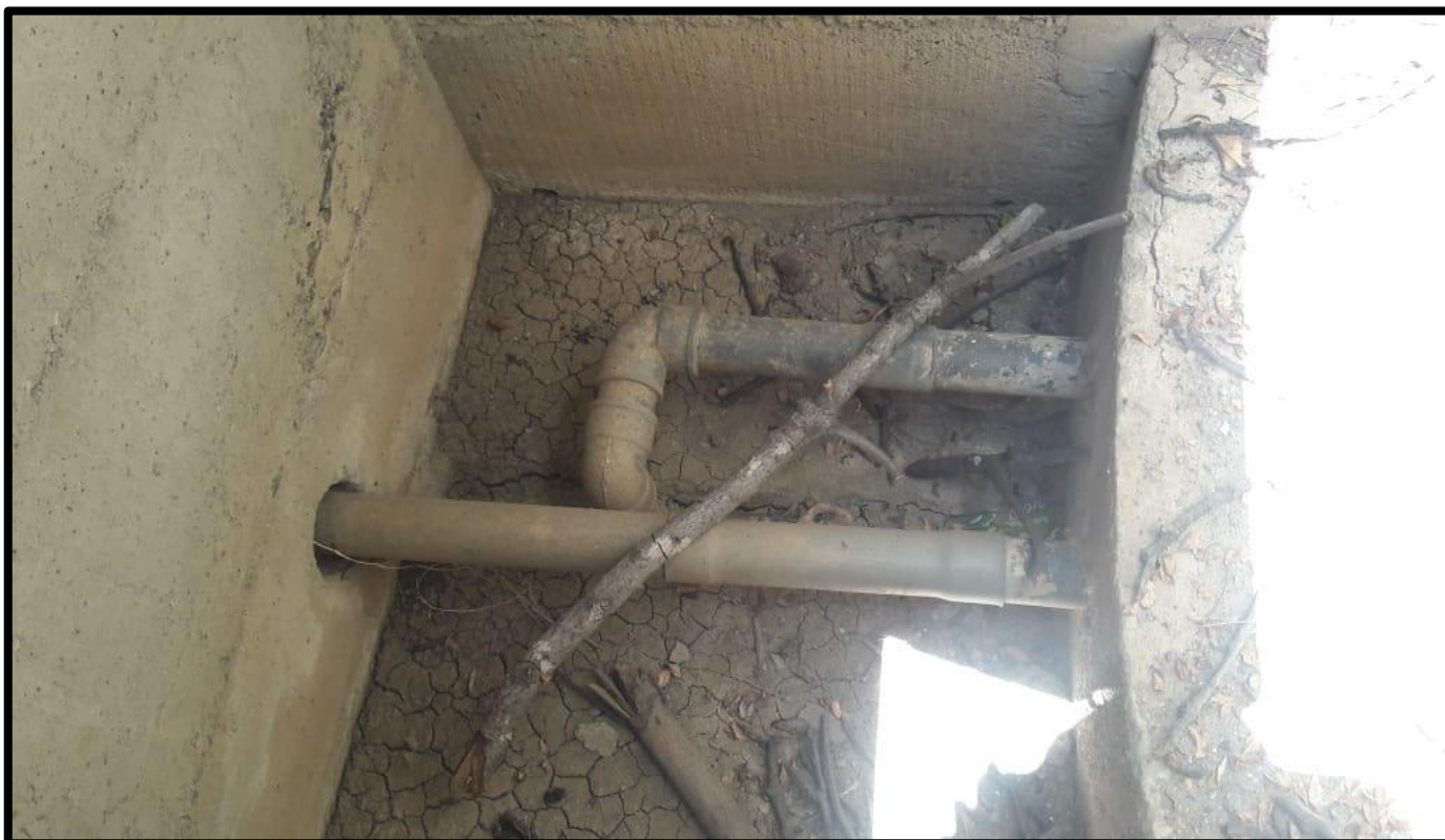
Figura 27: Fotografía de la caseta de válvulas del reservorio de almacenamiento, sobre la falta de válvulas y By pass.
