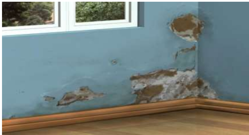
Figura 31: Eflorescencia en un Muro de una Vivienda.
