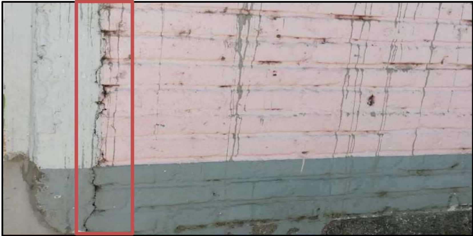
Fotografía 9: Grieta presente en la Columna de la Institución Educativa Inicial 1563 Cristo Rey Amigo de los Niños en la Unidad Muestral 01.
