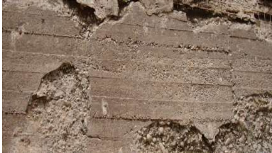
Figura 30: Erosión del revestimiento.
