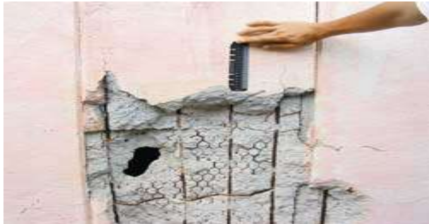
Figura 24: Lesiones Mecánicas – Desprendimientos.
