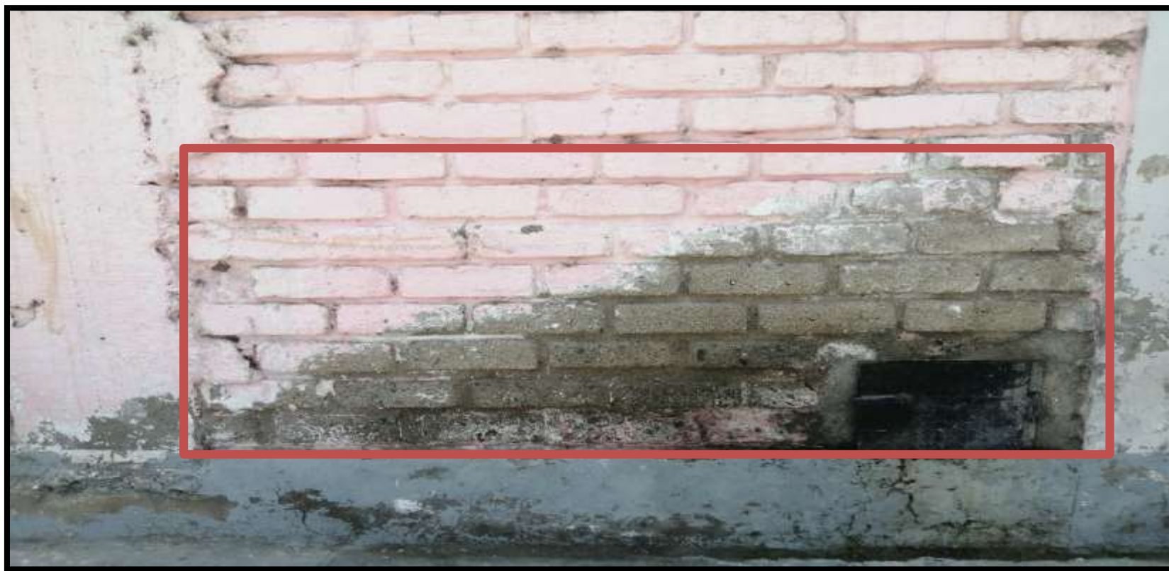
Fotografía 6: Erosión presente en el Muro de la Institución Educativa Inicial 1563 Cristo Rey Amigo de los Niños en la Unidad Muestral 07.
