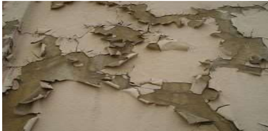
Figura 26: Desconchado en el Muro.
