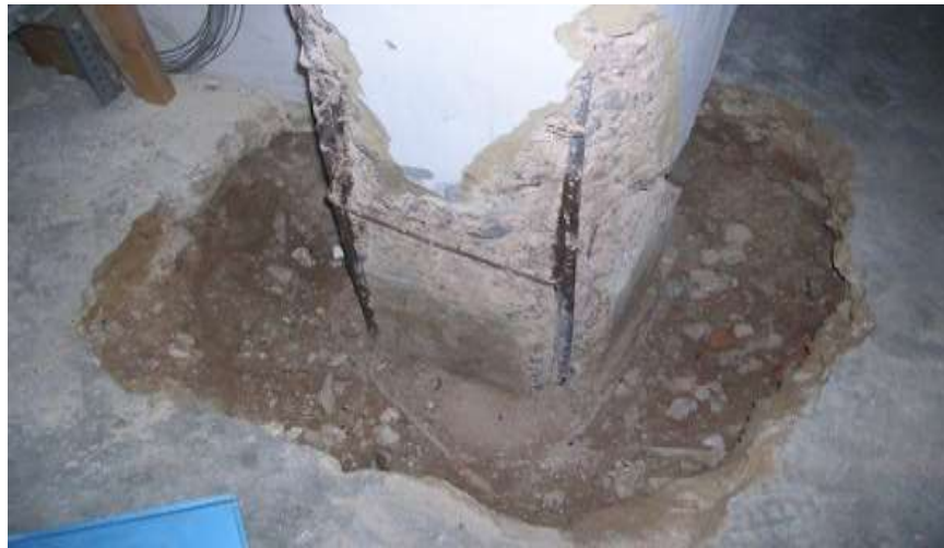
Figura 32: Corrosión del acero en una Columna.
