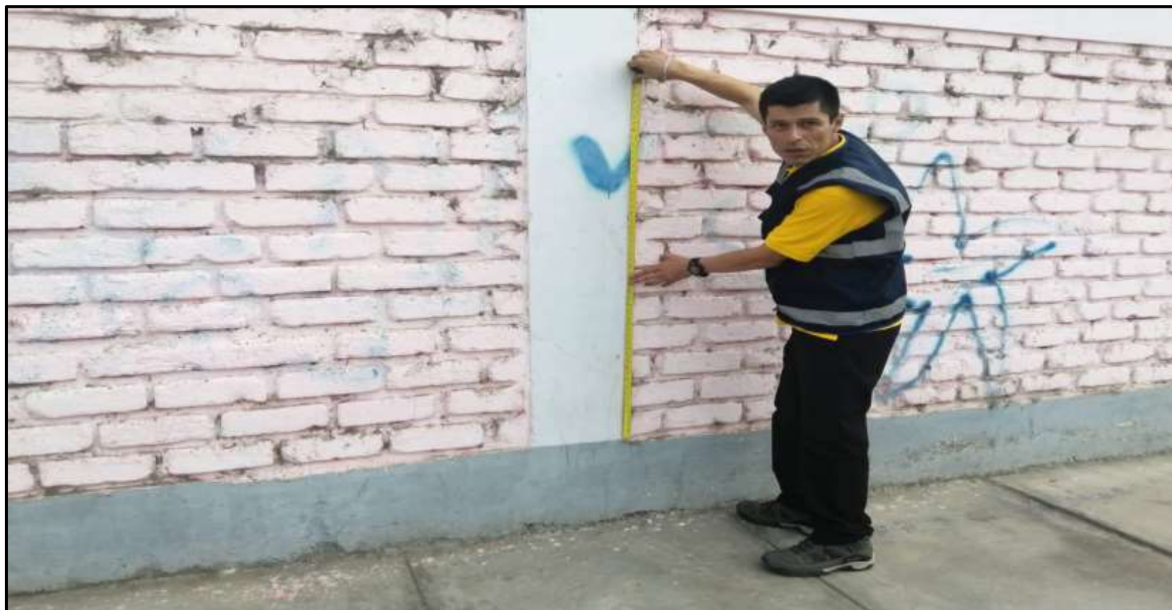
Fotografía 15: Medición de la Patología Fisura en la Columna de la Institución Educativa Inicial 1563 Cristo Rey Amigo de los Niños en la Unidad Muestral 08.
