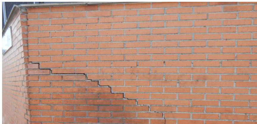
Figura 25: Grietas en Muros de Albañilería.
