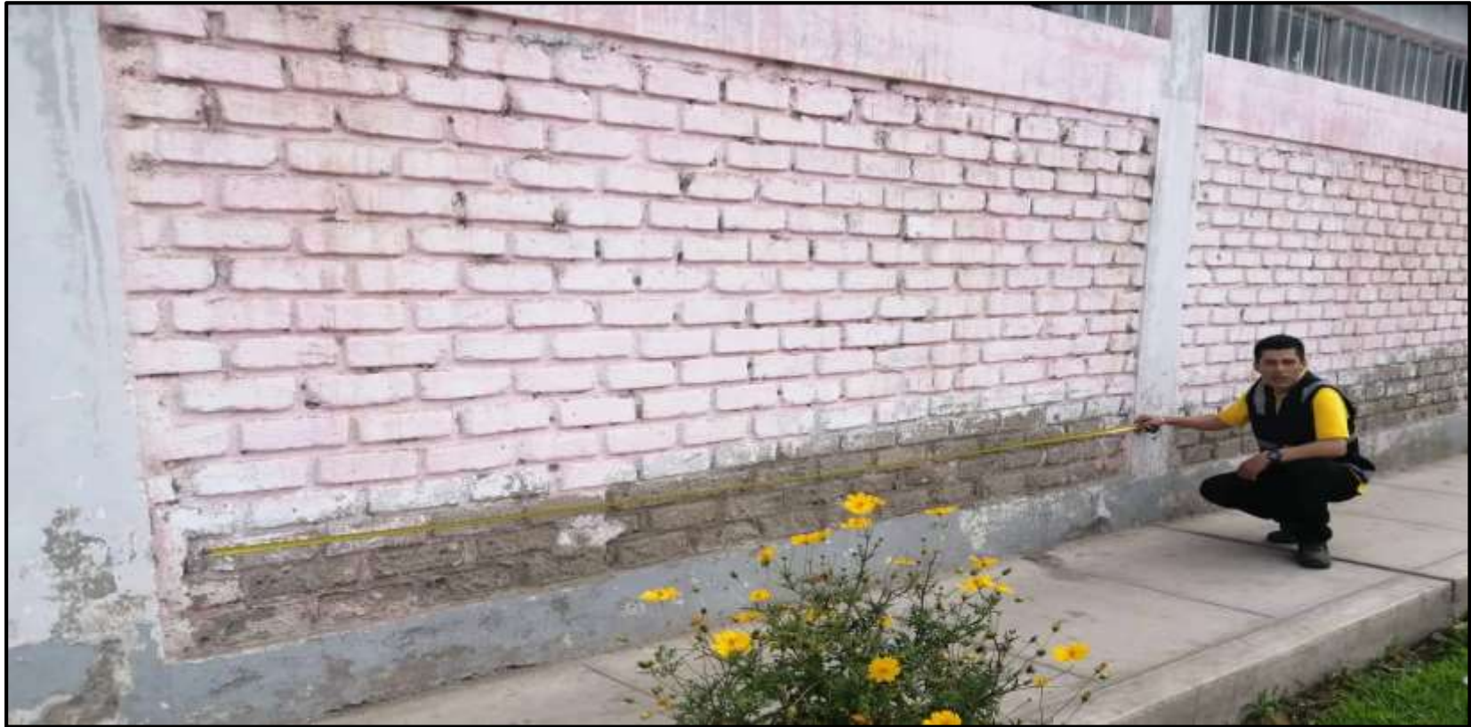
Fotografía 14: Medición de la Patología Erosión en el Muro de la Institución Educativa Inicial 1563 Cristo Rey Amigo de los Niños en la Unidad Muestral 09.
