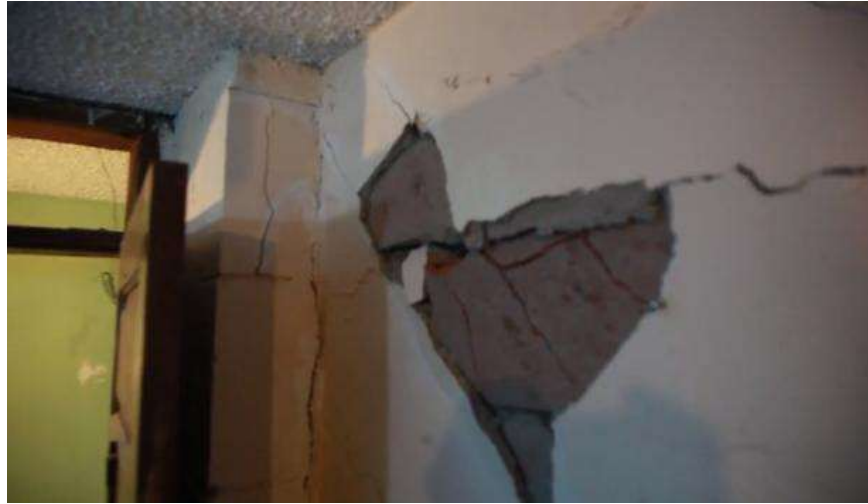
Figura 29: Desprendimiento del tarrajeo en un Muro.
