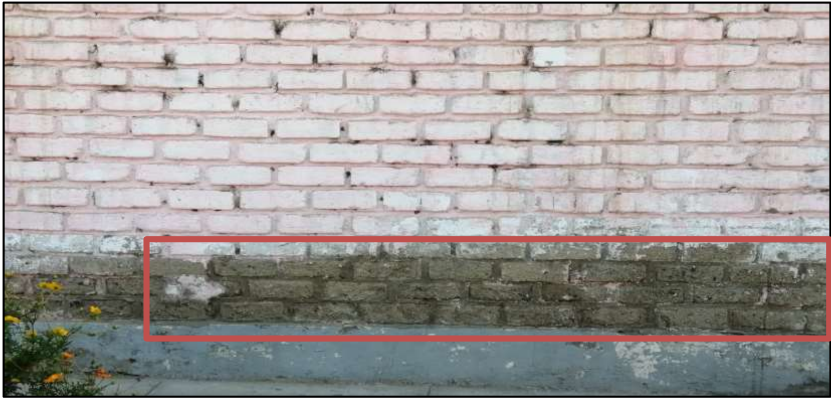
Fotografía 5: Erosión presente en el Muro de la Institución Educativa Inicial 1563 Cristo Rey Amigo de los Niños en la Unidad Muestral 10.
