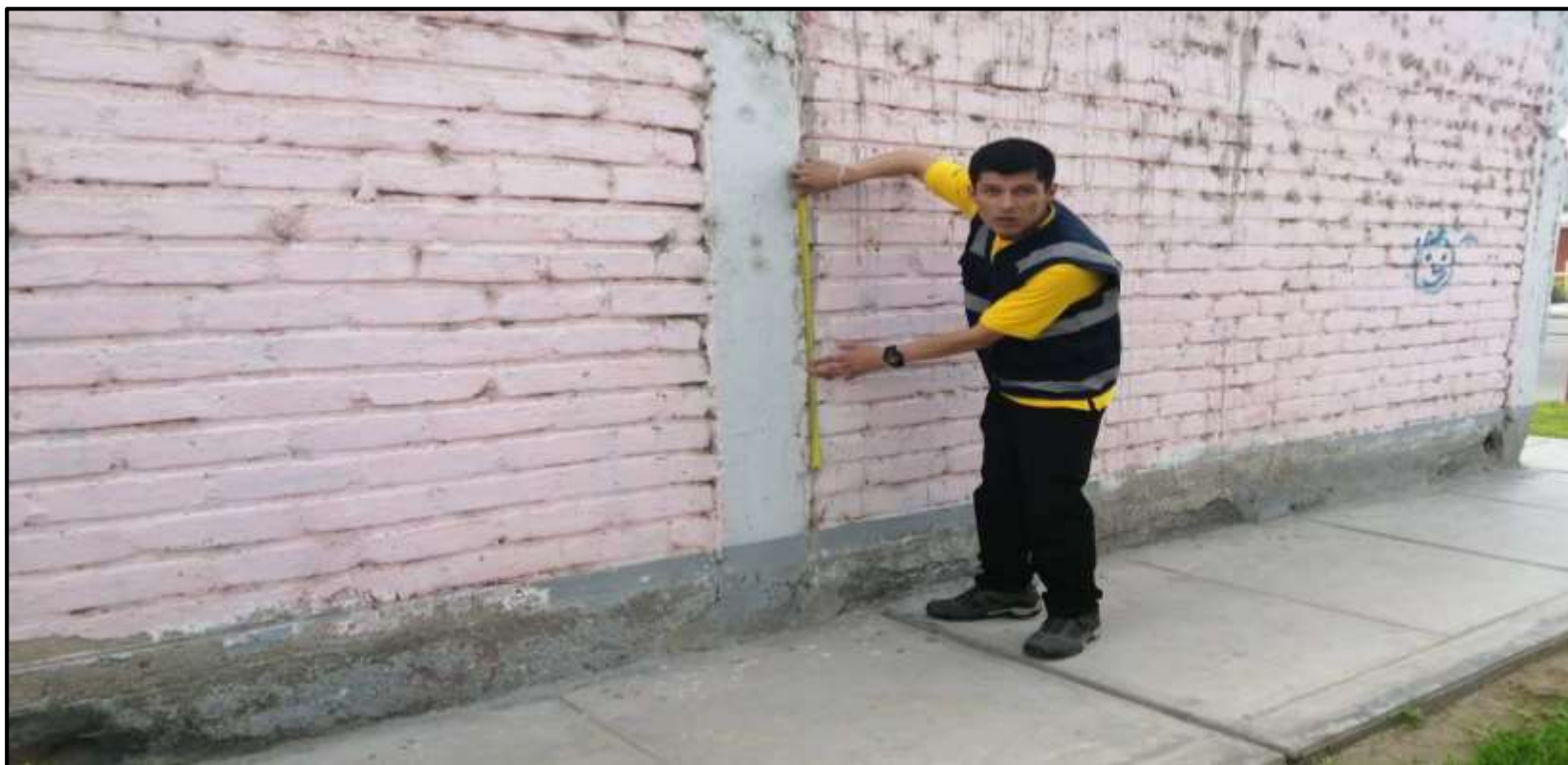
Fotografía 16: Medición de la Patología Grieta en la Columna de la Institución Educativa Inicial 1563 Cristo Rey Amigo de los Niños en la Unidad Muestral 04.
