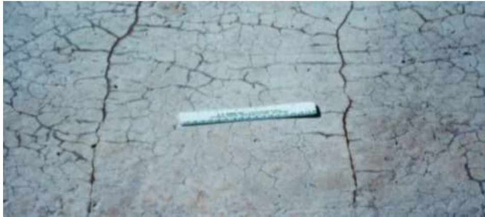
Figura 23: Lesiones Mecánicas – Fisuras.
