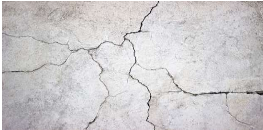
Figura 27: Fisuras en un Muro de Albañilería.
