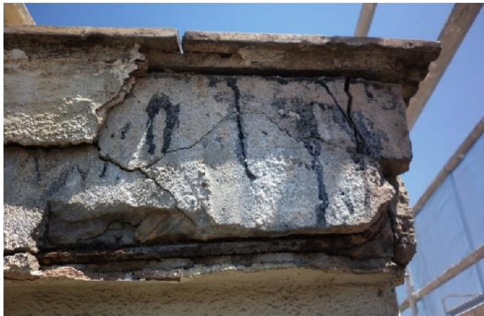
Figura 29. Vista del ataque al concreto por carbonatación.
