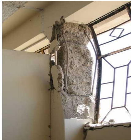
Figura 23. Mal espaciamiento de los estribos, mala calidad de la mezcla del concreto y deficiente supervisión de la construcción.
