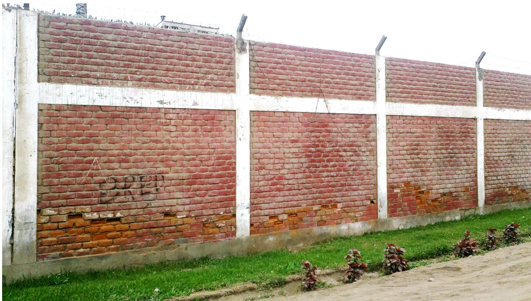
Figura 179. Patologías que afectan la estructura de albañilería confinada del cerco perimétrico.
