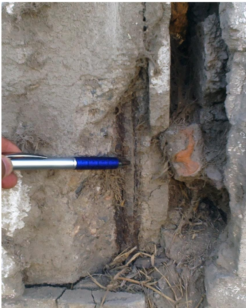
Figura 187. Corrosión del acero de refuerzo en columna.
