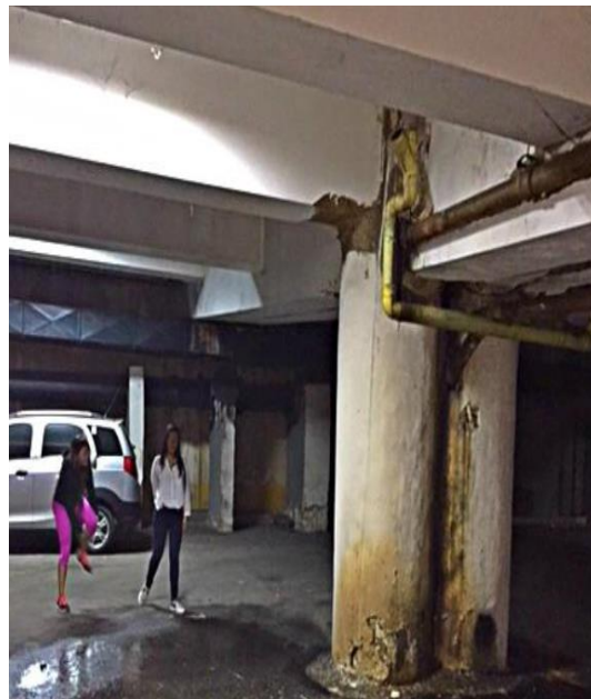
Figura 1. Falla estructural del banco de Venezuela en Maracay Venezuela.
