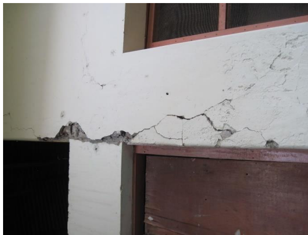
Figura 32. Grieta a tracción por asentamiento.
