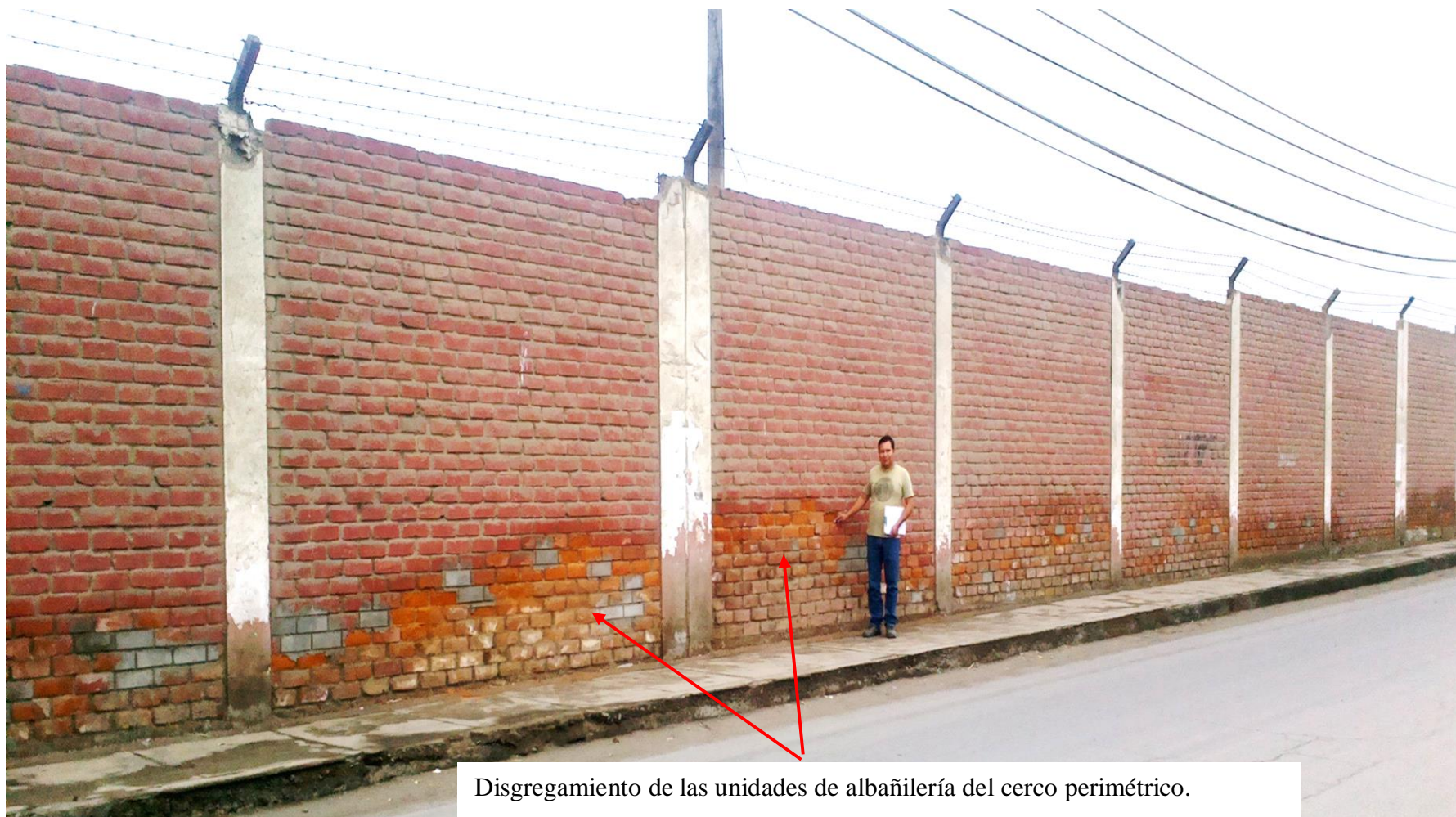
Figura 176. Vista panorámica del cerco perimétrico con lesiones de patologías en la avenida Micaela Bastidas.
