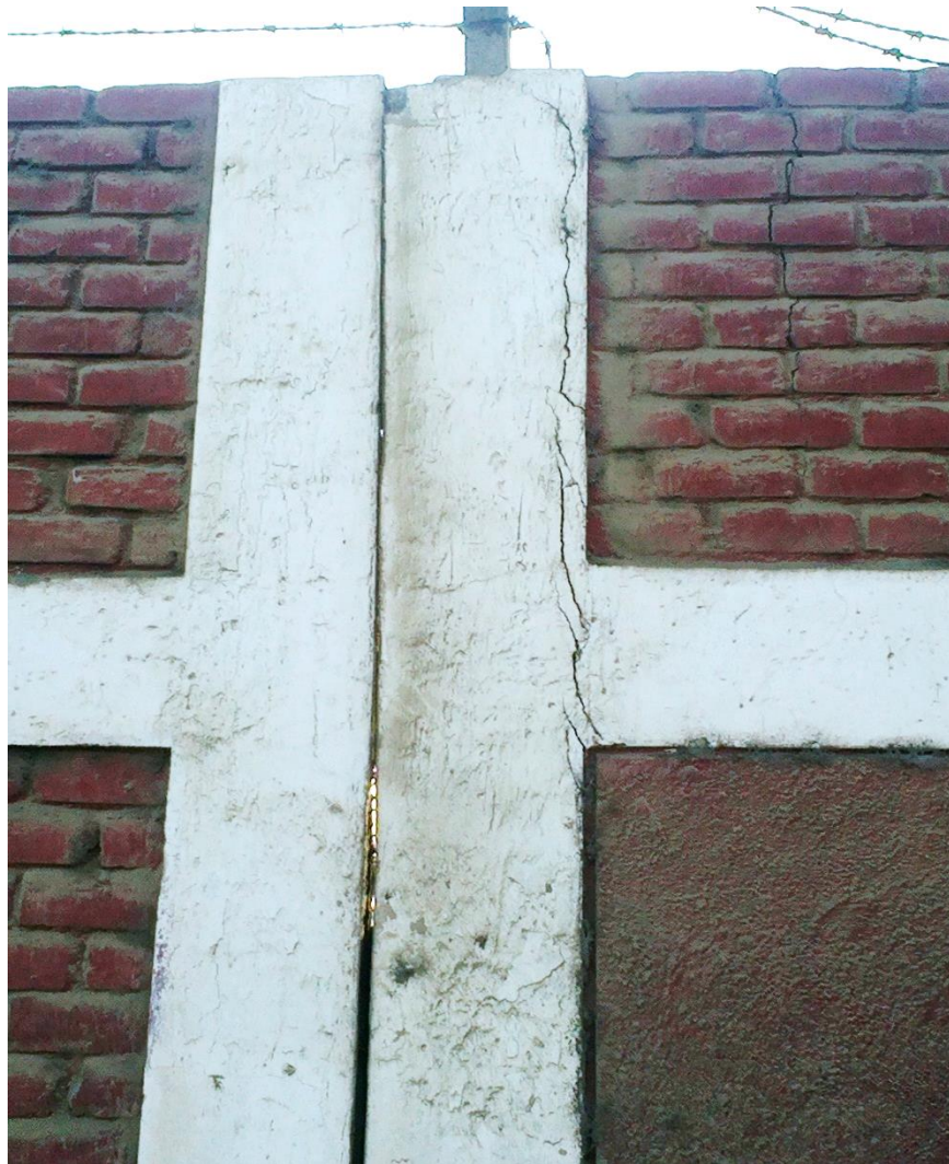
Figura 181. Fisuras en columna y viga.
