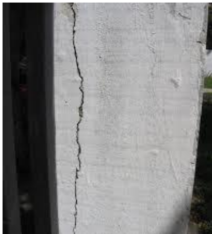
Figura 38. Vista de la formación de grietas longitudinales en columnas de concreto.
