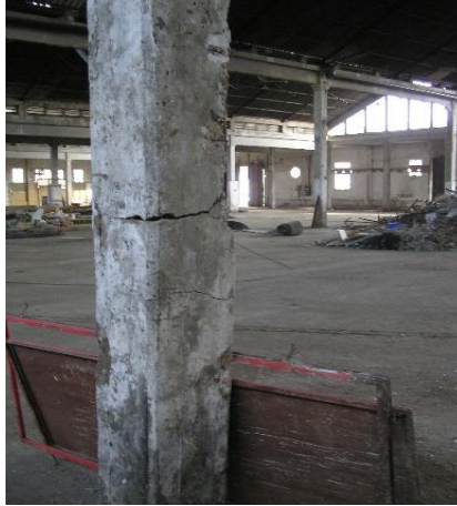
Figura 33. Grieta de una columna por flexión producto del pandeo.
