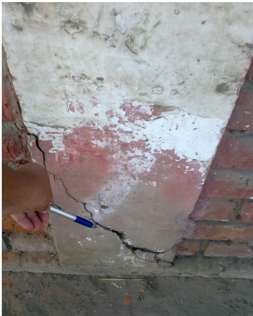
Figura 185. Grietas en columnas.
