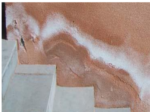
Figura 43. Formación de eflorescencia por la presencia de humedad.
