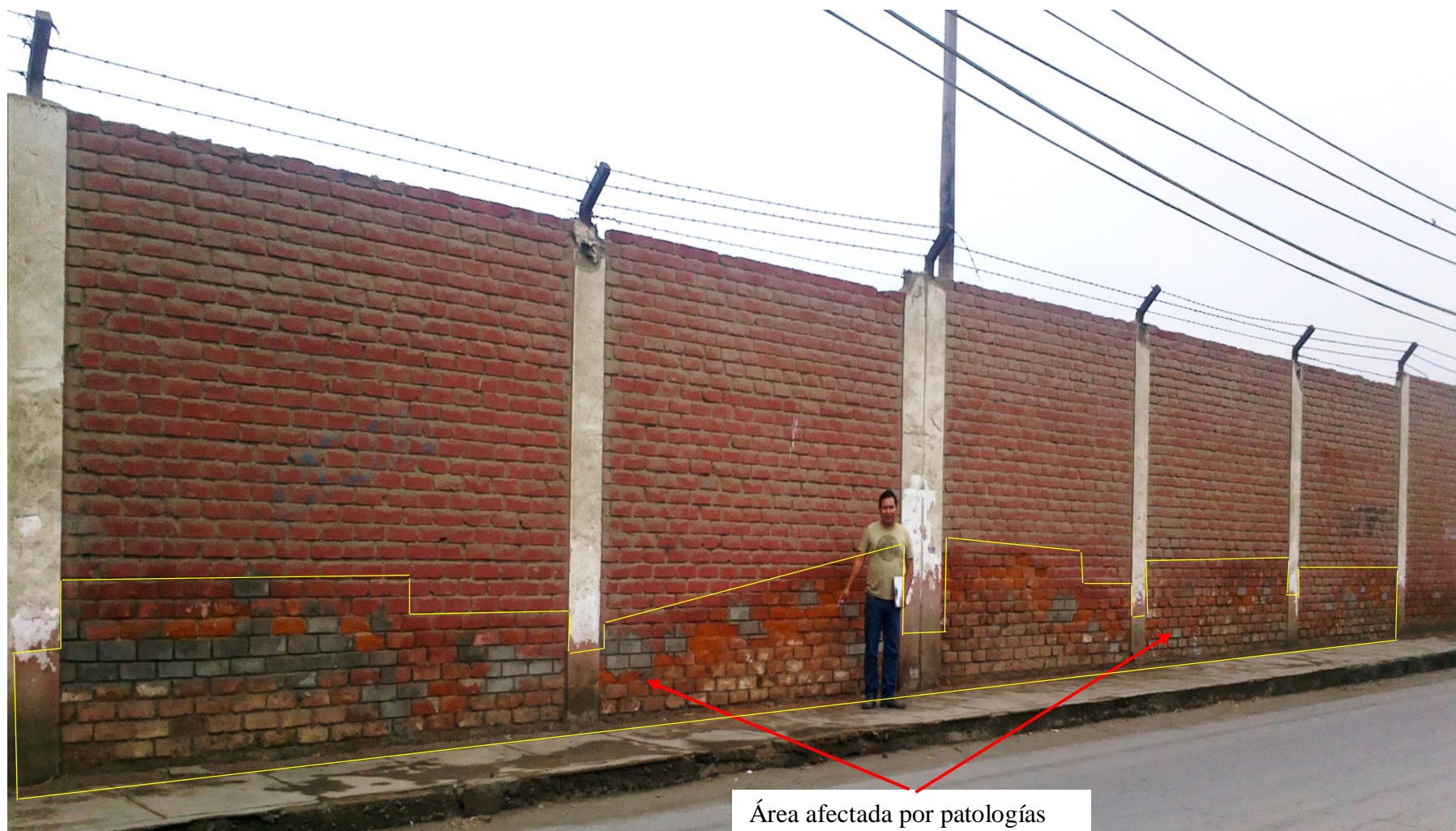
Figura 175. Vista panorámica del cerco perimétrico con lesiones de patologías en la avenida Micaela Bastidas.
