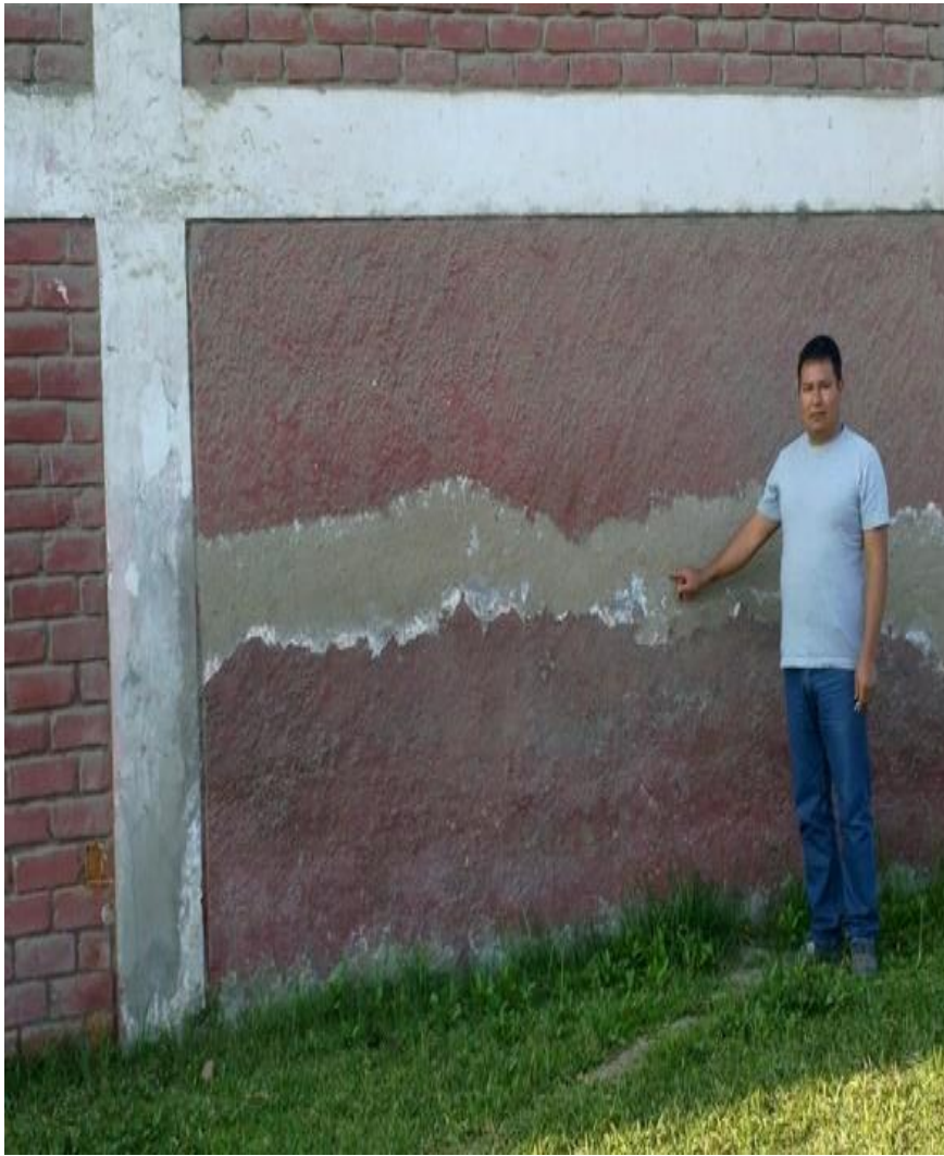
Figura 183. Eflorescencia en muros.
