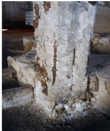
Figura 28. Ataque por ácidos al concreto.
