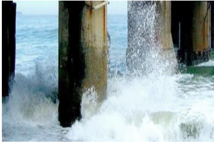
Figura 30. La acción del agua de mar hace que la estructura de concreto erosione por el alto contenido de cloruros y sulfatos.
