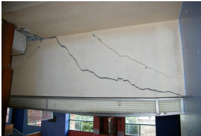
Figura 34. Grieta de una viga por cortante.
