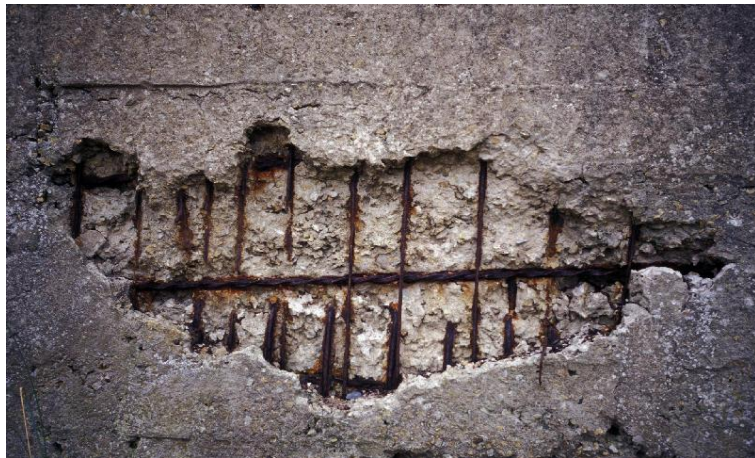
Figura 44. Vista de la oxidación del acero de refuerzo en el concreto.
