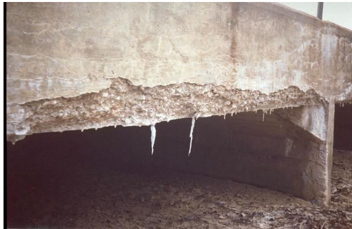
Figura 26. Daño físico por congelamiento y deshielo.
