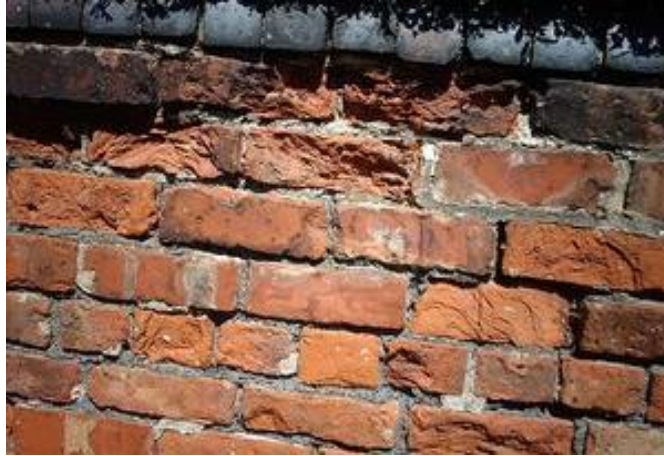
Figura 40. Vista de la erosión del muro por acción eólica del viento en puntos más altos.
