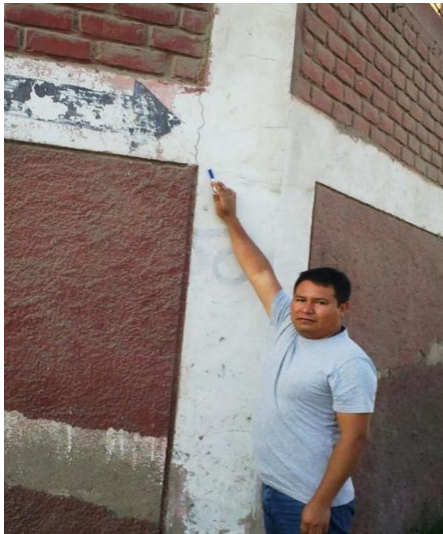
Figura 182. Fisura en viga.
