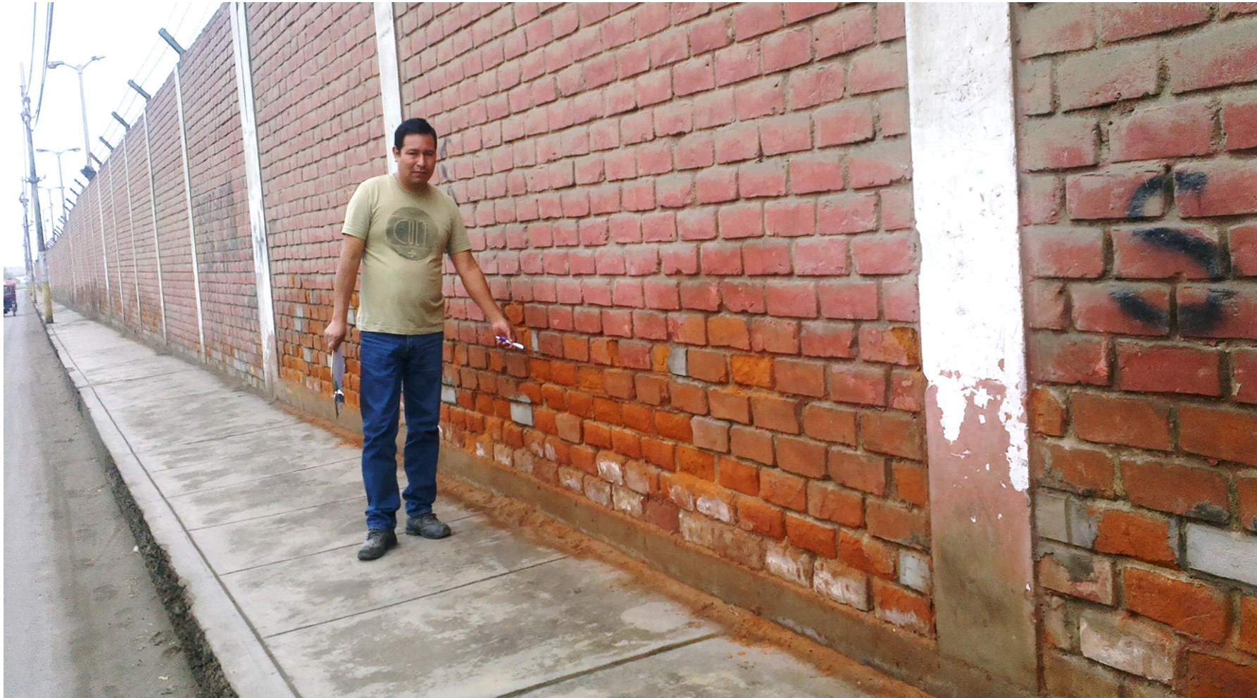
Figura 180. Disgregamiento de las unidades de albañilería en los muros de albañilería confinada del cerco perimétrico.
