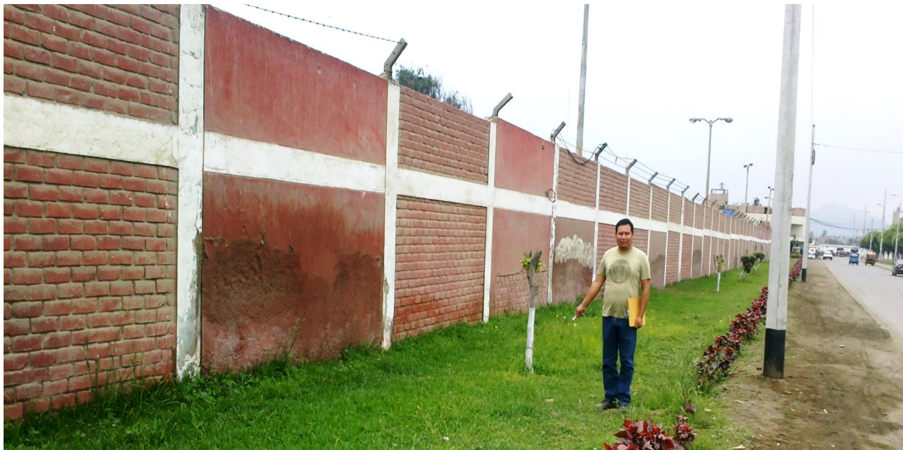
Figura 178. Presencia de humedad que afectan la estructura de albañilería confinada del cerco perimétrico en la avenida Micaela Bastidas.
