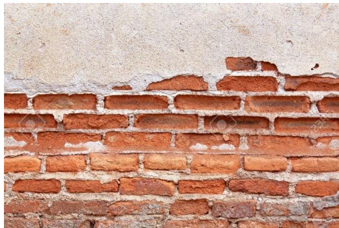
Figura 45. Disgregamiento del muro de albañilería confinada producto de la presencia de humedad.
