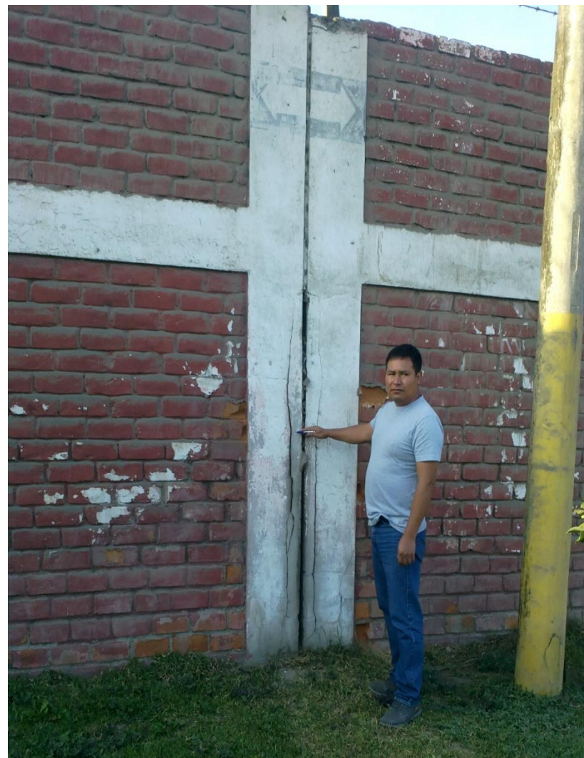
Figura 186. Grietas en columnas.
