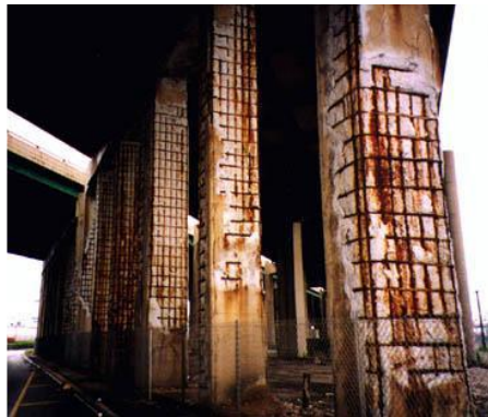
Figura 42. Corrosión del acero de refuerzo en columnas.
