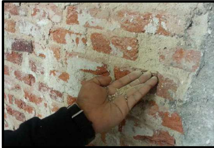
Gráfico 19: desagregación del mortero de asentado. Fuente: S-TRUC (construcción, patología) 19 .
