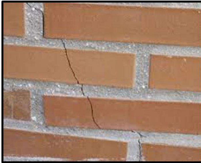
Gráfico 15: fisura en muro de albañilería. Fuente: SOS cubiertas.com 15
