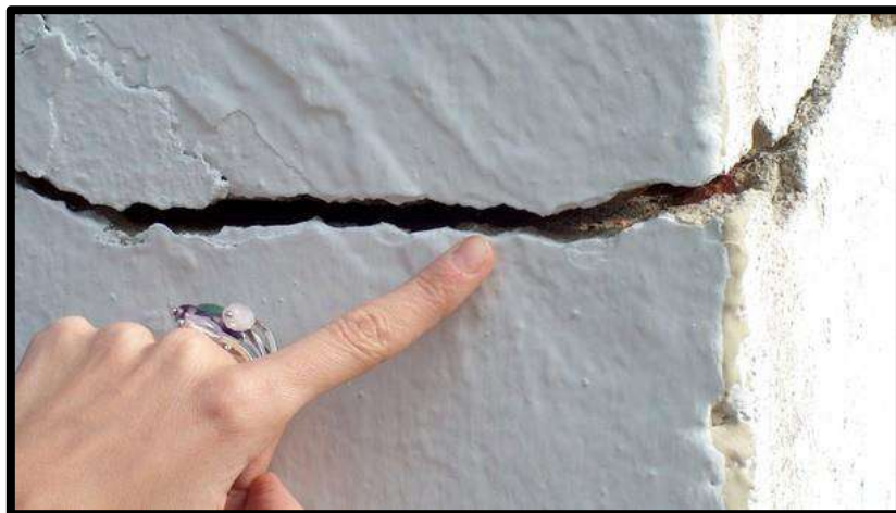
Gráfico 16: grieta en el muro. Fuente: Sika, ACI 16
