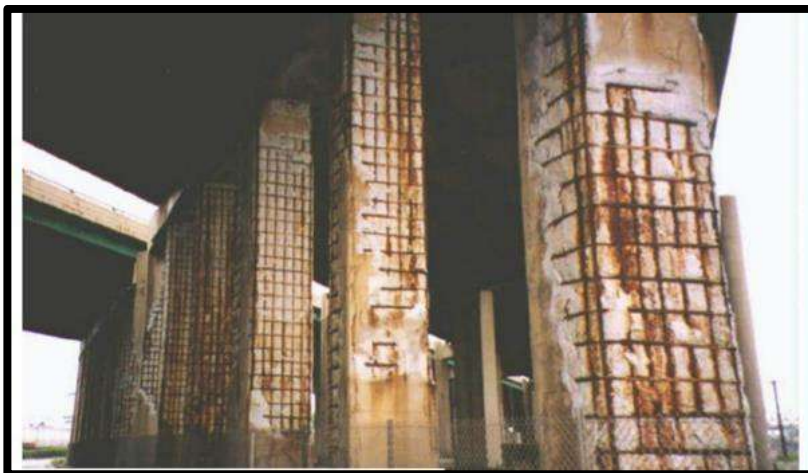
Gráfico 20: corrosión en el acero. Fuente. (Revista aceros Arequipa) 20
