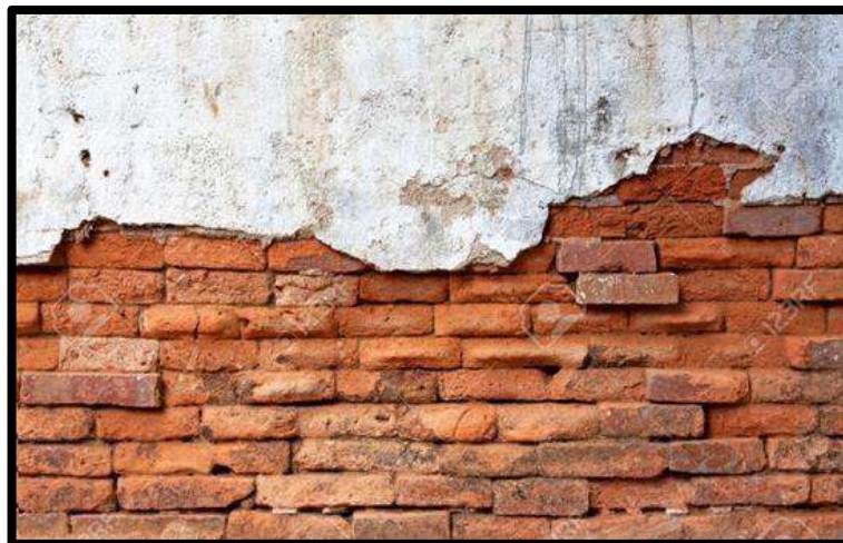
Gráfico 23: erosión en el muro de albañilería. Fuente: (WANHKIRI J) 23
