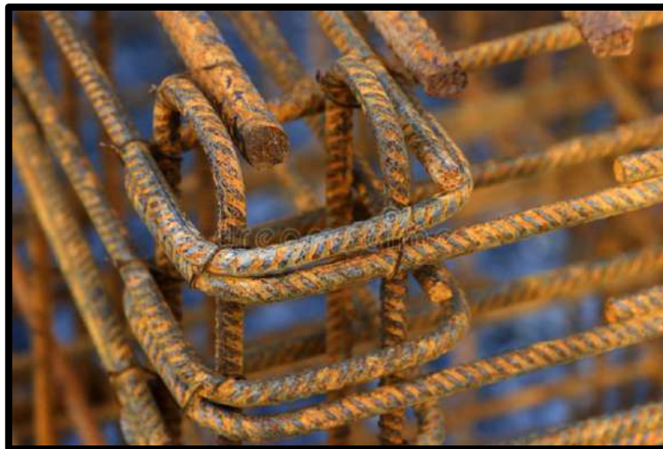
Gráfico 21: Oxidación en el acero de construcción. Fuente: (revista DREANSTINE) 21
