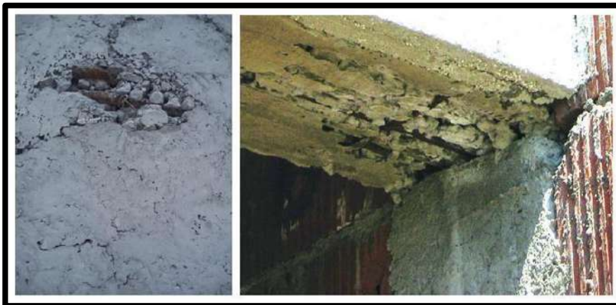
Gráfico 13: Patologías en el concreto. fuente (blog 360 en concreto) 13
