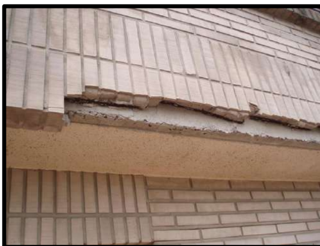
Gráfico 17: desprendimiento en la fachada. Fuente: (ARQUITELAN 2018) 17
