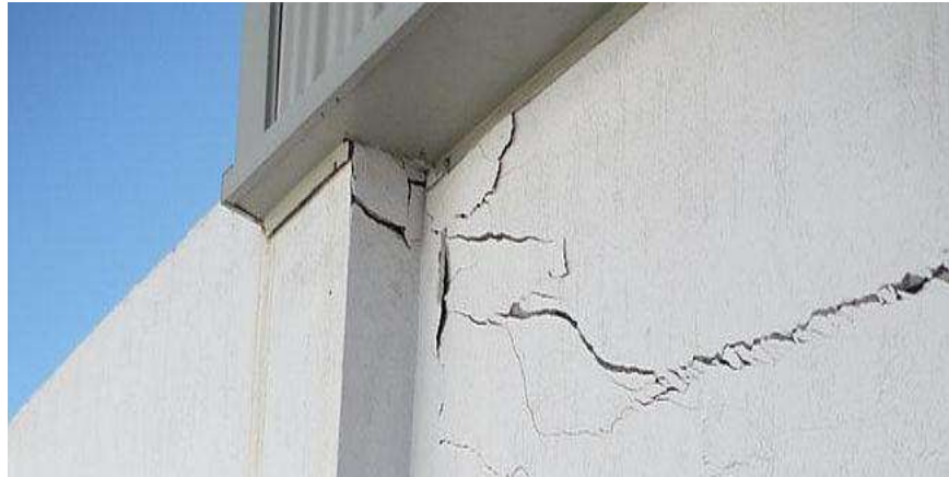
Figura 20: Grietas en un Muro.
