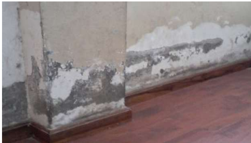
Figura 23: Eflorescencia en Muro y Columna.
