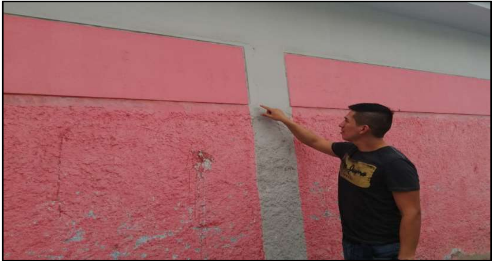
Imagen 6: Verificación de la Patología Fisura presente en la Columna de la Unidad Muestral 08 de la Institución Educativa N° 88016 José Gálvez Egúsquiza.
