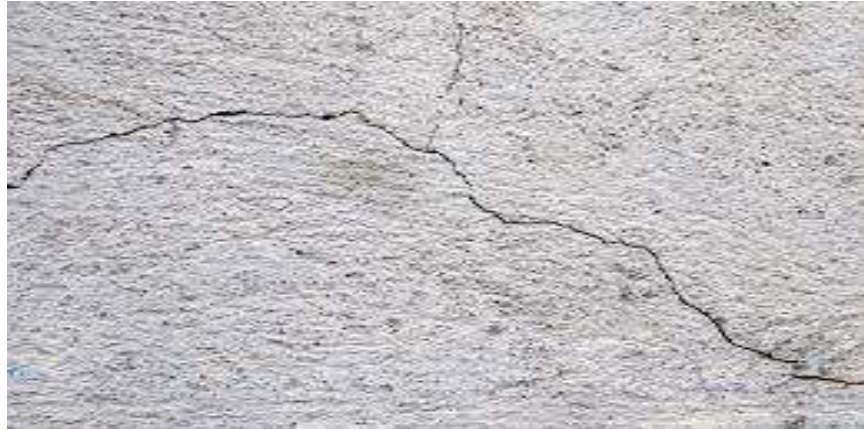
Figura 21: Fisuras en un Muro.
