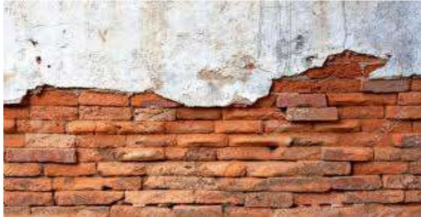
Figura 19: Erosión del ladrillo.
