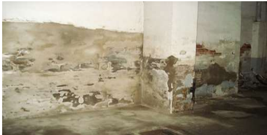
Figura 17: Patologías del Concreto.
