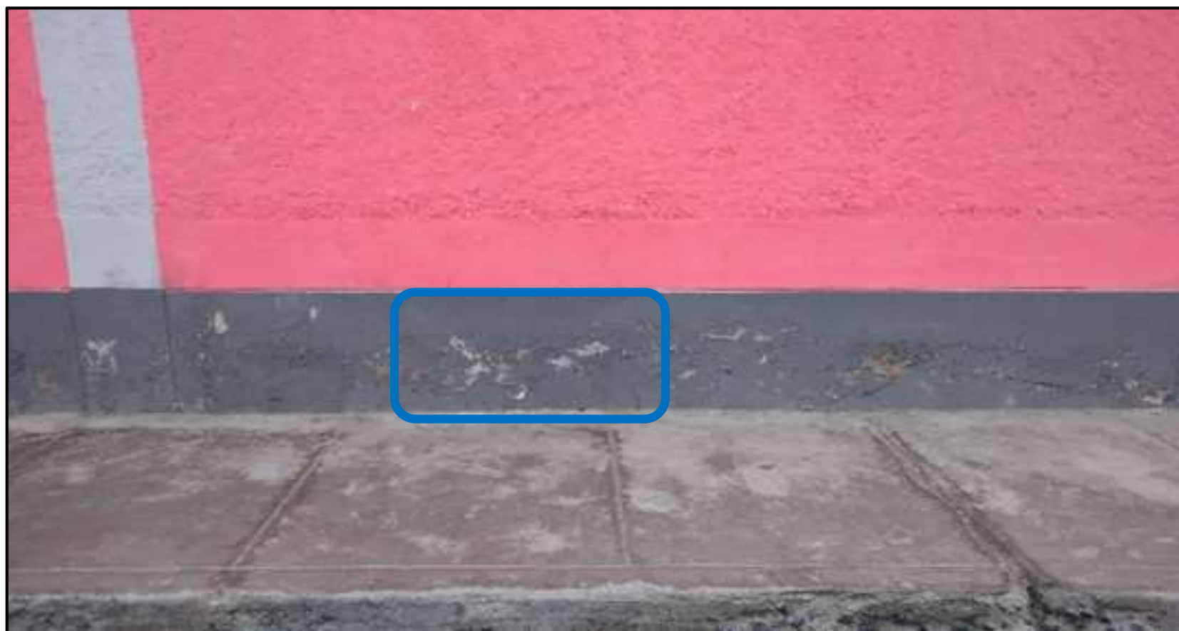
Imagen 9: Patología Eflorescencia presente en el Sobrecimiento de la Unidad Muestral 06 de la Institución Educativa N° 88016 José Gálvez Egúsquiza.
