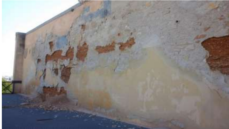
Figura 22: Desprendimiento del revestimiento del Muro.
