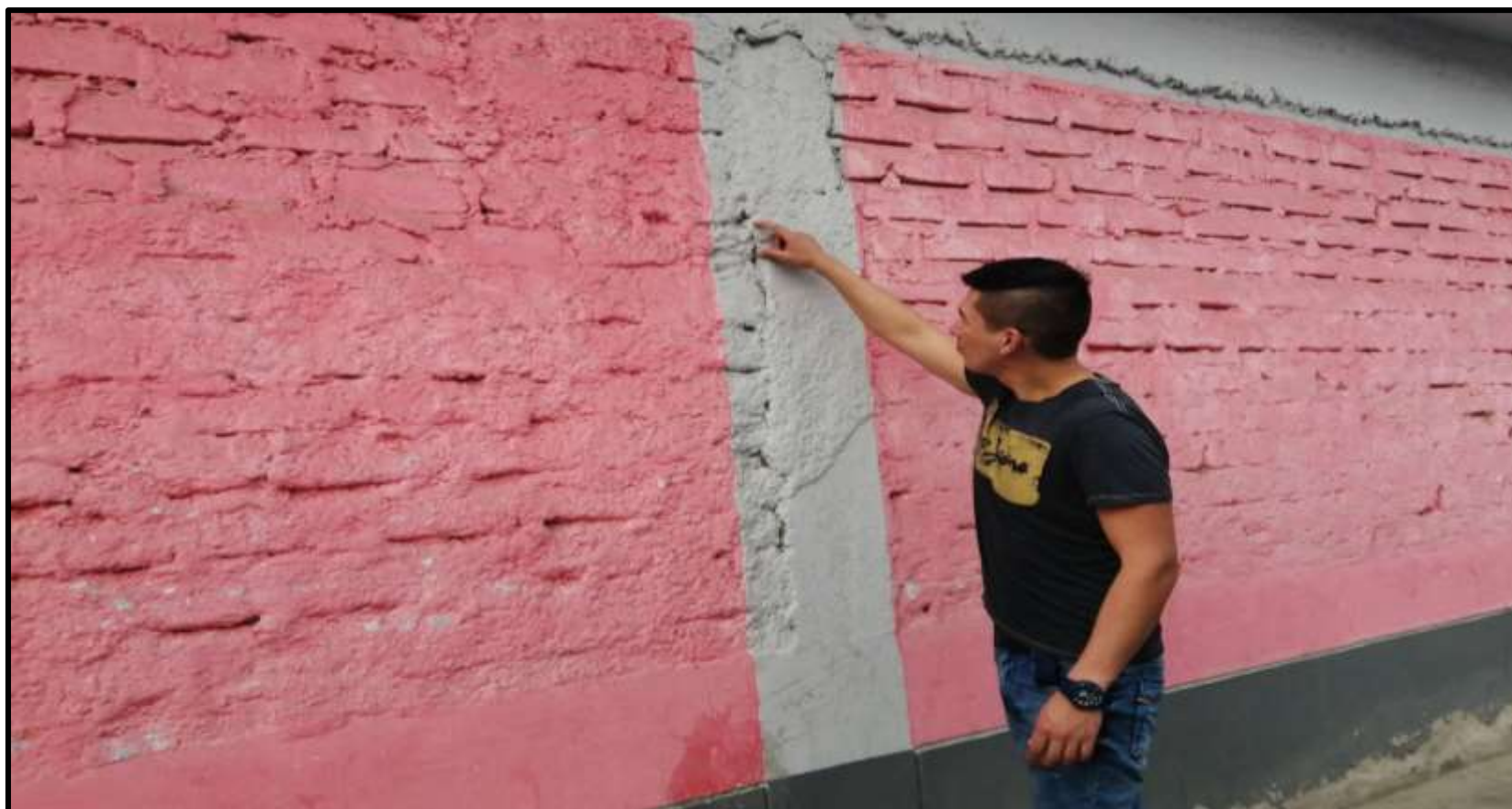
Imagen 7: Verificación de la Patología Grieta presente en la Columna de la Unidad Muestral 05 de la Institución Educativa N° 88016 José Gálvez Egúsquiza.
