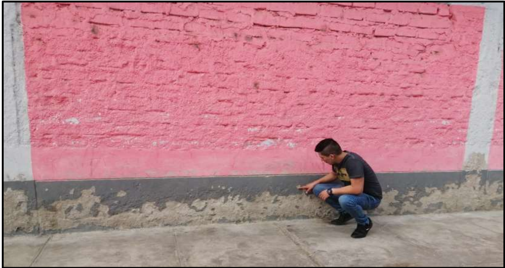
Imagen 4: Verificación de la Patología Erosión presente en el Sobrecimiento de la Unidad Muestral 03 de la Institución Educativa N° 88016 José Gálvez Egúsquiza.
