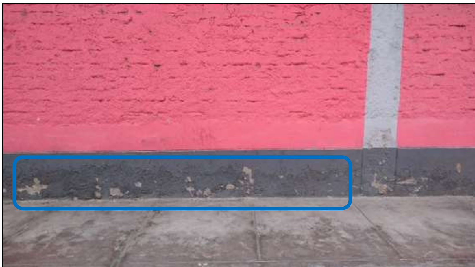
Imagen 8: Patología Erosión presente en el Sobrecimiento de la Unidad Muestral 03 de la Institución Educativa N° 88016 José Gálvez Egúsquiza.
