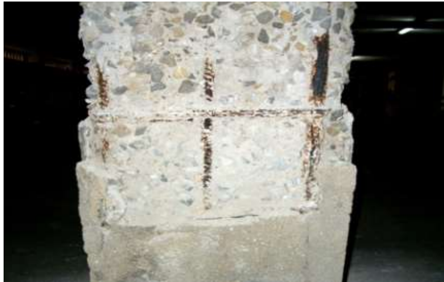
Figura 24: Corrosión del acero de una Columna.
