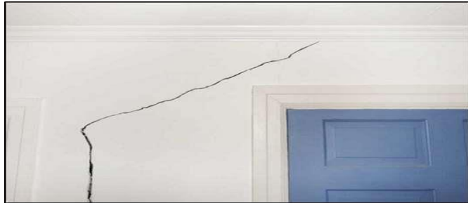
Imagen 12: Grieta. Fuente: Minar N. (2005).
