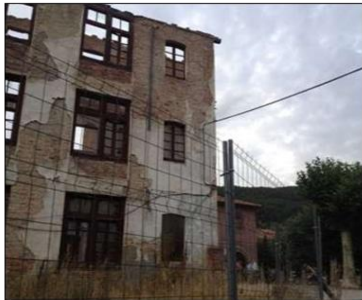
Imagen 14: Desprendimiento en fachadas. Fuente: Gancedo. (2012).
