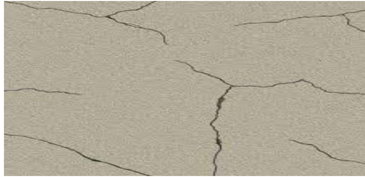
Imagen 11: Fisura. Fuente: Fiol F. (2014).
