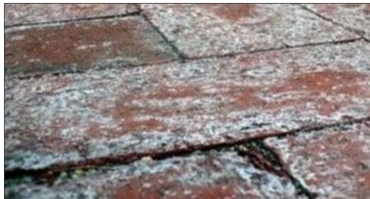
Imagen 16: Eflorescencia. Fuente: clarín.arqui.
