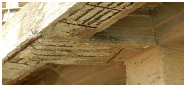
Imagen 15: Corrosión. Fuente: RB Conspro. (2013)
