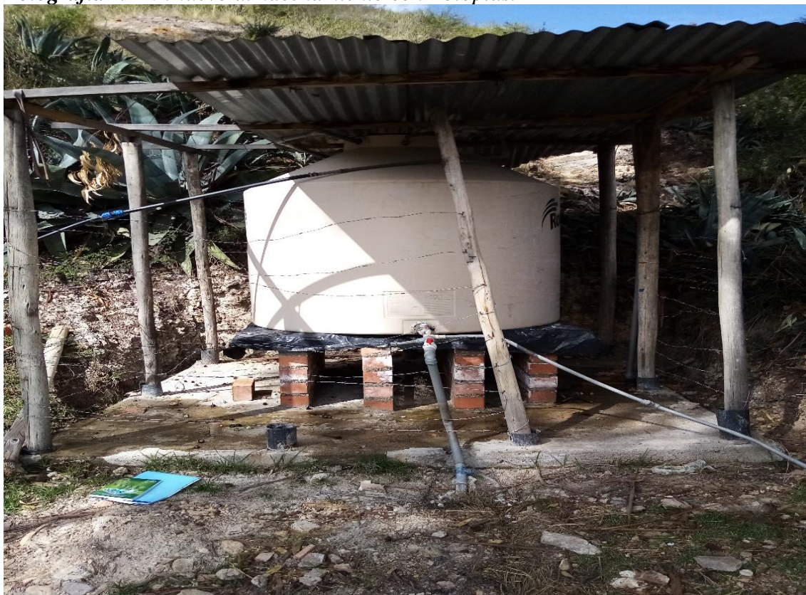
Fotografía N° 29. Nuevo almacenamiento con Rotoplas.
