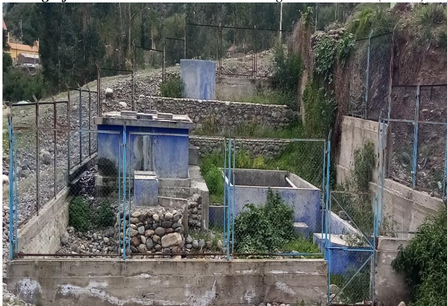
Fotografía N° 21. Planta de tratamiento aguas residuales (PTAR)
