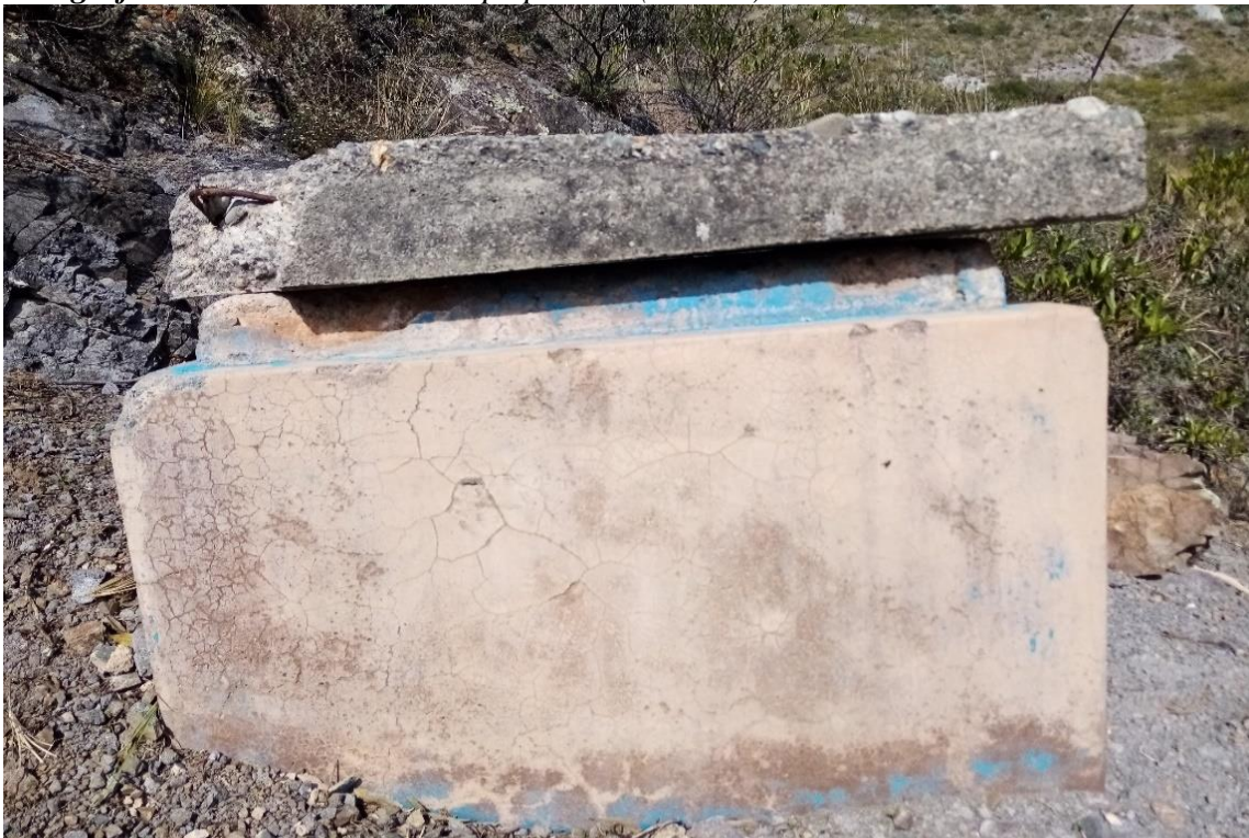
Fotografía N° 26. Camara de rompe presión (CRP06)
