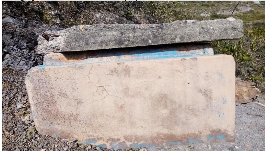
Fotografía N° 6. Cámara de rompe presión ( CRP-T6)
