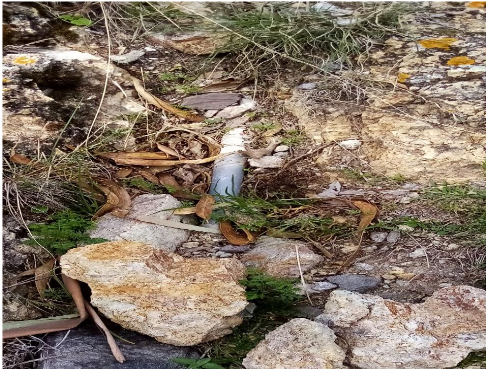
Fotografía N° 4. Tubería expuesta a la intemperie
