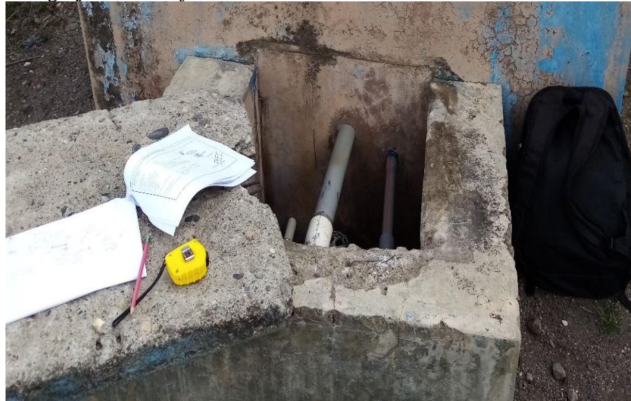
Fotografía N° 9. Caja de válvulas
