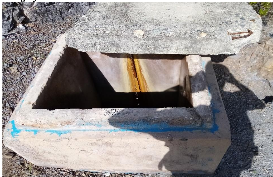
Fotografía N° 7. Vista interior de la CRP-T6
