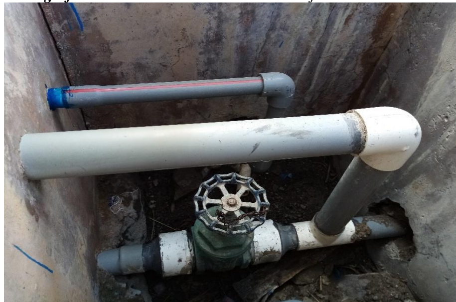
Fotografía N° 10. Valvulas instaladas en la caja de válvulas
