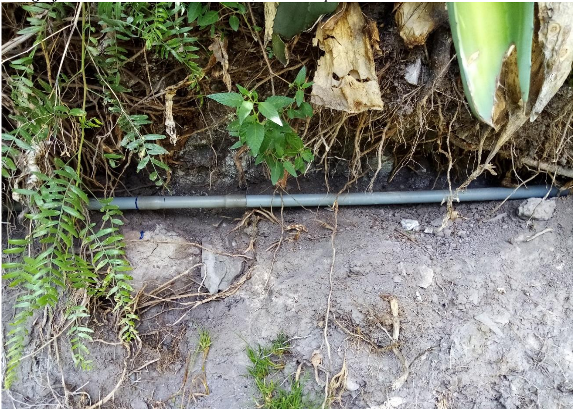
Fotografía N° 32. Línea de conducción, tubería expuesta
