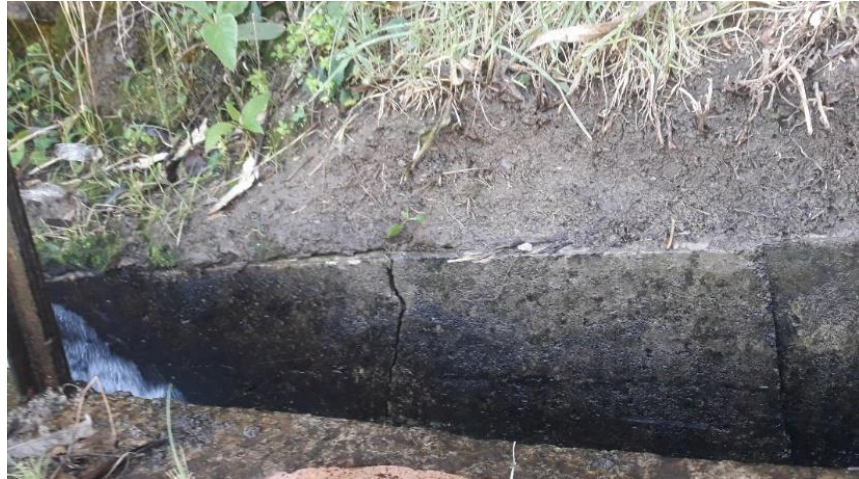
Fotografía N°3: Canal de riego con presencia de grietas
