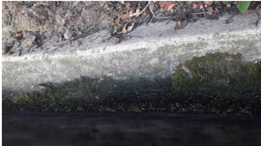
Fotografía N°4: Canal de riego con presencia de eflorescencia
