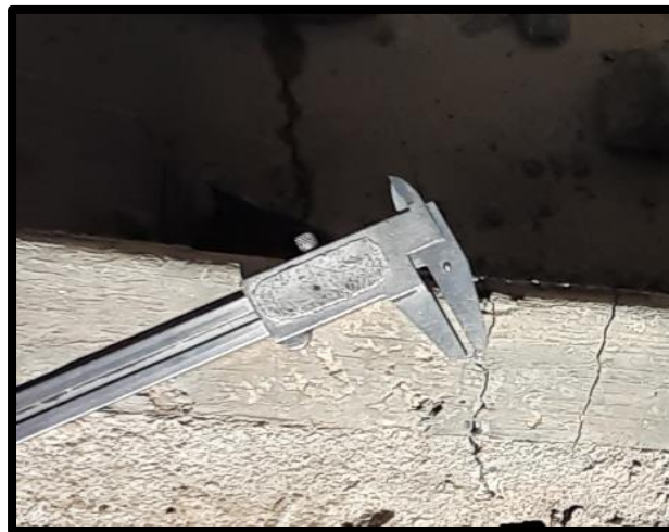
Imagen 5 Fisuras Fuente: Elaboración propia
