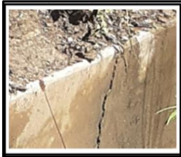
Imagen 4 Grietas Fuente: Elaboración propia
