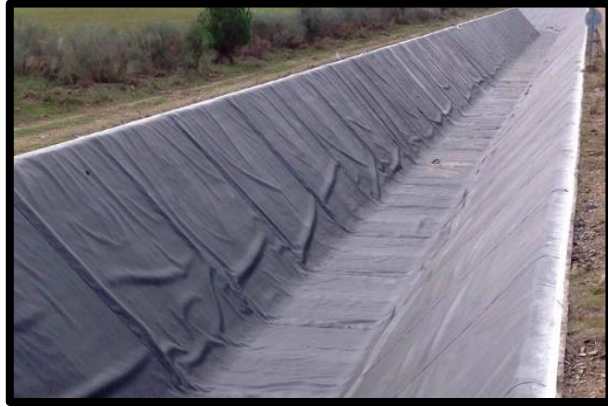
Fotografía 3: Canal de PVC
