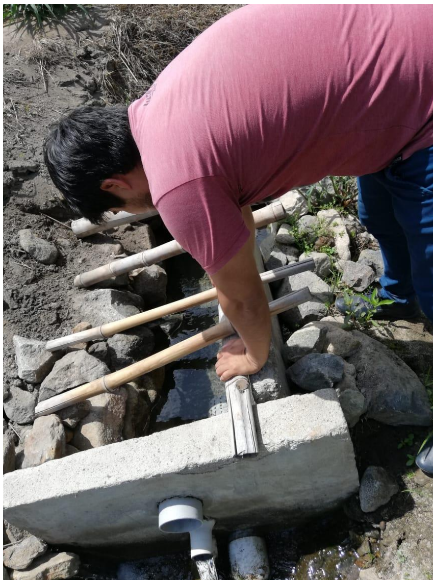
Foto 04. Interior de la captación Quisquis: construcción antitécnica, no existe caseta de válvulas ni canastilla.
