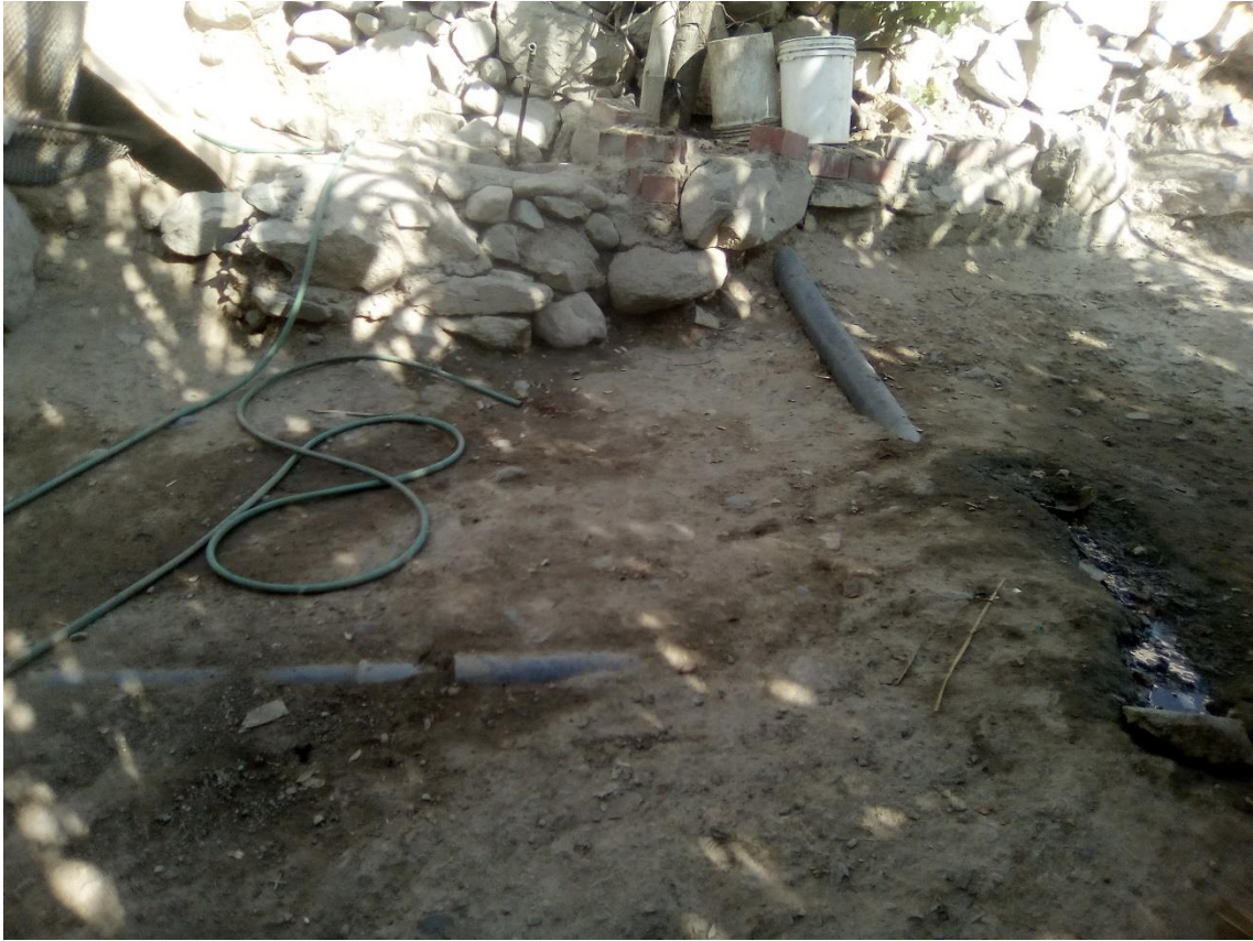
Foto 08. Línea de Conducción expuesta y atravesando una vivienda del centro poblado Muña Alta.
