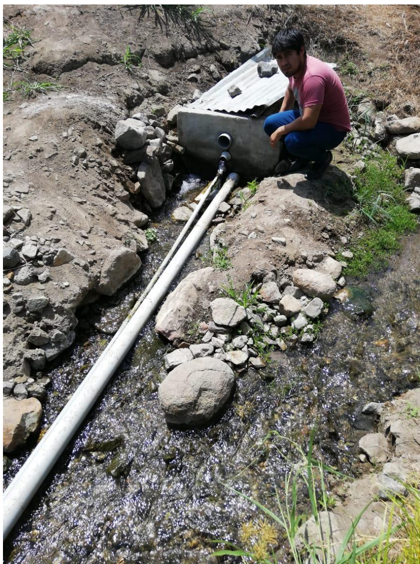
Foto 03. Captación de Quisquis, véase solo una estructura precaria.
