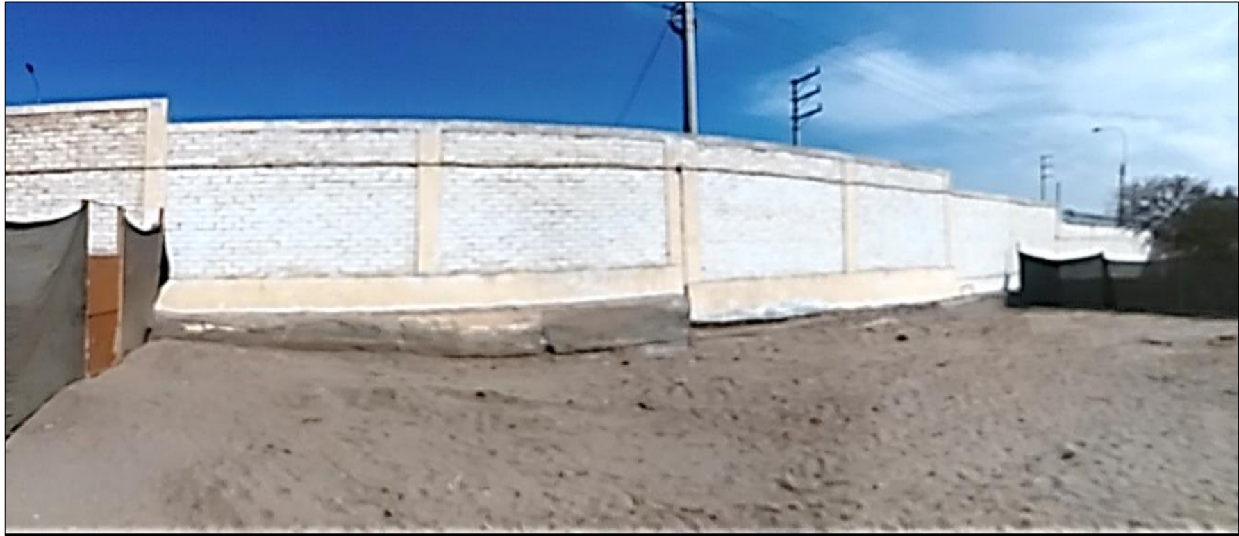
Imagen 9: Muro afectado por erosión en la unidad muestral 14 con un porcentaje de área afectada de 28.26% y un nivel de severidad leve.
