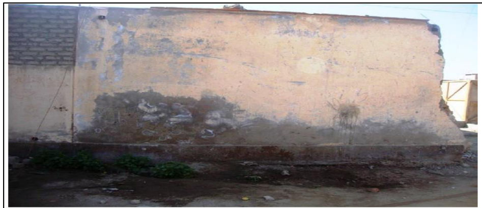
Figura 13. Eflorescencia en el muro, sobrecimiento y columna.
