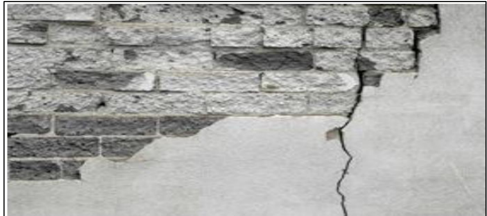
Figura 10. Patología del concreto grieta.
