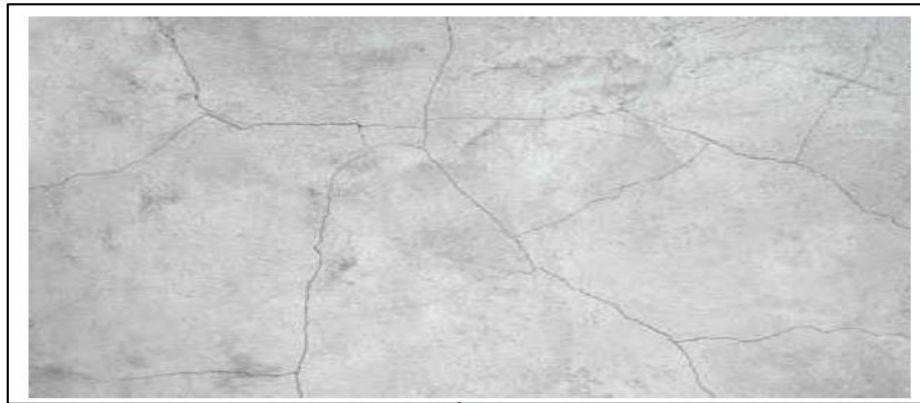
Figura 11. Patología del concreto fisura.
