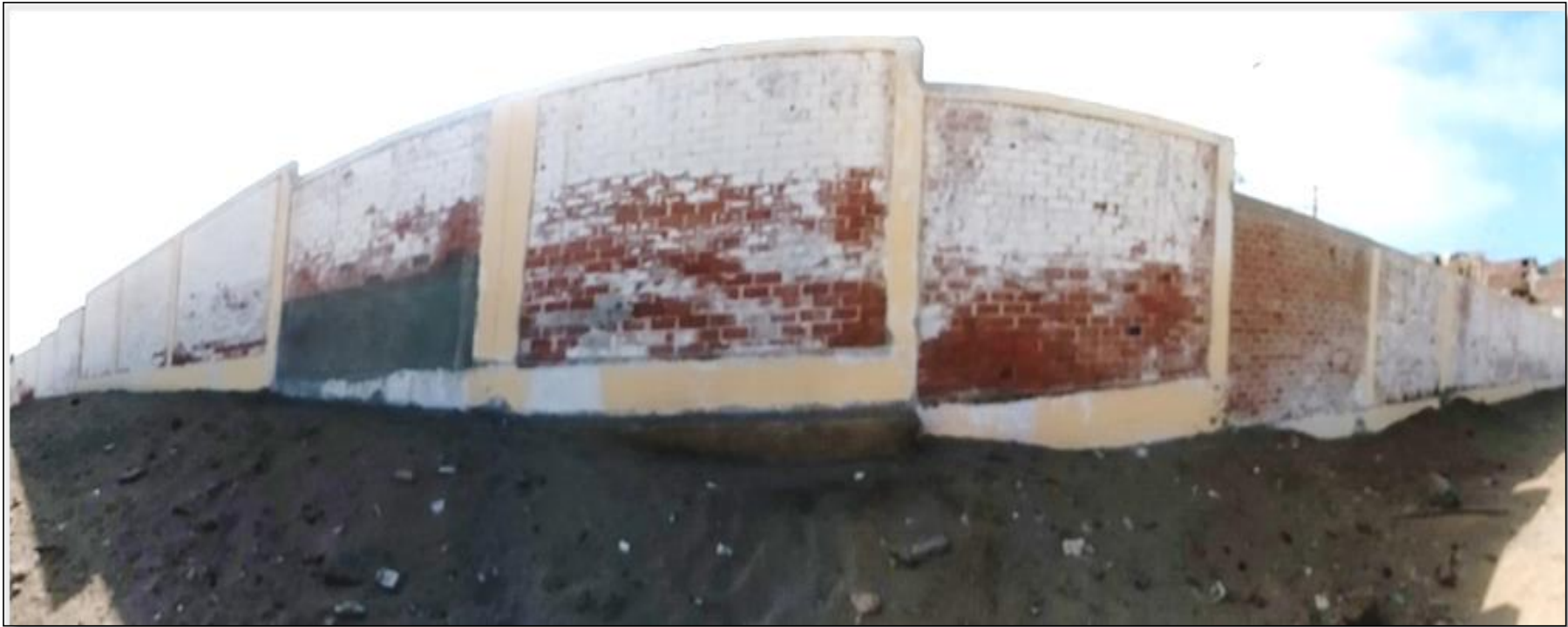
Imagen 7: Muro afectado por erosión en la unidad muestral 03 con un porcentaje de área afectada de 18.72% y un nivel de severidad
