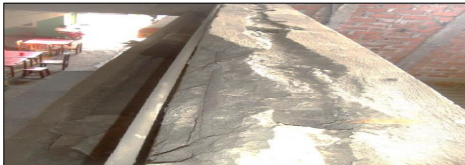
Figura 12. Patología del concreto desprendimiento.
