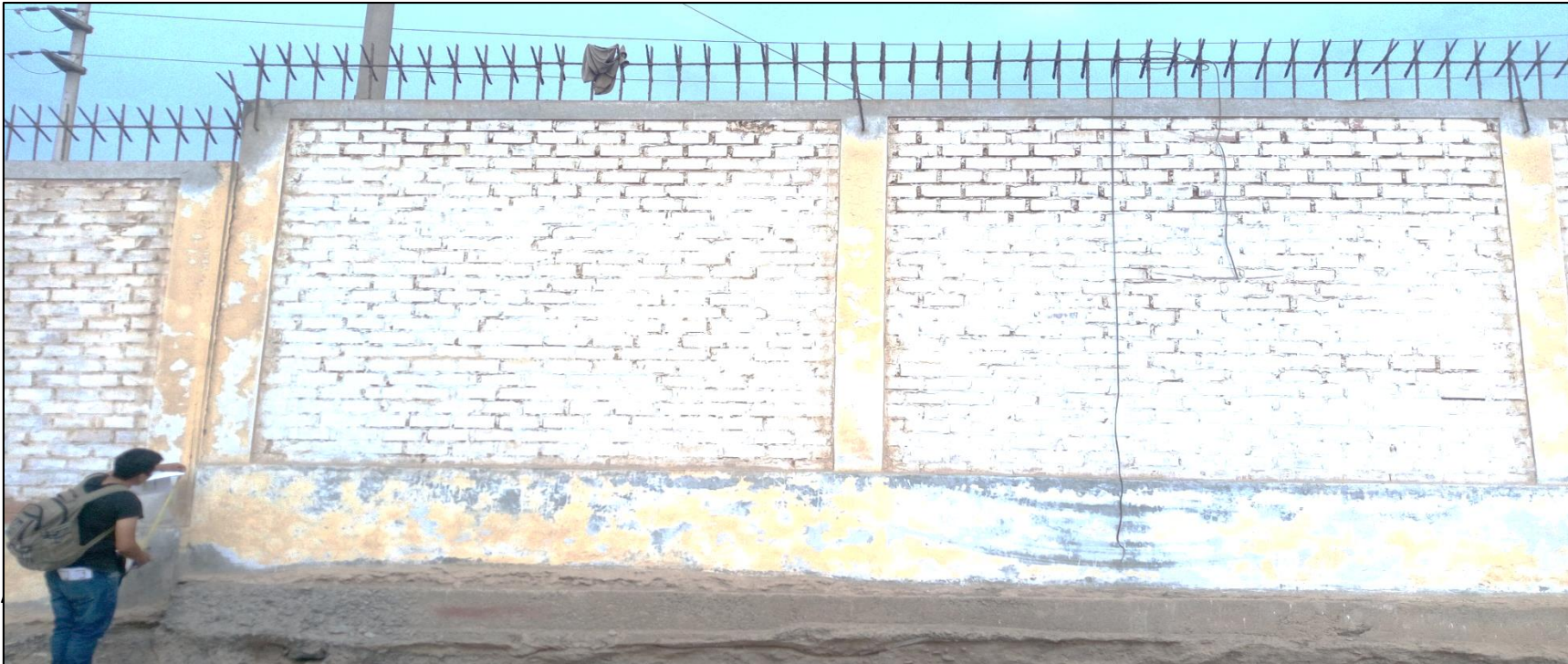
Imagen 5: vista de la parte interna del cerco perimétrico existencia de patologías en el cerco de la de la institución educativa estatal San José de Manzanares, ubicado en el distrito de Huacho, provincia de Huaura, departamento de Lima.
