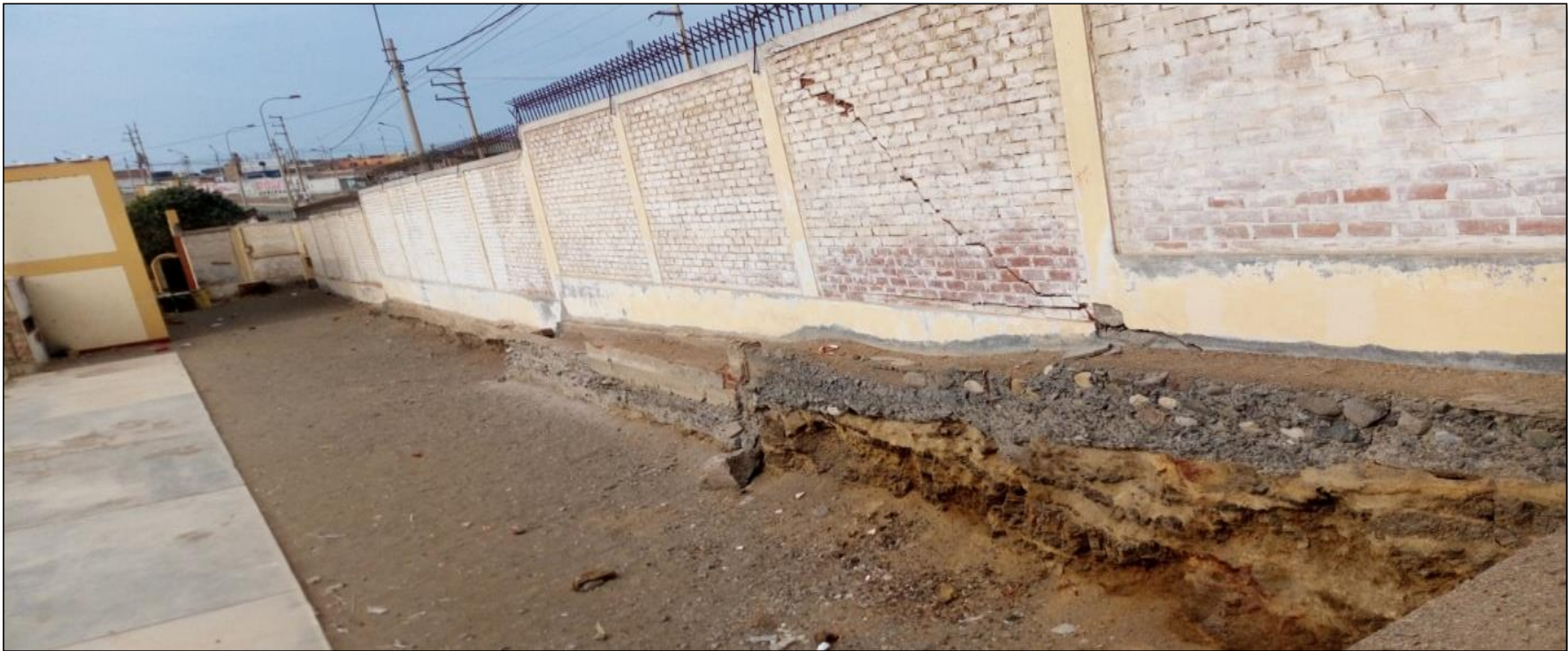
Imagen 6: Muro afectado por grieta en la unidad muestral 12 con un porcentaje de área afectada de 17.53% y un nivel de severidad leve.
