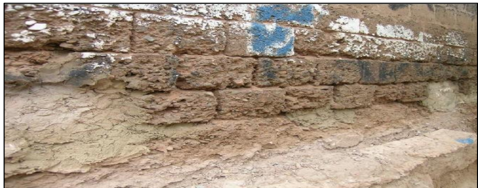
Figura 08. Patología de la concreta erosión.
