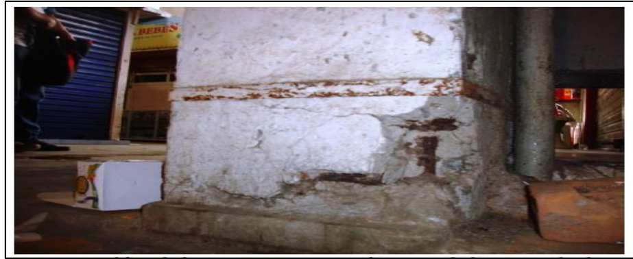
Figura 14. Corrosión del acero en una columna.
