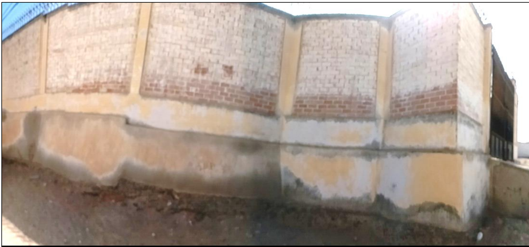
Imagen 8: Muro afectado por erosión en la unidad muestral 14 con un porcentaje de área afectada de 28.26% y un nivel de severidad leve.
