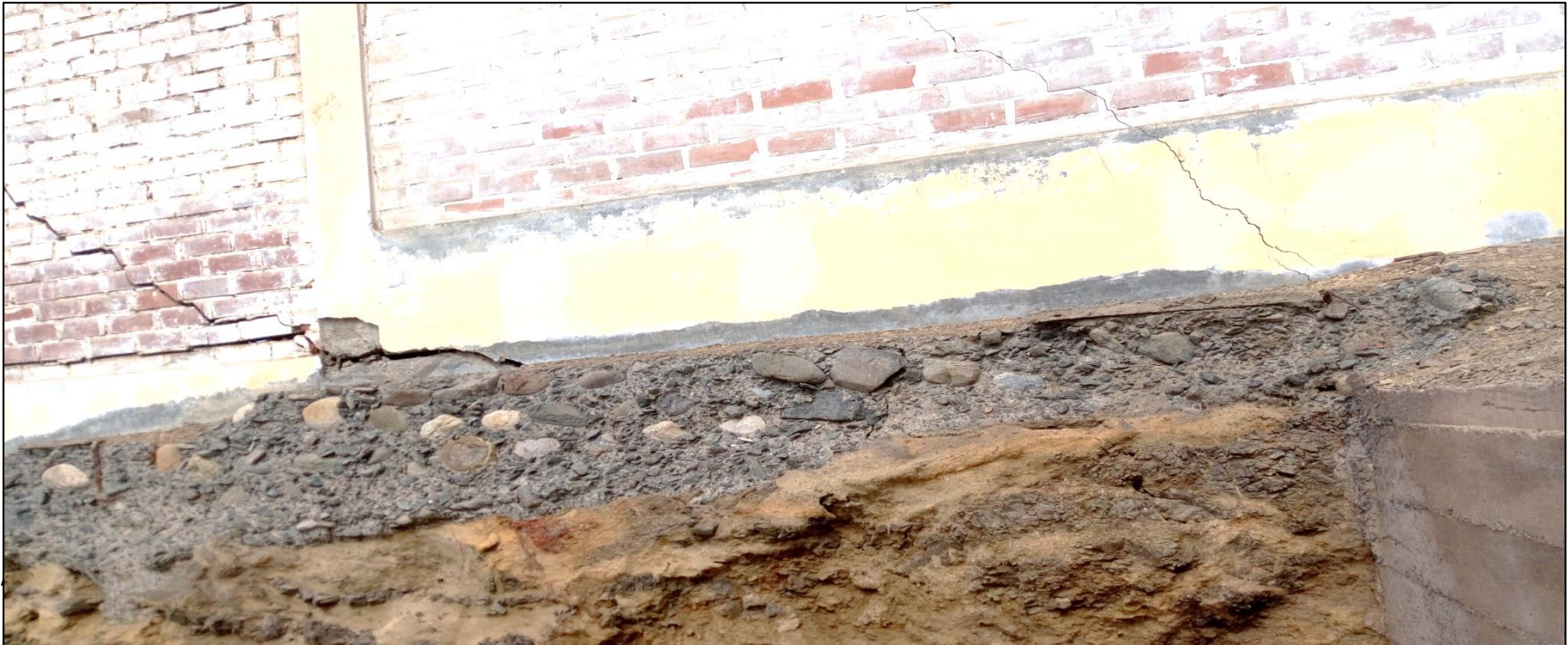
Imagen 4: vista de la parte interna del cerco perimétrico calle panamericana norte ,existencia de patologías en el cerco de la de la institución educativa estatal San José de Manzanares, ubicado en el distrito de Huacho, provincia de Huaura, departamento de Lima.
