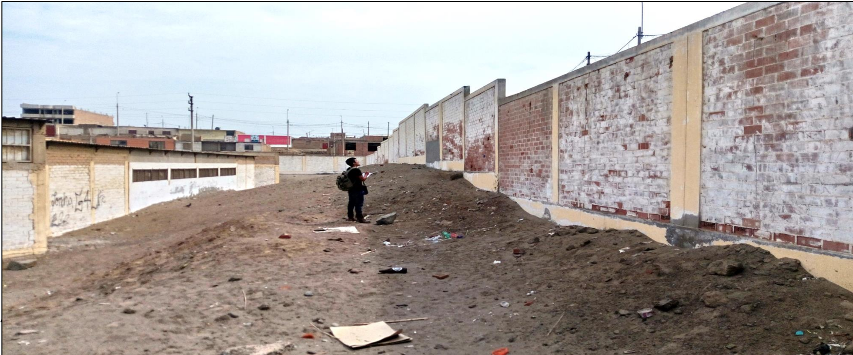
Imagen 3: vista de la parte interna del cerco perimétrico calle 4 (0602) identificando la existencia de patologías en el cerco de la de la institución educativa estatal San José de Manzanares, ubicado en el distrito de Huacho, provincia de Huaura, departamento de Lima.
