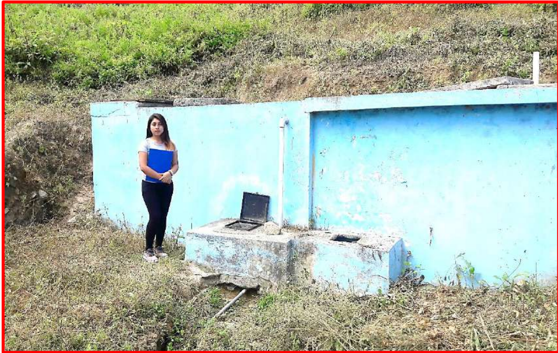
Imagen 8. Reservorio rectangular de 10 m 3 del caserío Miraflores.
