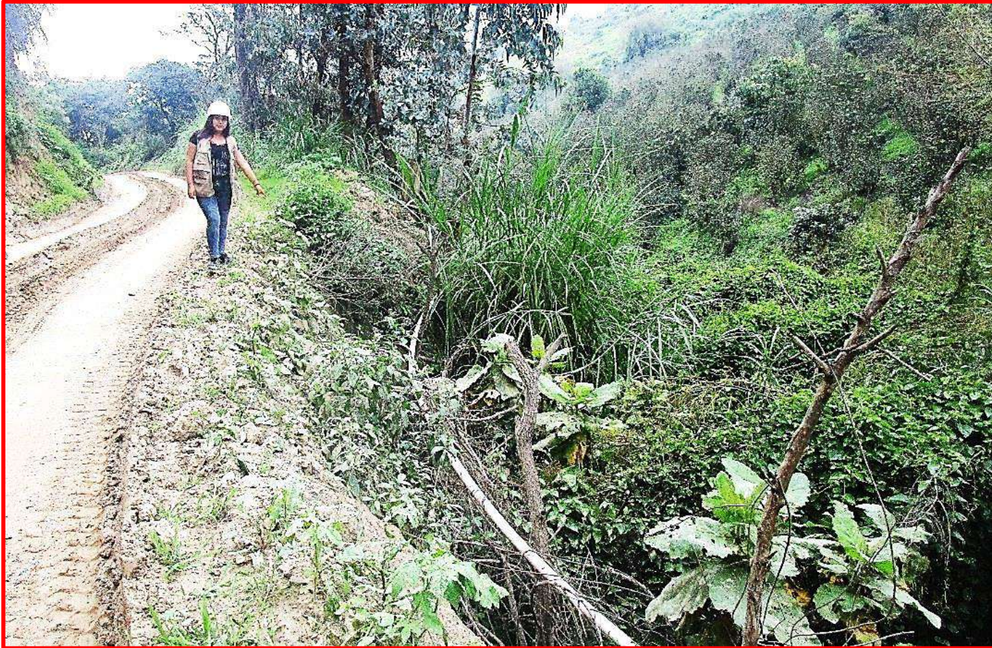
Imagen 2. Línea de conducción.
