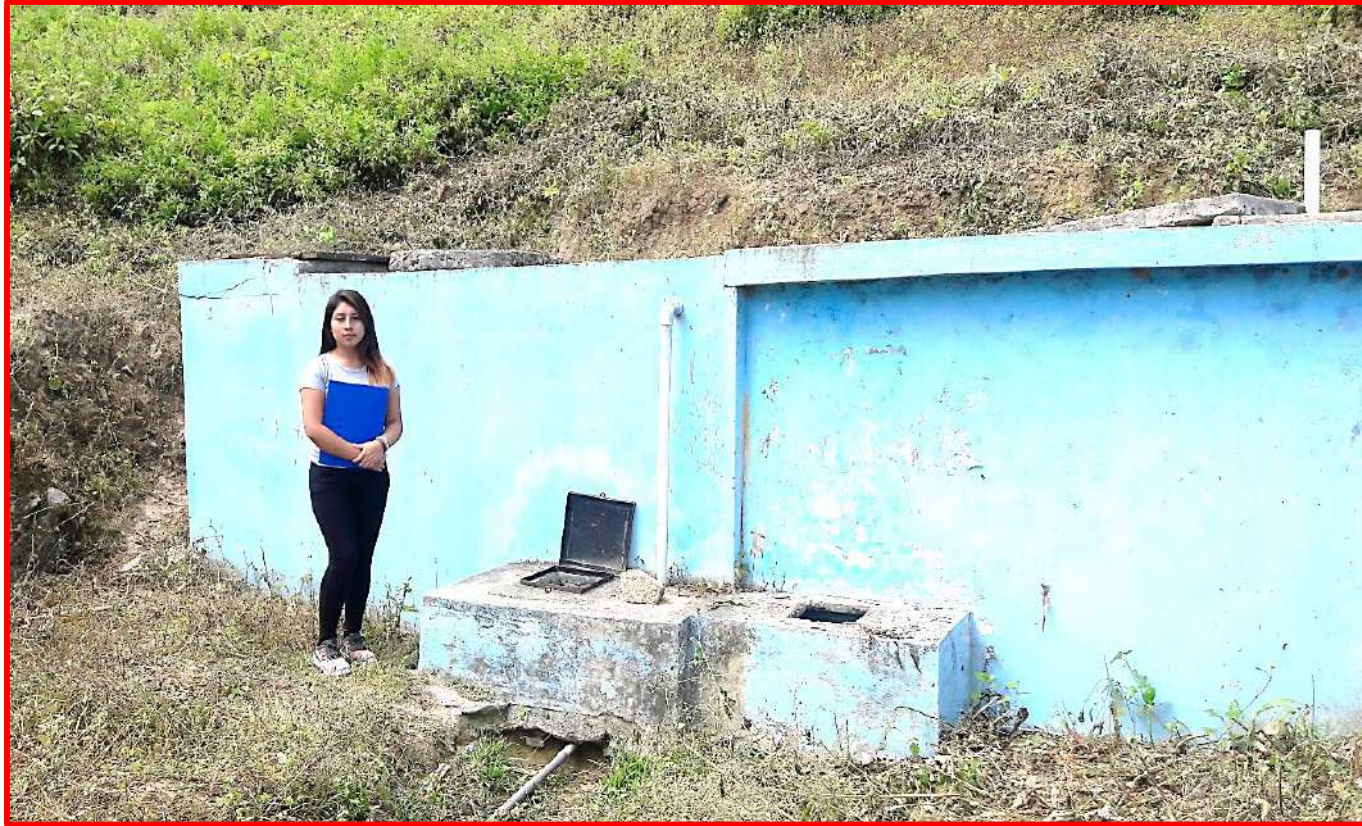
Imagen 3. Reservorio rectangular apoyado del caserío Miraflores.
