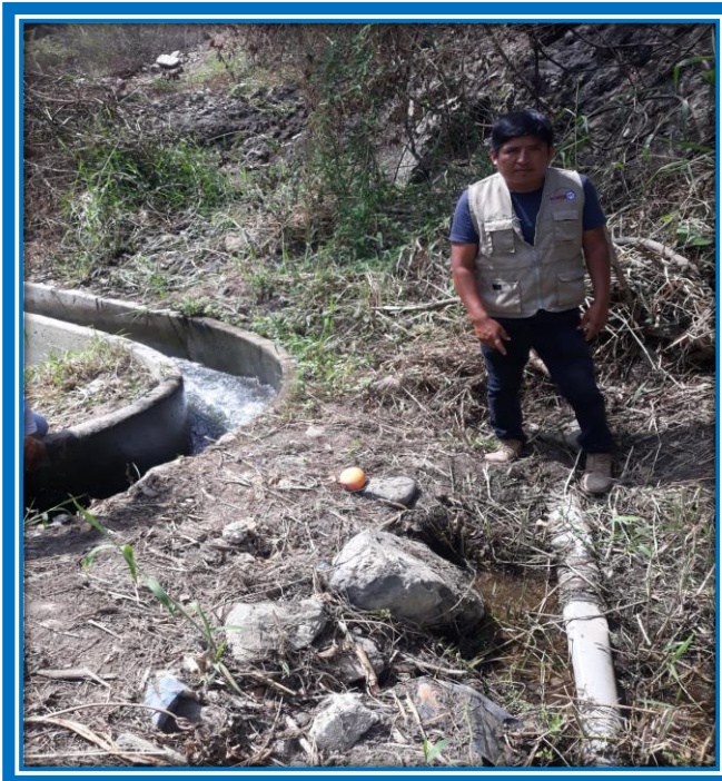
Foto N° 06.- se evaluó el estado de la línea de conducción, además se visualiza que se encuentra a la intemperie propenso a sufrir daños físicos..
