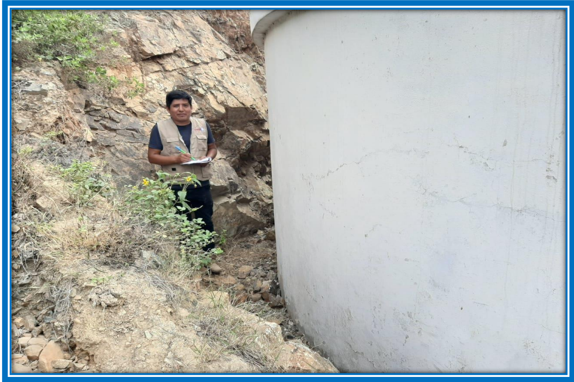
Foto N° 07.- se evaluó el estado del reservorio de almacenamiento.
