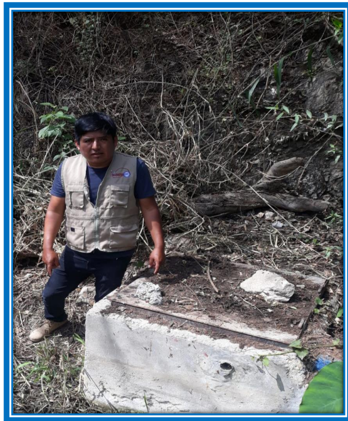
Foto N° 04.- Se evaluó el estado que se encuentra la cámara de captación de Huamba Baja.
