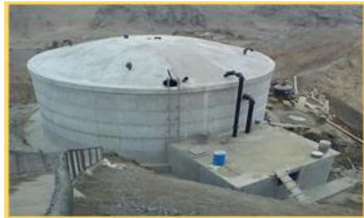
Figura 23: Reservorio apoyado. Fuente: Cesel ingenieros (2016).
