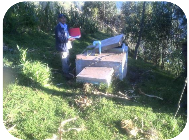
Imagen 14: vista de la 2ª cámara rompe presión CRP-6
