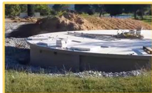
Figura 24: Reservorio enterrado. Fuente: Aquadiposits (2015).
