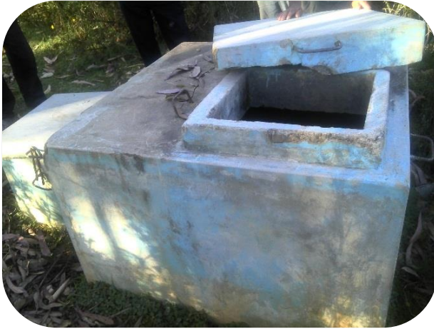
Imagen 13: vista de la 1ª cámara rompe presión CRP-6
