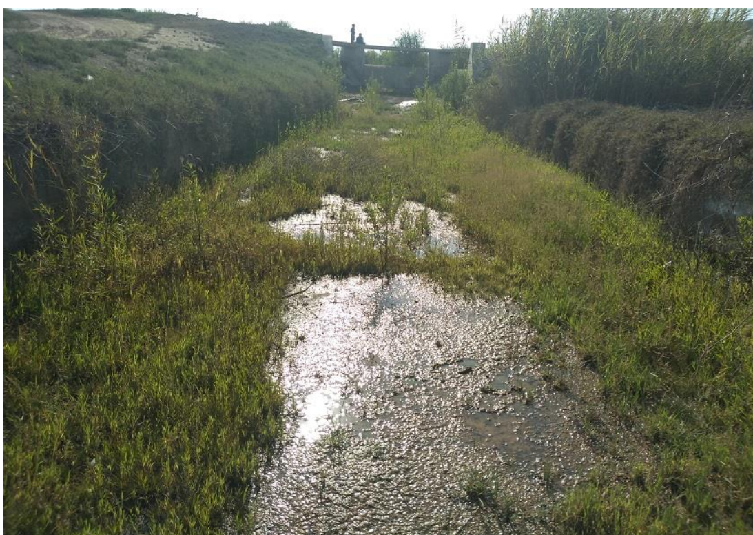
Fotografía 02: foto de la parte céntrica de la Toma de agua
