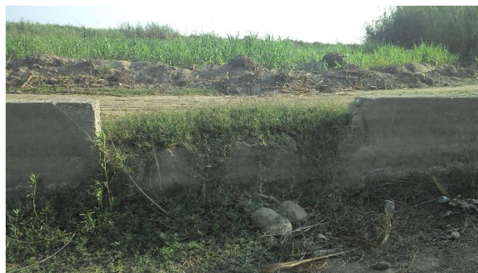
Imagen 3: Patología desintegración en Toma de agua.
