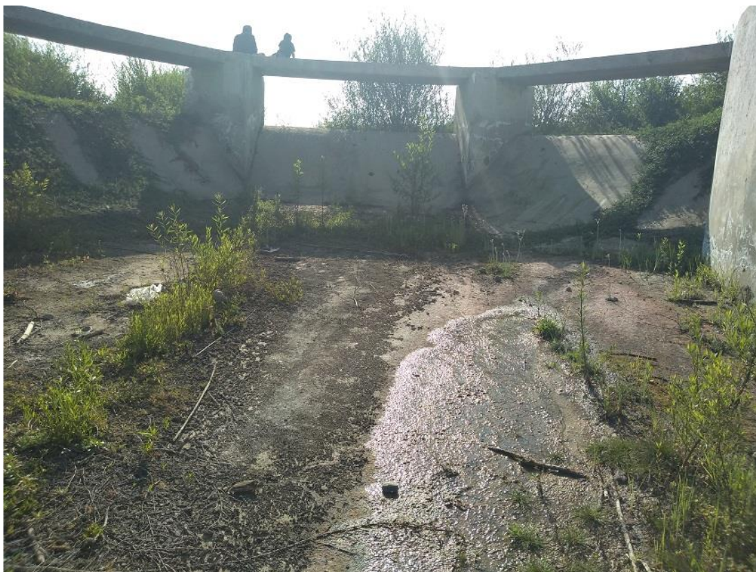
Fotografía 01: Vista inicio de la Toma de agua
