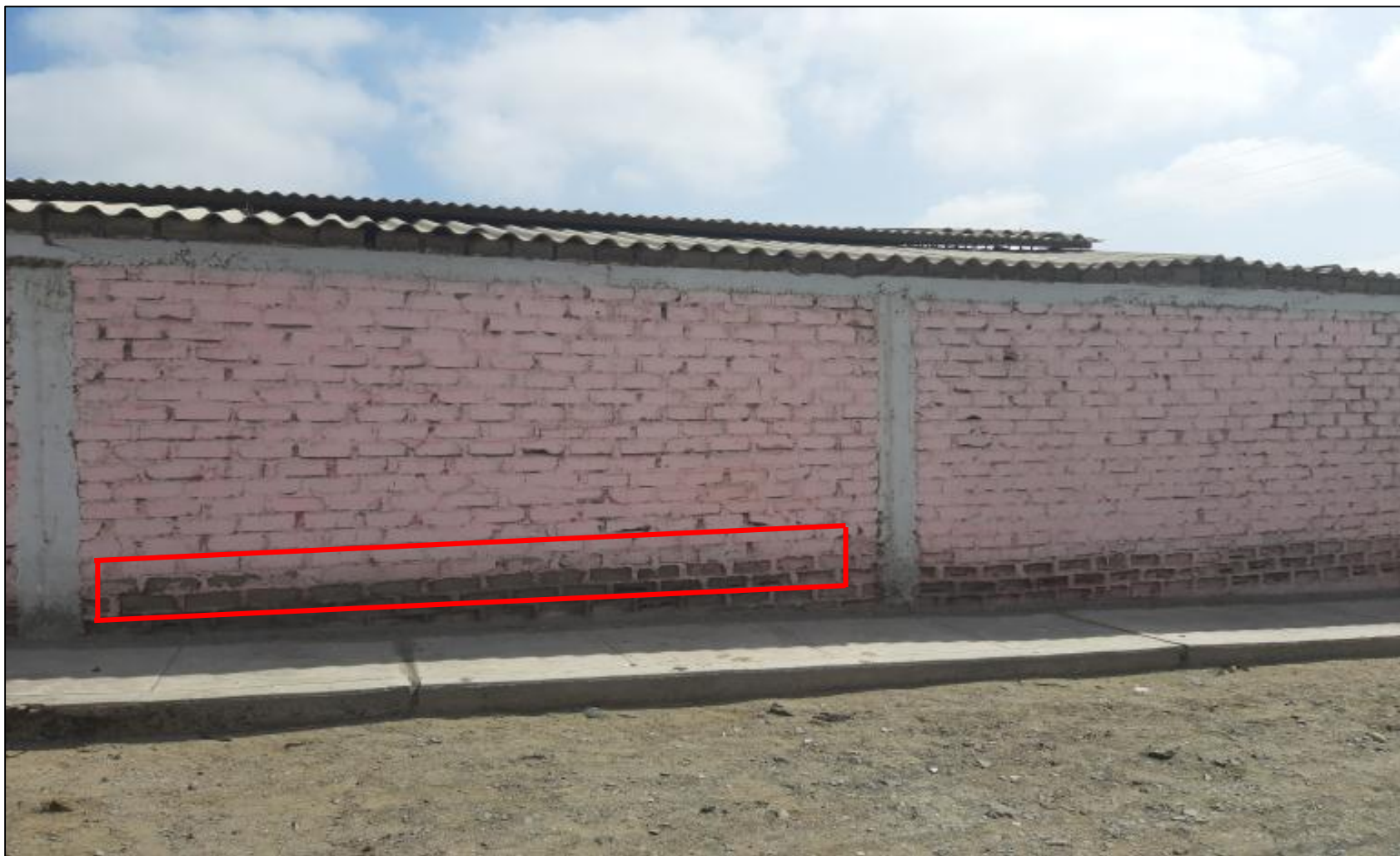
Fotografía 3: Muro afectado por erosión de la unidad muestral 3
