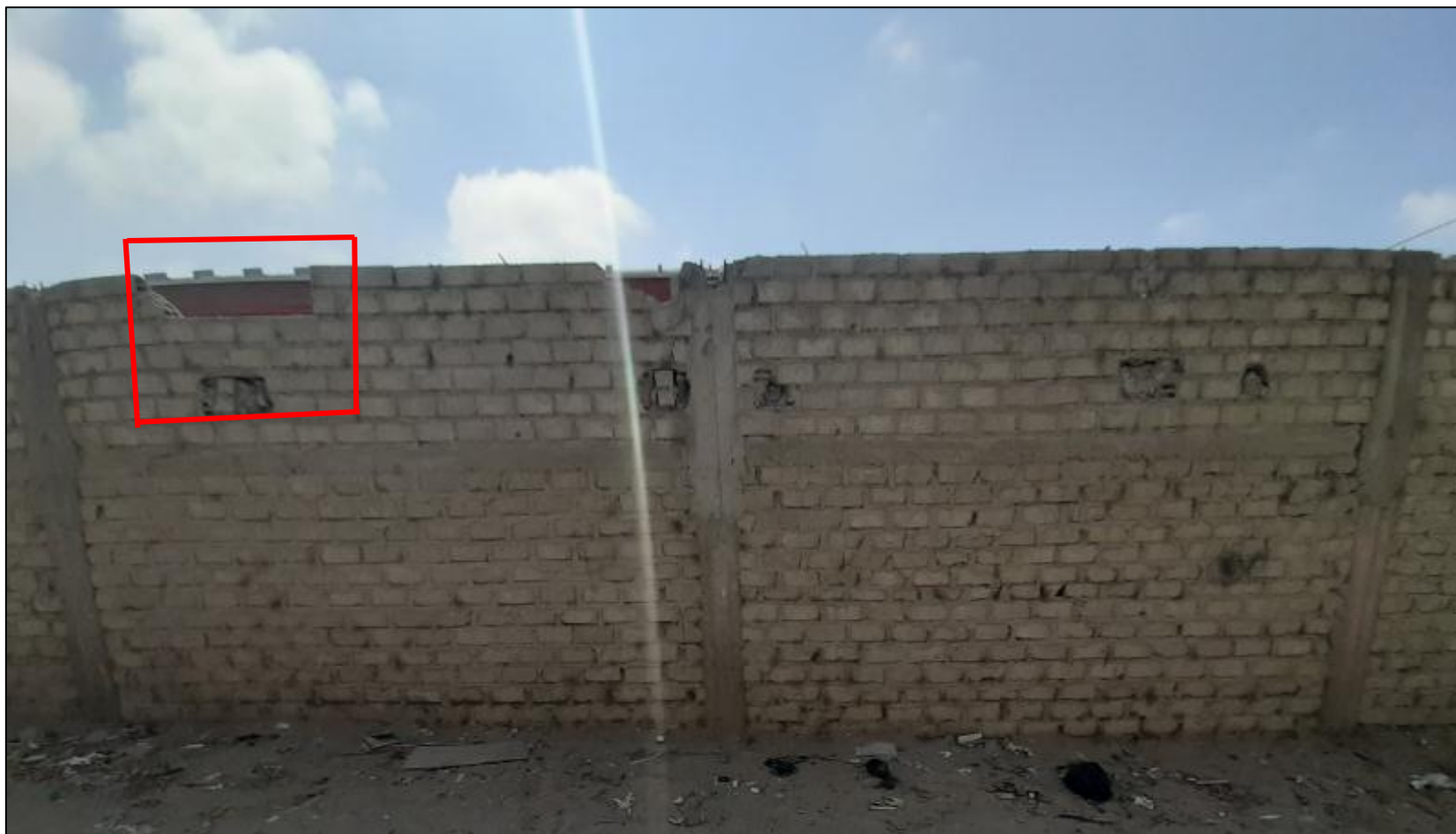
Fotografía 4: Muro afectado por desprendimiento unidad muestral 6
