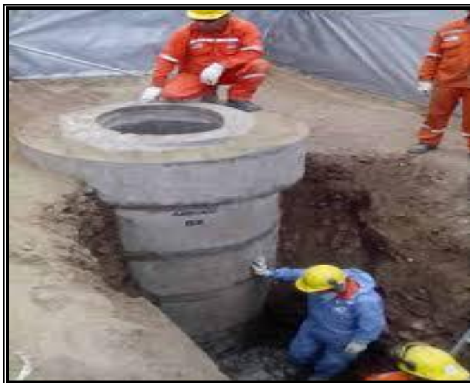
Figura 5: Buzón de concreto (de 1.20m a 3.00m)
