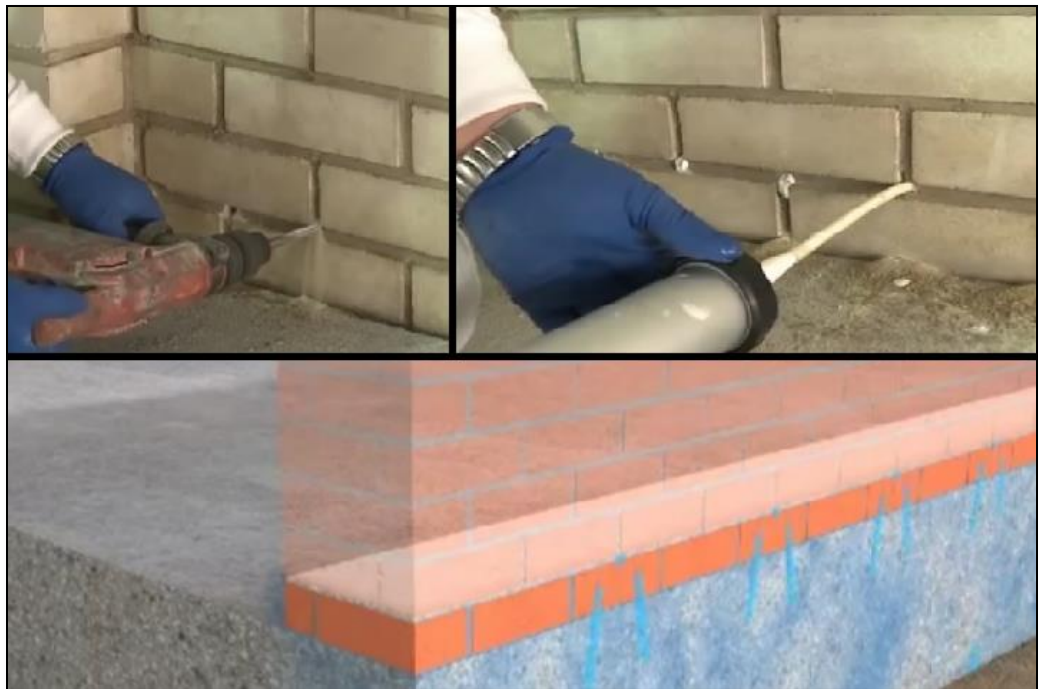
Gráfico 32: Forma de cubrir el muro de la humedad con SikaMur InjectoCream. Nota. Fuente: Elaboración Propia (2019).
