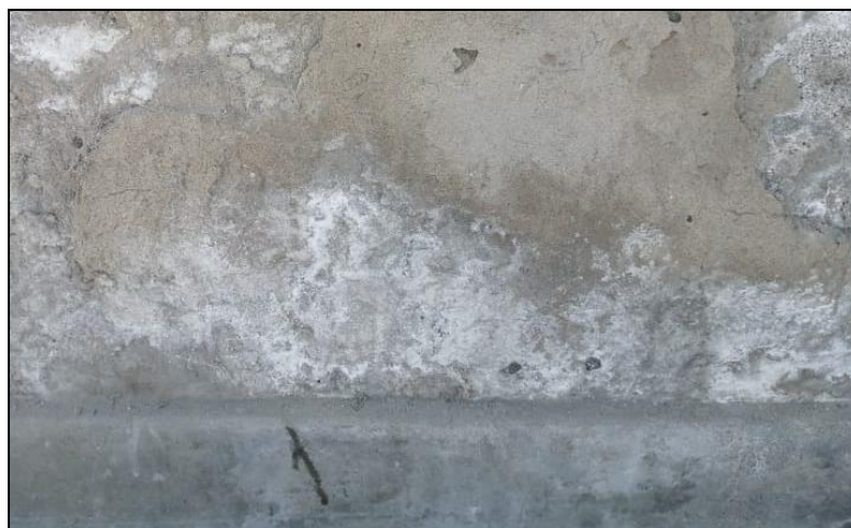
Gráfico 23: Eflorescencia en muro de albañilería.
