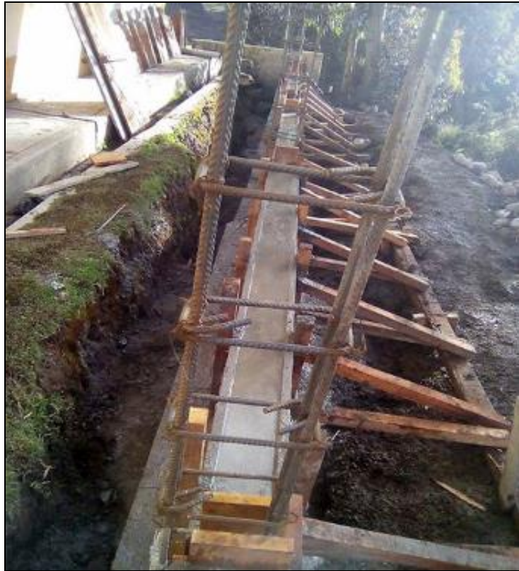
Gráfico 05: Sobrecimiento de concreto simple.
