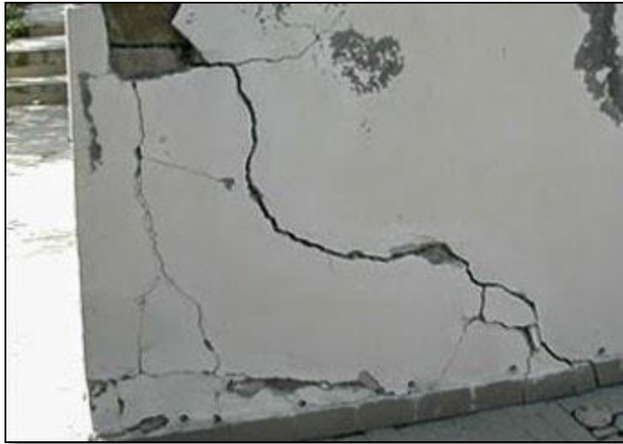
Gráfico 20: Grieta en muro de albañilería confinada.
