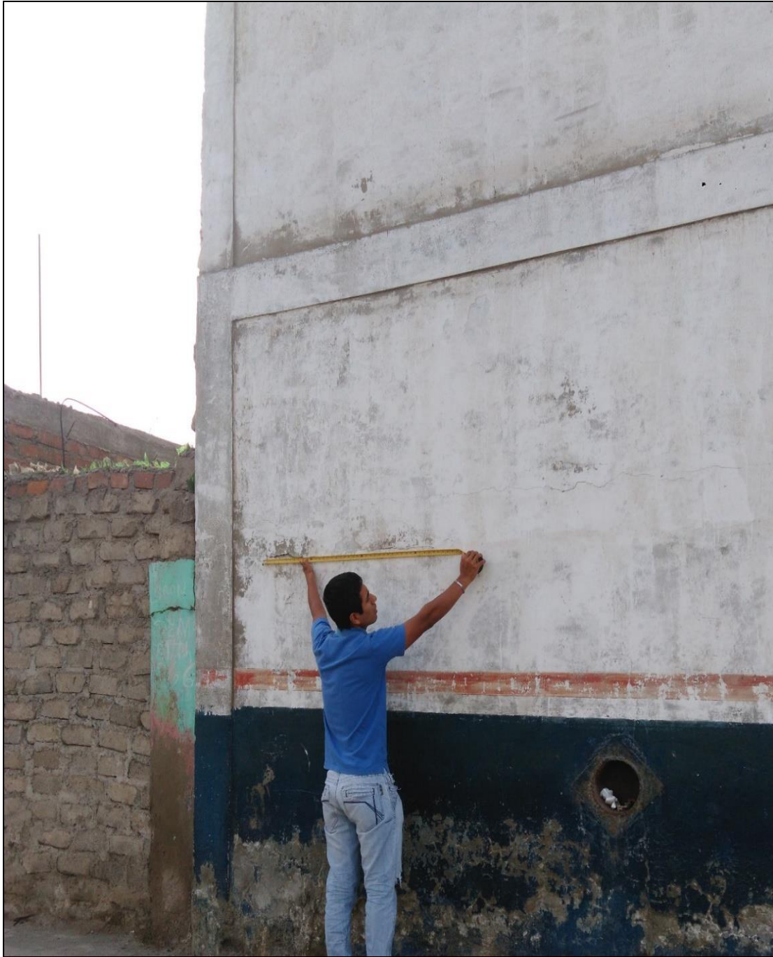
Fotografía 04: Muro de albañilería confinada afectada por fisura y la columna por en la unidad de muestra 10.
