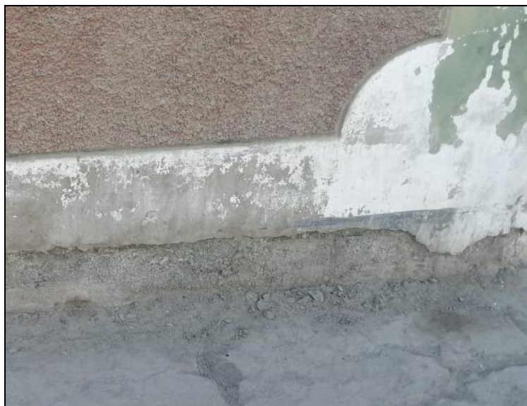
Gráfico 22: Desprendimiento de la parte baja de un muro.
