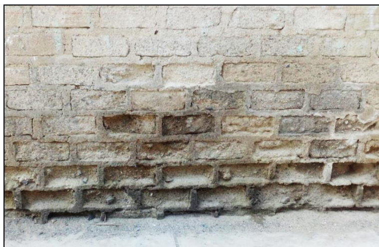
Gráfico 19: Erosión en un muro de albañilería confinada.
