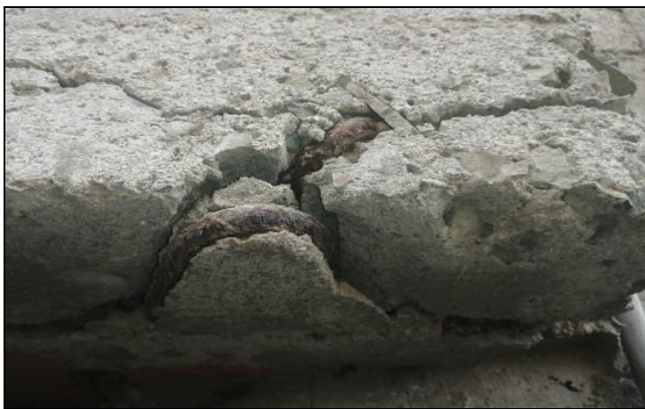
Gráfico 24: Corrosión presentado en losa aligerada.
