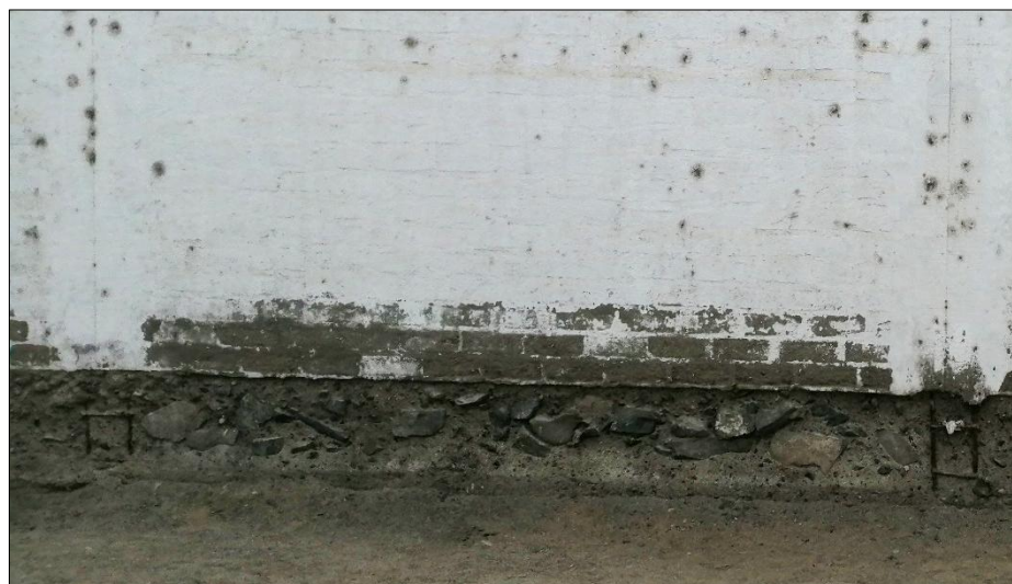
Figura 9. Sobrecimiento erosionado por agentes atmosféricos. Fuente: Investigación propia (2019).
