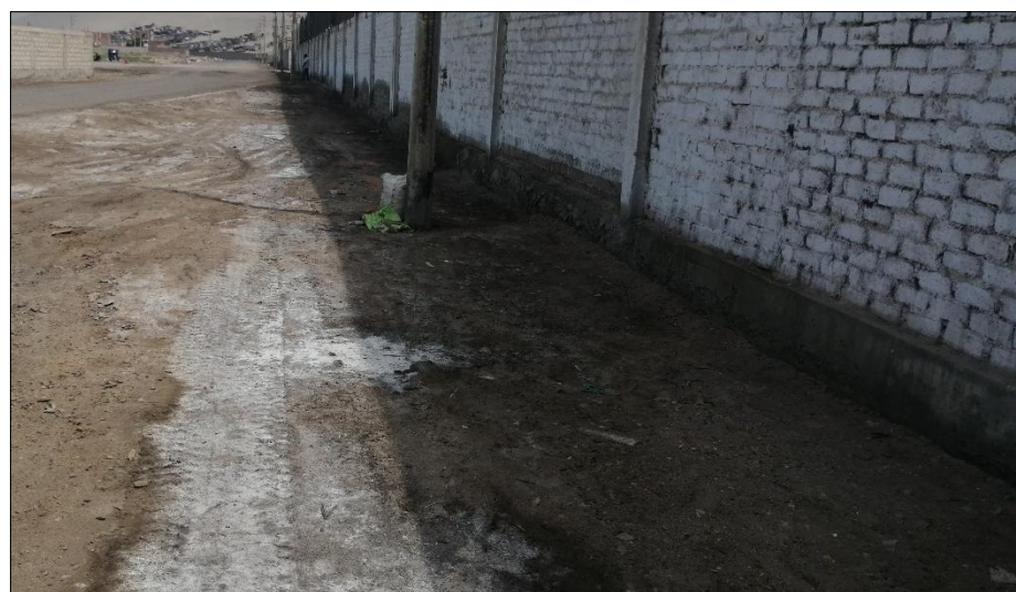
Figura 14. Eflorescencia en sobrecimientos, causa por terreno con sales. Fuente: Investigación propia (2019).
