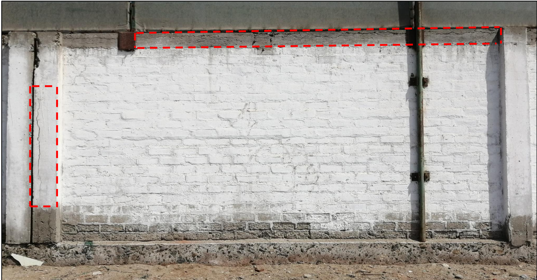
Figura 26. Viga y columna afectadas por las grietas en la UM-07.
