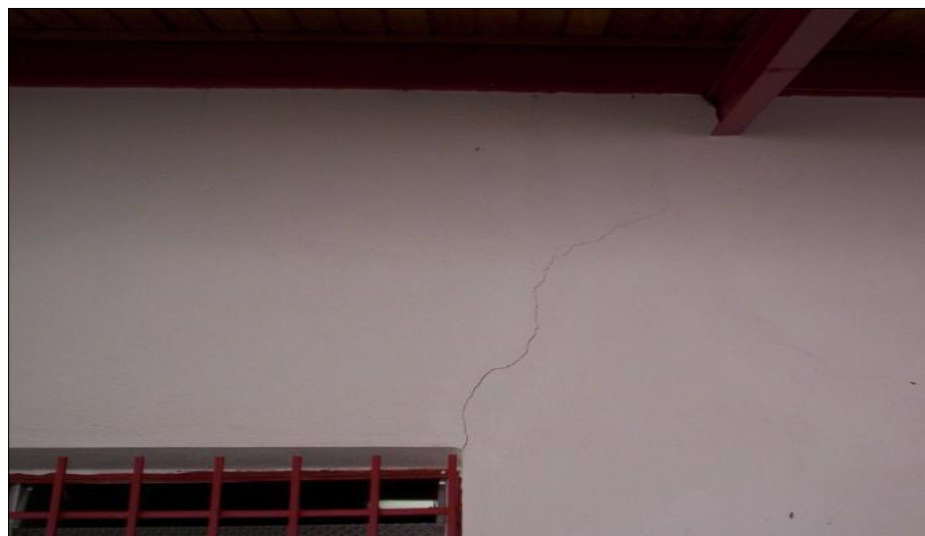
Figura 12. Fisura en un muro de albañilería.
