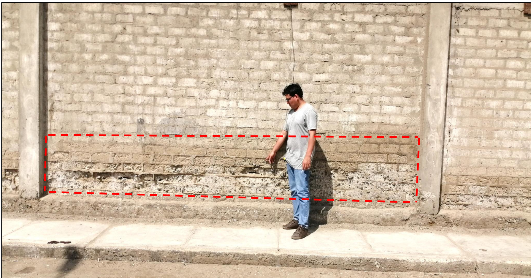
Figura 23. Muro de albañilería afectado por la erosión química en la UM-12.
