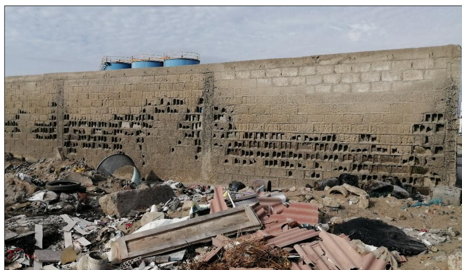
Figura 11. Muro erosionado por agentes químicos.
