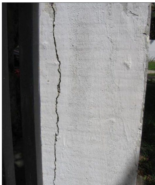
Figura 13. Grieta en columna, paralela a la armadura longitudinal.
