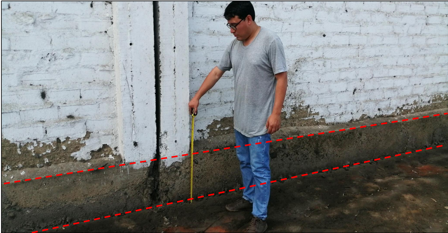
Figura 22. Cimiento afectado por la erosión física en la UM-17.
