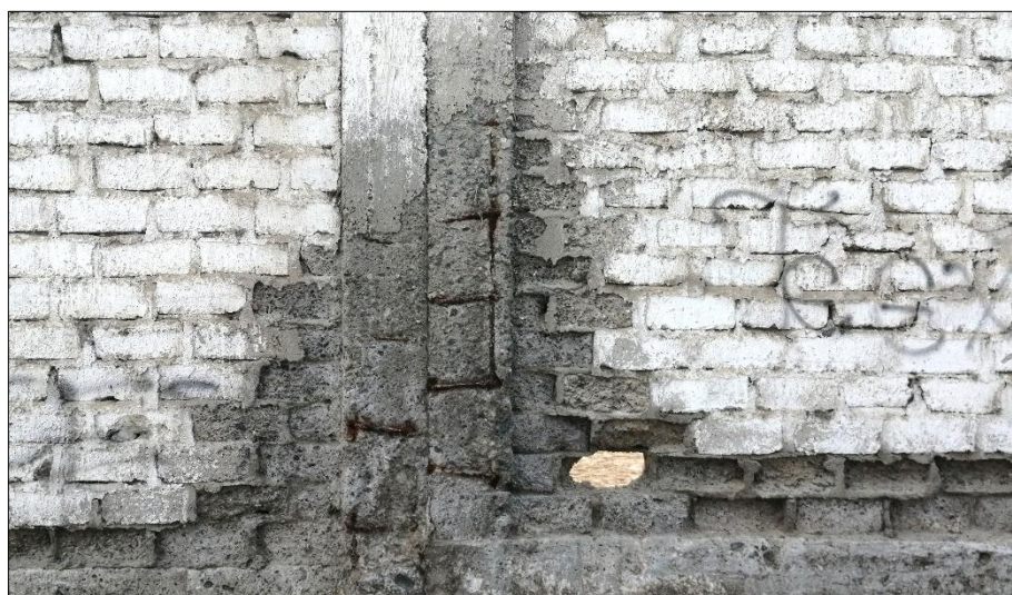
Figura 15. Corrosion en columnas contiguas.
