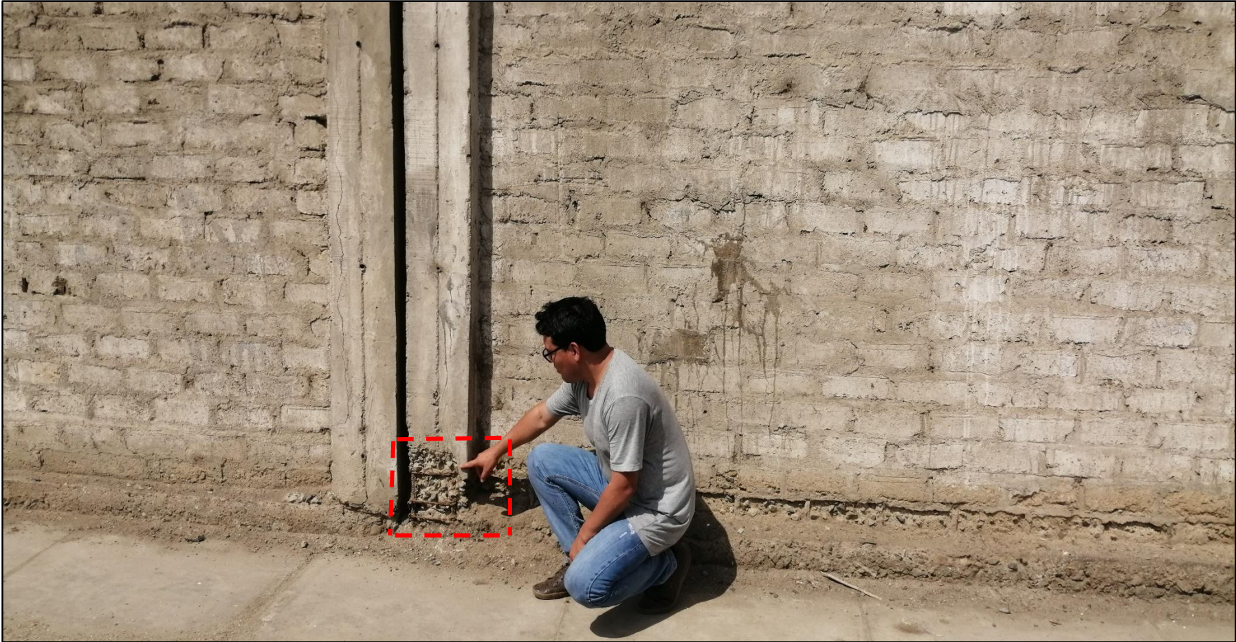
Figura 27. Columna afectada por la corrosión en la UM-14.
