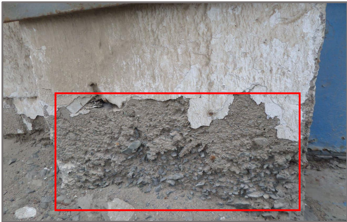
Fotografía 09: Muro afectado por erosión en la unidad muestral 03, con un área afectada de 10.55% y un nivel de severidad Medio.
