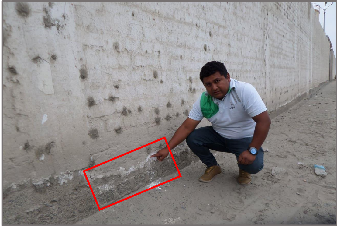
Fotografía 10: Toma de medidas de la patología eflorescencia en muro de la unidad muestral 14.
