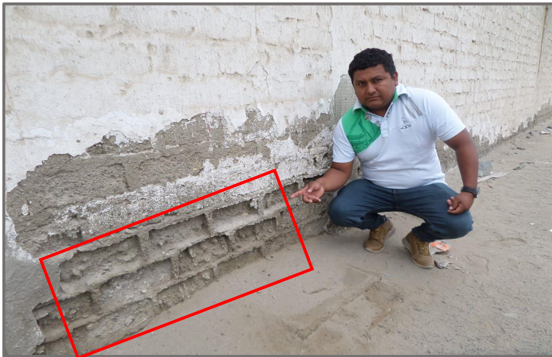
Fotografía 06: Muro afectado por desintegración en la unidad muestral 01, con un porcentaje de área afectada de 0.09% y un nivel de severidad bajo.
