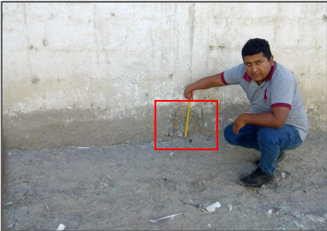
Fotografía 13: Columna afectada por corrosión en la unidad muestral 07, con un porcentaje de área afectada de 2.49% y un nivel de severidad medio.
