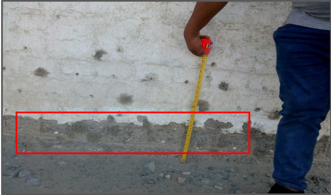
Fotografía 08: Muro afectado por erosión en la unidad muestral 04, con un porcentaje de área afectada de 0.52% y un nivel de severidad medio, medida con un medidor de cinta métrica.
