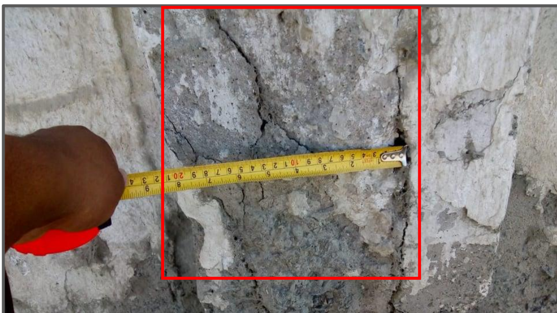
Fotografía 05: Muro afectado por grieta en la unidad muestral 09, con un ancho de 2.30 mm y un nivel de severidad alto, medida con un medidor de cinta métrica.
