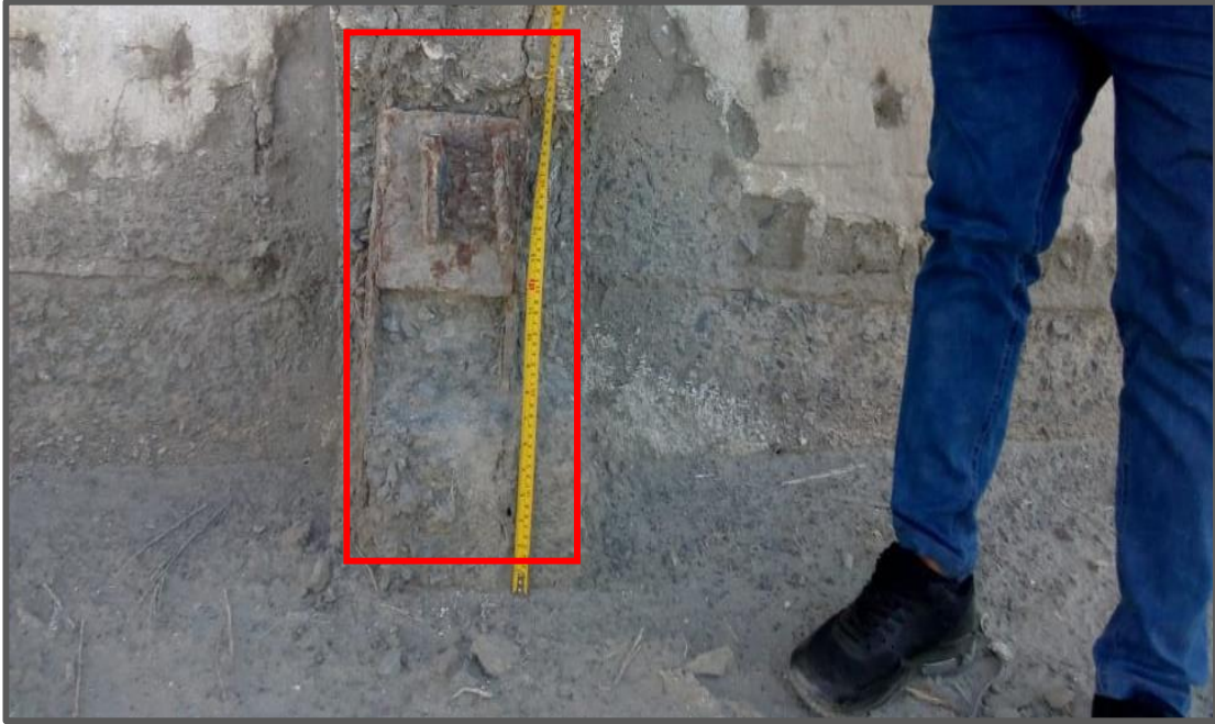
Fotografía 12: Columna afectada por corrosión en la unidad muestral 09, con un porcentaje de área afectada de 12.37% y un nivel de severidad alto.
