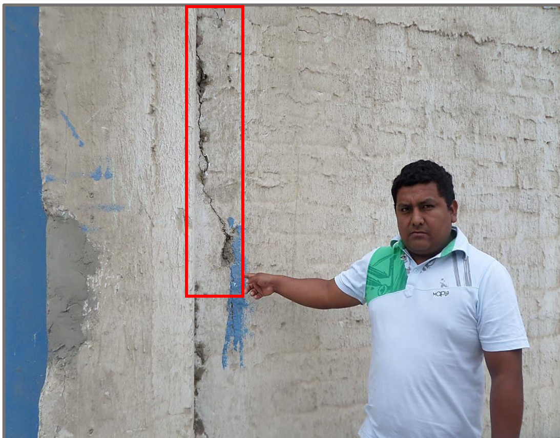
Fotografía 04: Muro afectado por grieta en la unidad muestral 02, con un ancho de 3.00 mm y un nivel de severidad alto.
