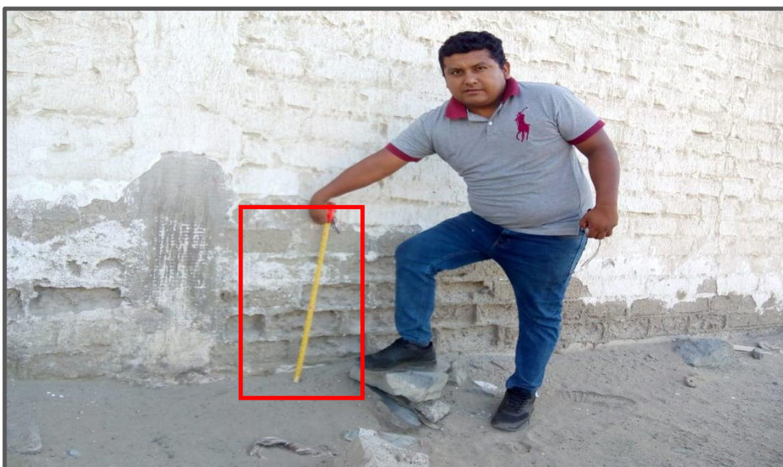
Fotografía 07: Muro afectado por desintegración en la unidad muestral 04, con un porcentaje de área afectada de 0.28% y un nivel de severidad bajo, medida con un medidor de cinta métrica.
