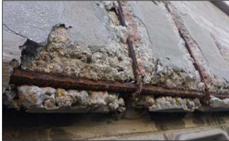
Gráfico 29. Fotografía de corrosión en vigas de concreto armado. (Fuente: RB Conspro. 2013).
