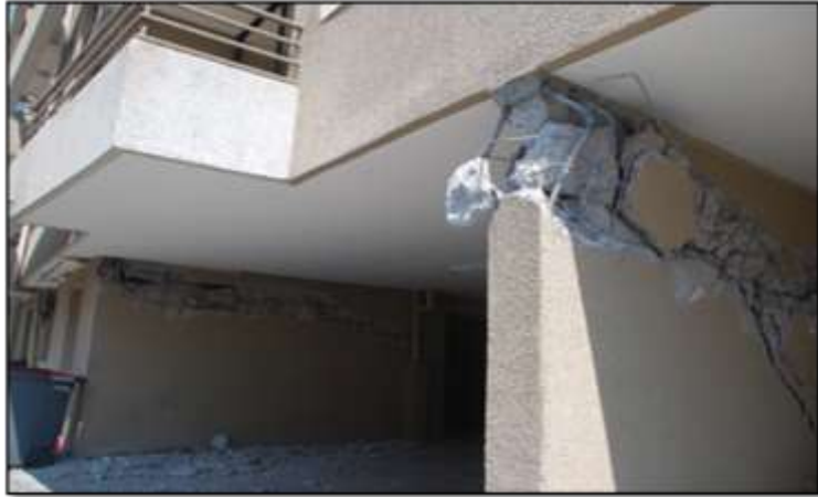
Gráfico 18. Fotografía de falla en base de muro estructural del primer piso.
