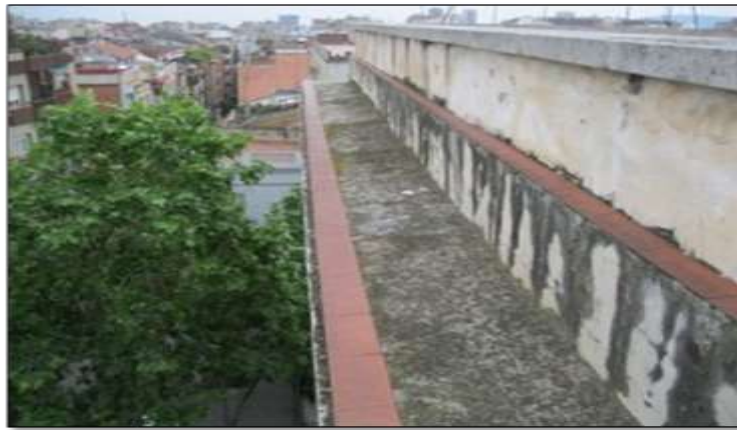
Gráfico 17. Fotografía de edificio afectado por agentes atmosféricos.
