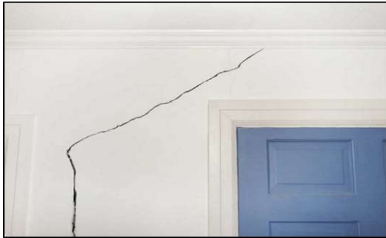
Gráfico 22. Fotografía de grieta en una pared. (Fuente: pintar-paredes. 2019).
