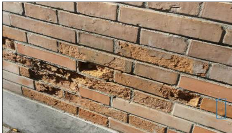
Gráfico 28. Fotografía de ladrillos degradados por Criptoflorescencia.
