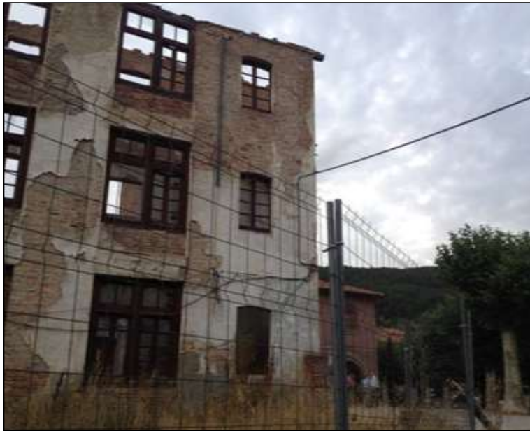
Gráfico 26. Fotografía de desprendimientos de material en fachada. (Fuente: Gancedo. 2012). el viejo cuartel de Sabero,
