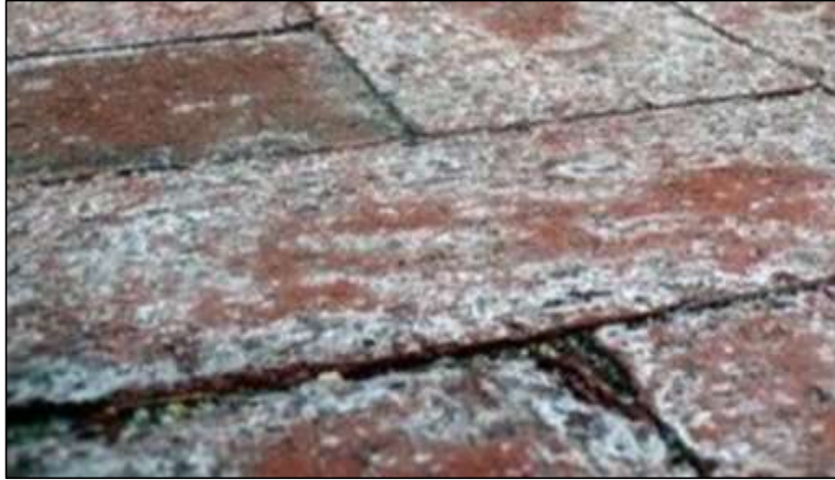
Gráfico 27. Fotografía de eflorescencias en ladrillos a causa de sales de sulfatos.
