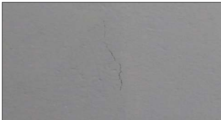
Gráfico 24. Fotografía de fisura en una pared. (Fuente: Elaboración propia, 2019.).
