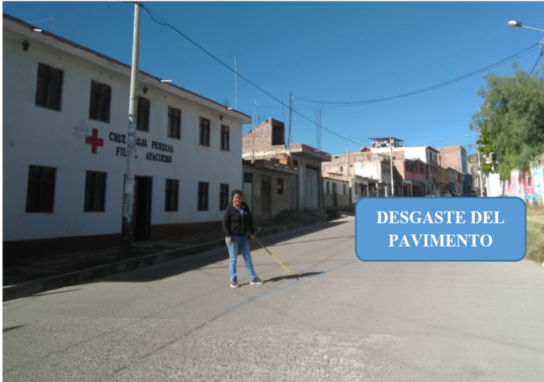
Fotografía 13: registro de patologías en la av. Javier Heraud.
