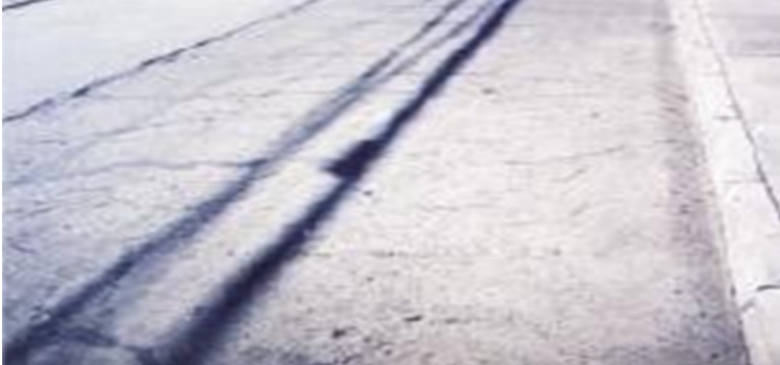
Figura 2.10: Fisuramiento por retracción.
