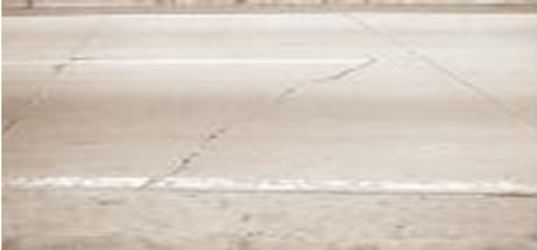
Figura 2.9: Grietas Transversales. Fuente:(Rebolledo Valdivia, 2010).
