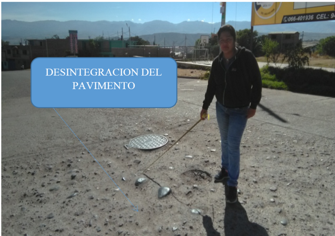
Fotografía 14: registro de patologías en la av. Javier Heraud.
