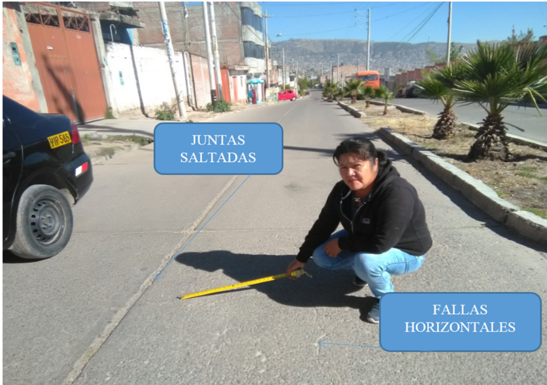
Fotografía 11: registro de patologías en av. Venezuela cuadra – 07.
