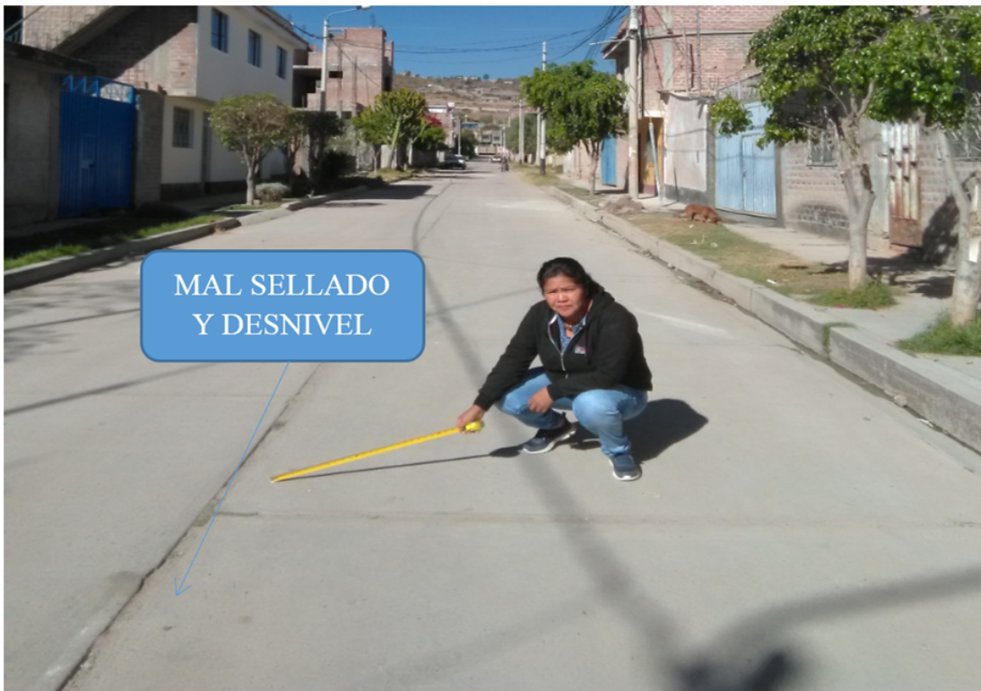
Fotografía 12: registro de patologías en el jr. Cañete.
