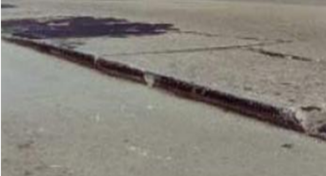
Figura 2.14: Escalonamiento de juntas y grietas.
