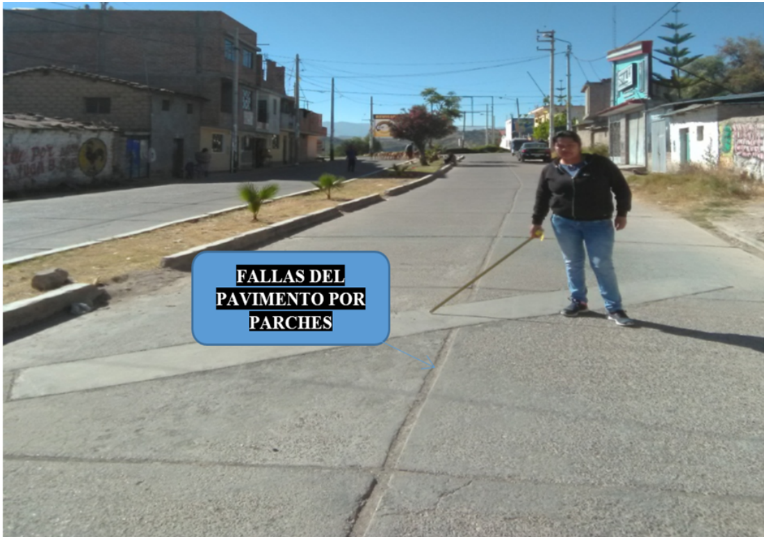
Fotografía 10: registro de patologías en av. Venezuela cuadra – 07.
