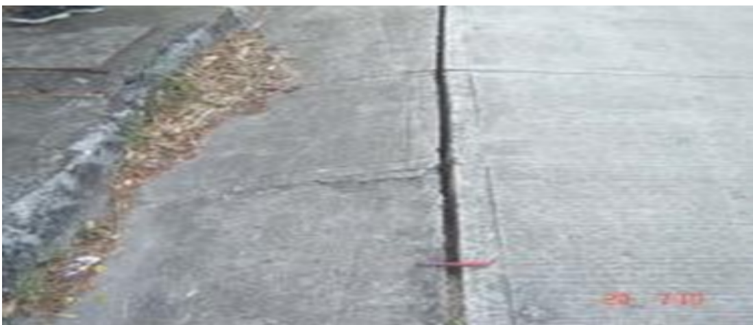
Figura 2.16: Separación entre berma y pavimento. Fuente:(Rebolledo Valdivia, 2010).
