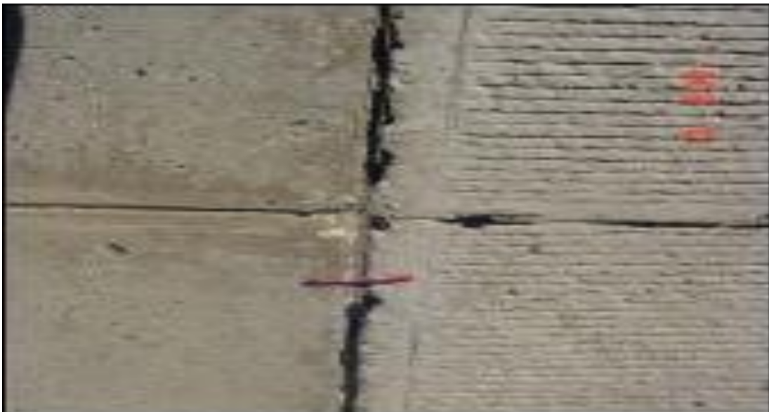
Figura 2.4: Deficiencias del sellado.
