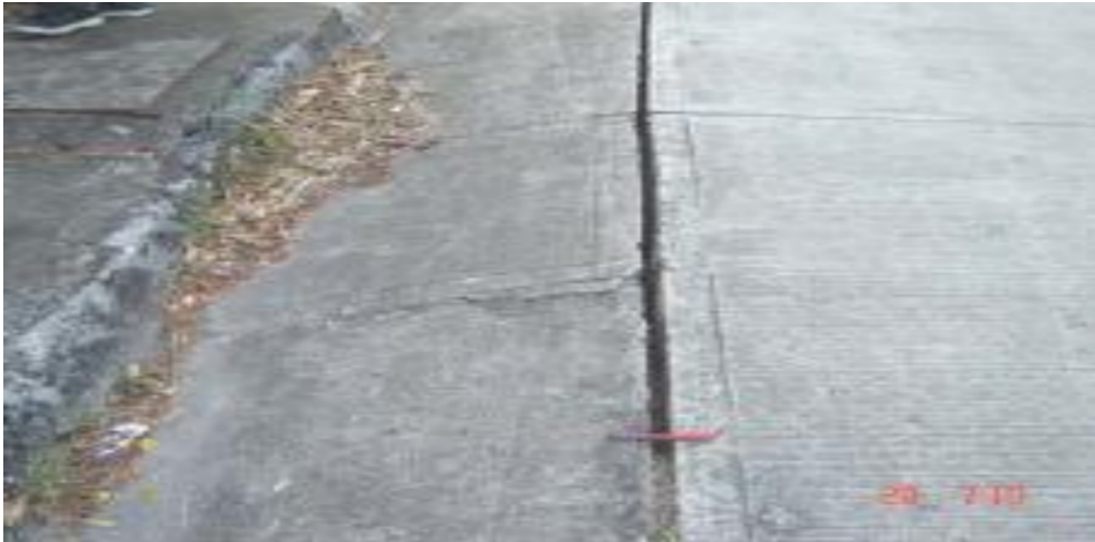
Figura 2.14: Separación entre berma y pavimento.
