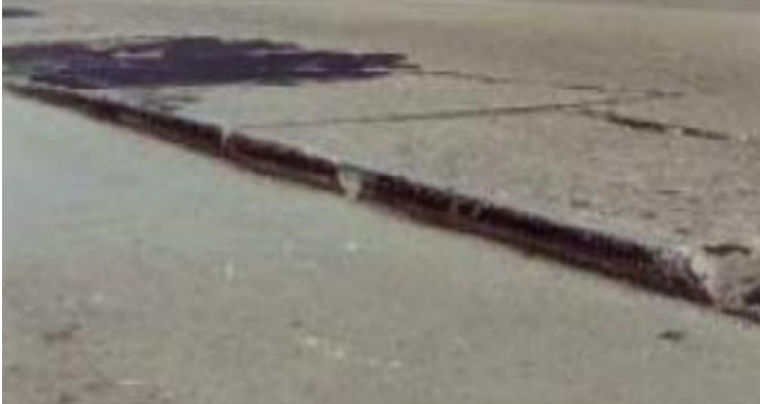
Figura 2.12: Escalonamientos de juntas y grietas.
