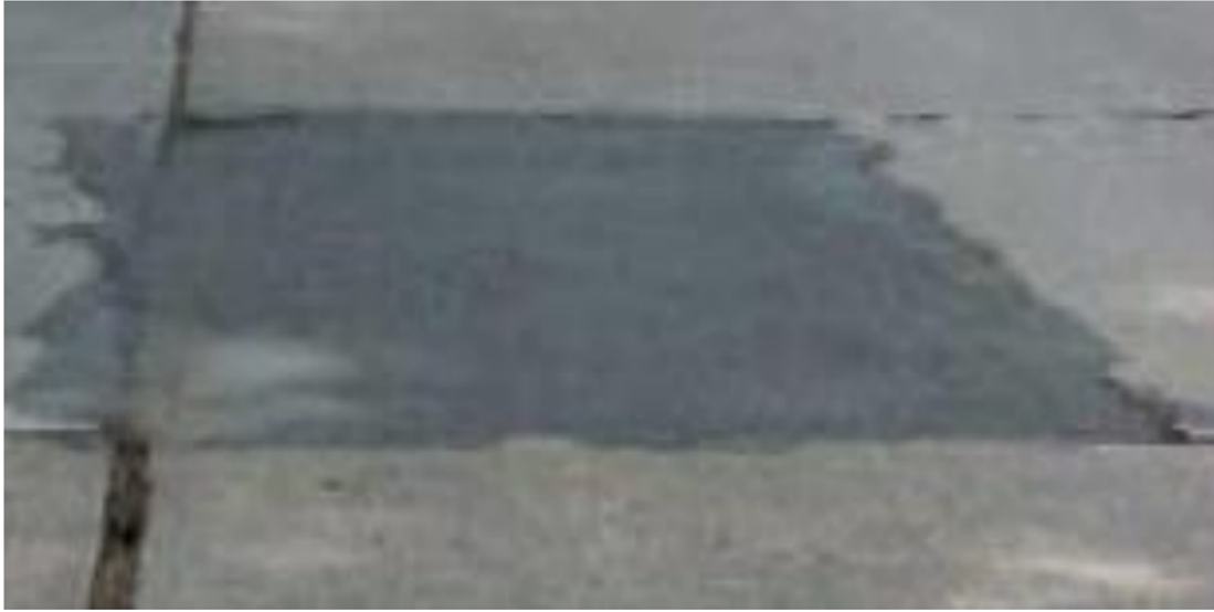
Figura 2.15: Muestra los parches deteriorados del pavimento rígido.
