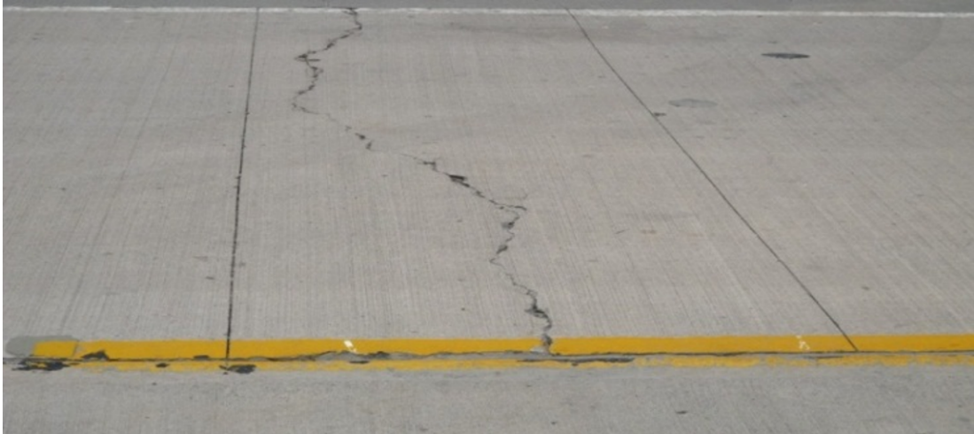
Figura 2.7: Grieta transversal del pavimento rígido.
