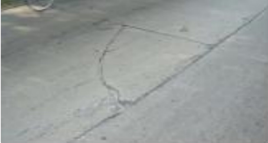
Figura 2.5: Grieta de esquina del pavimento rígido.
