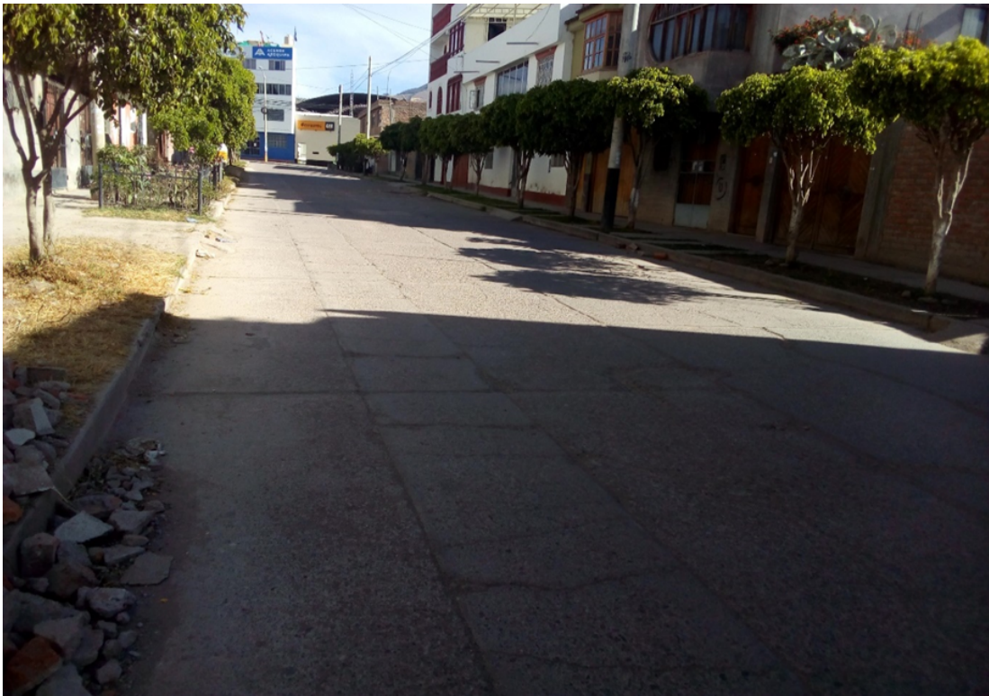
Fotografía 4: Inspección de la falla Parcheo Grande de severidad alta Jirón Wari.
