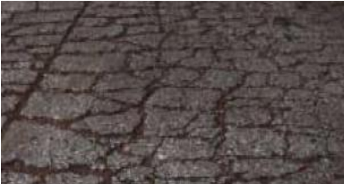
Figura 2.17: El fragmento múltiple en el pavimento rígido.
