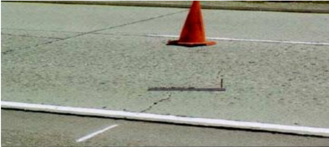
Figura 2.9: Desintegración del pavimento rígido.
