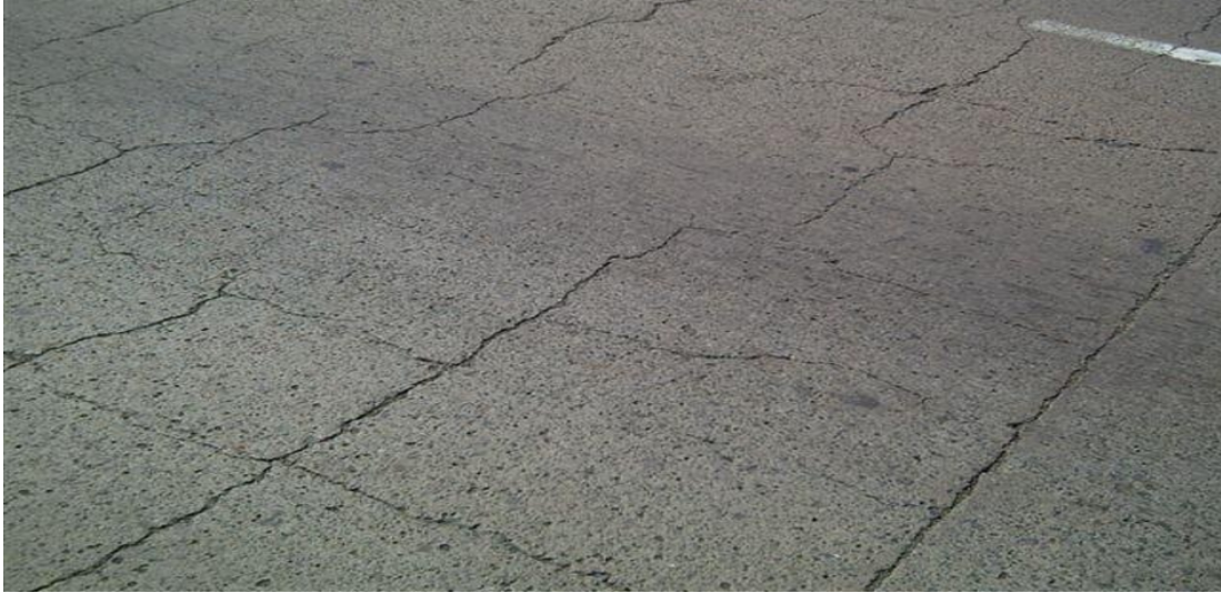
Figura 2.8: Fisuramiento por retracción.
