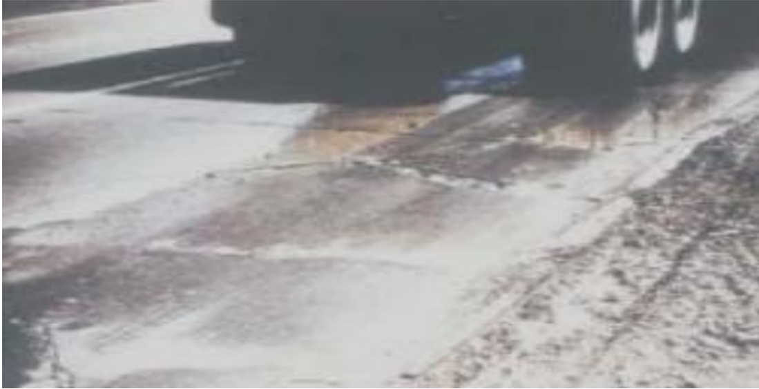
Figura 2.16: La surgencia de finos en el pavimento rígido.
