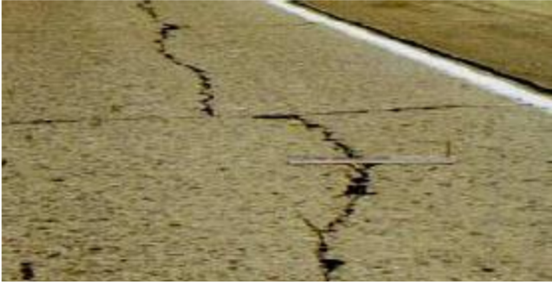
Figura 2.6: Grieta longitudinal del pavimento rígido.
