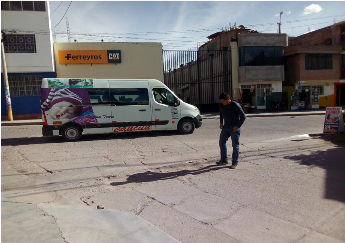
Fotografía 5: Inspección de falla parcheo grande, desconchamiento, losa dividida Jirón Wari.
