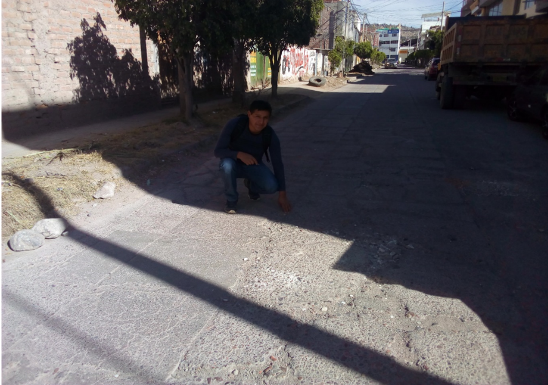
Fotografía 3: Inspección de la falla Losa Dividida de severidad alta Jirón Wari.
