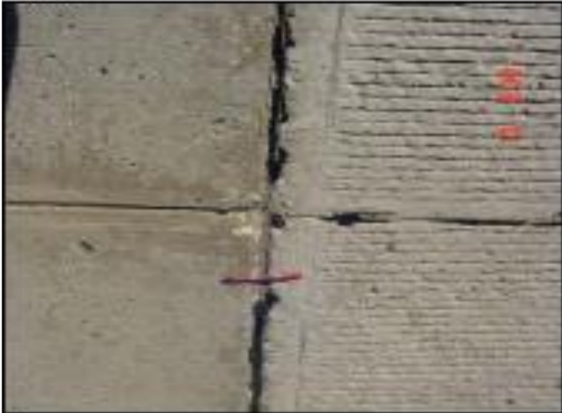
Figura 2.2: Deficiencias de sellado del pavimento rígido.
