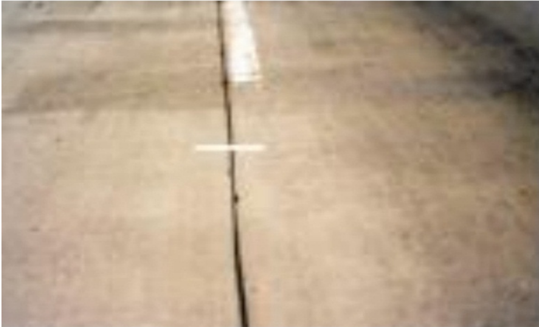
Figura 2.4: Separaciones de la junta longitudinal del pavimento rígido.
