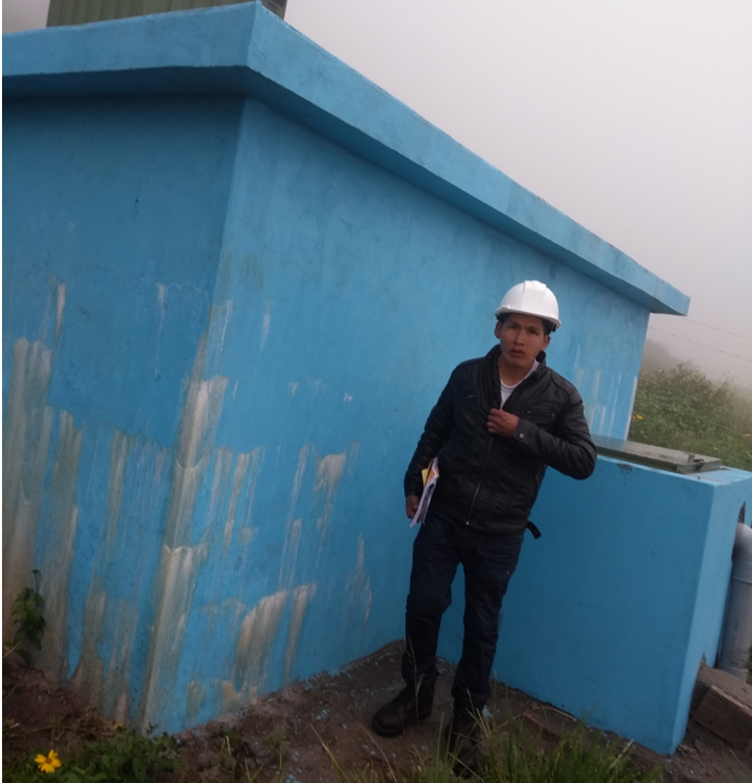
Figura 2.17: Tanque de almacenamiento.
