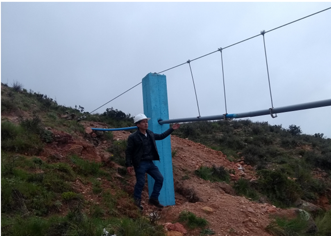
Fotografía 4: Vista lateral del Cruce aéreo.
