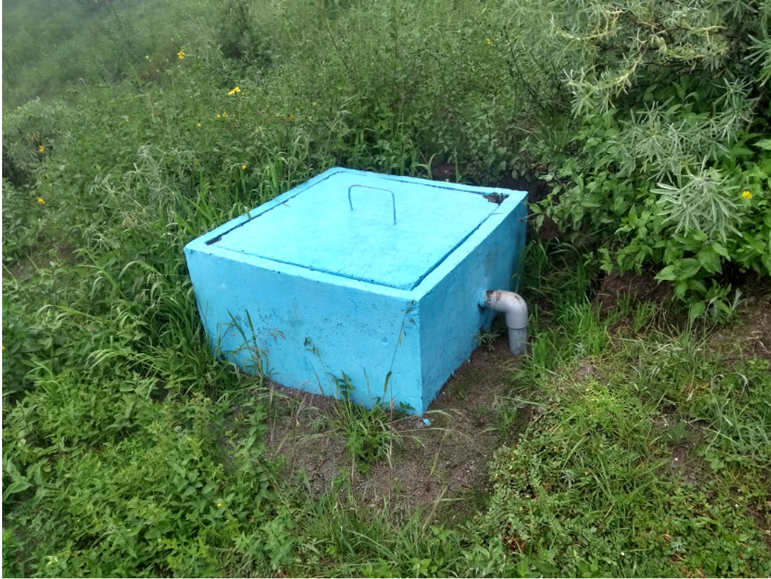
Figura 2.22: Vista externa de un CRP - 6.
