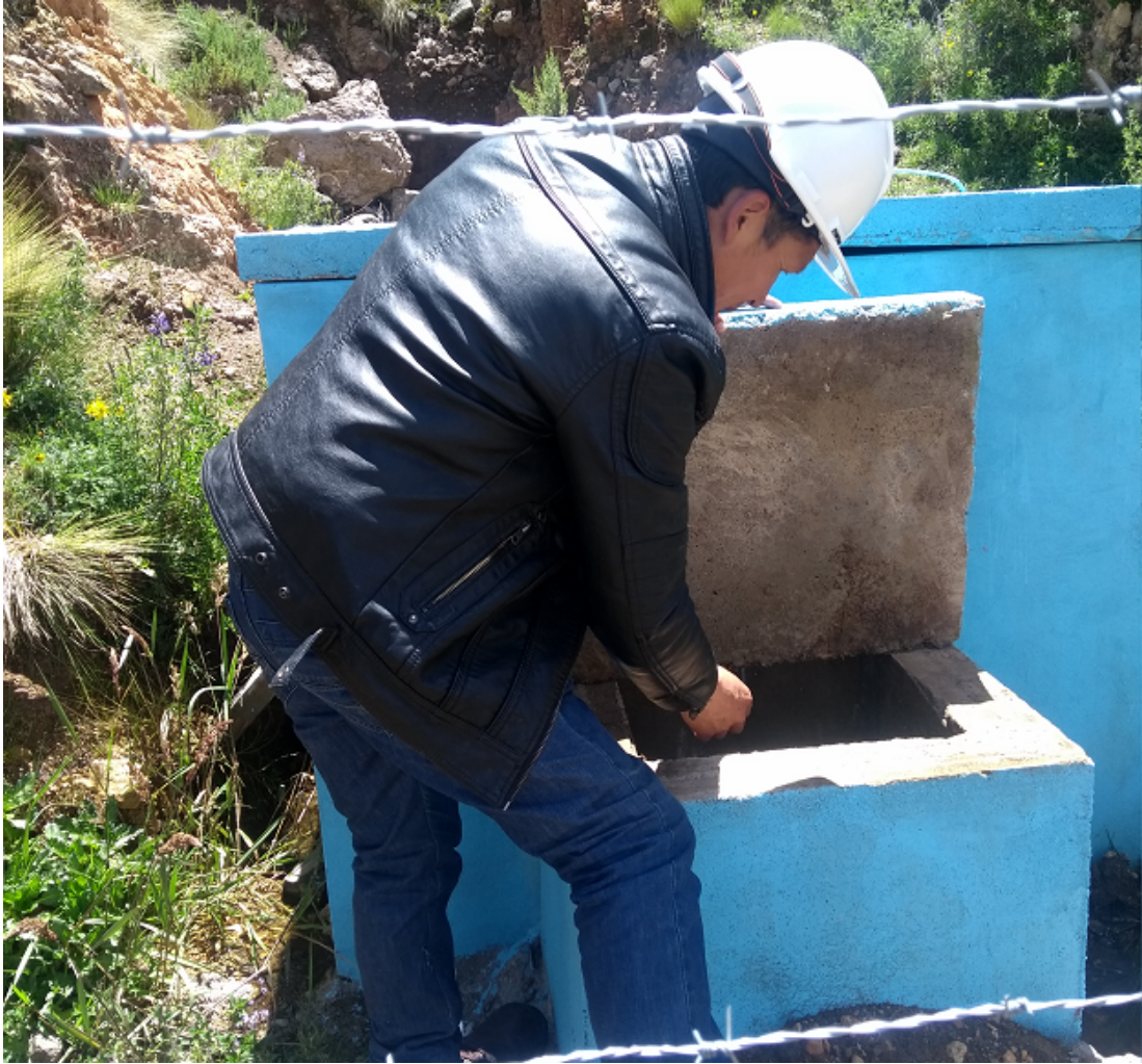
Figura 2.7: Vista externa de la Caja de válvulas.
