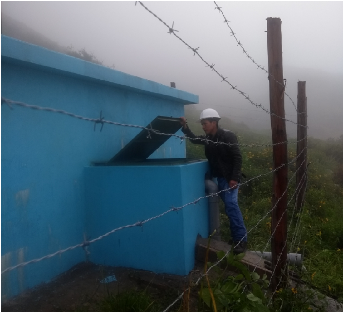
Figura 2.18: Caseta de válvulas.
