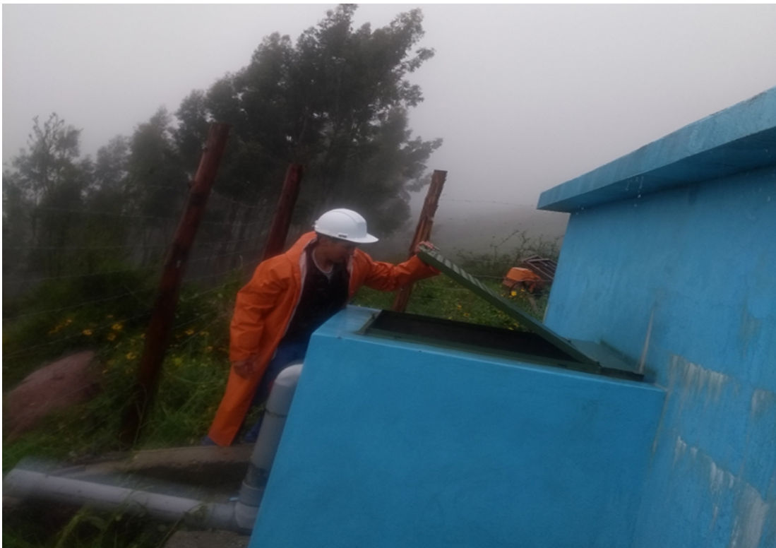
Fotografía 12: Caseta de válvulas del Reservorio.
