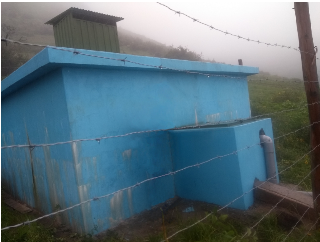
Figura 2.14: Vista frontal de un Reservorio. Fuente: Elaboración propia.
