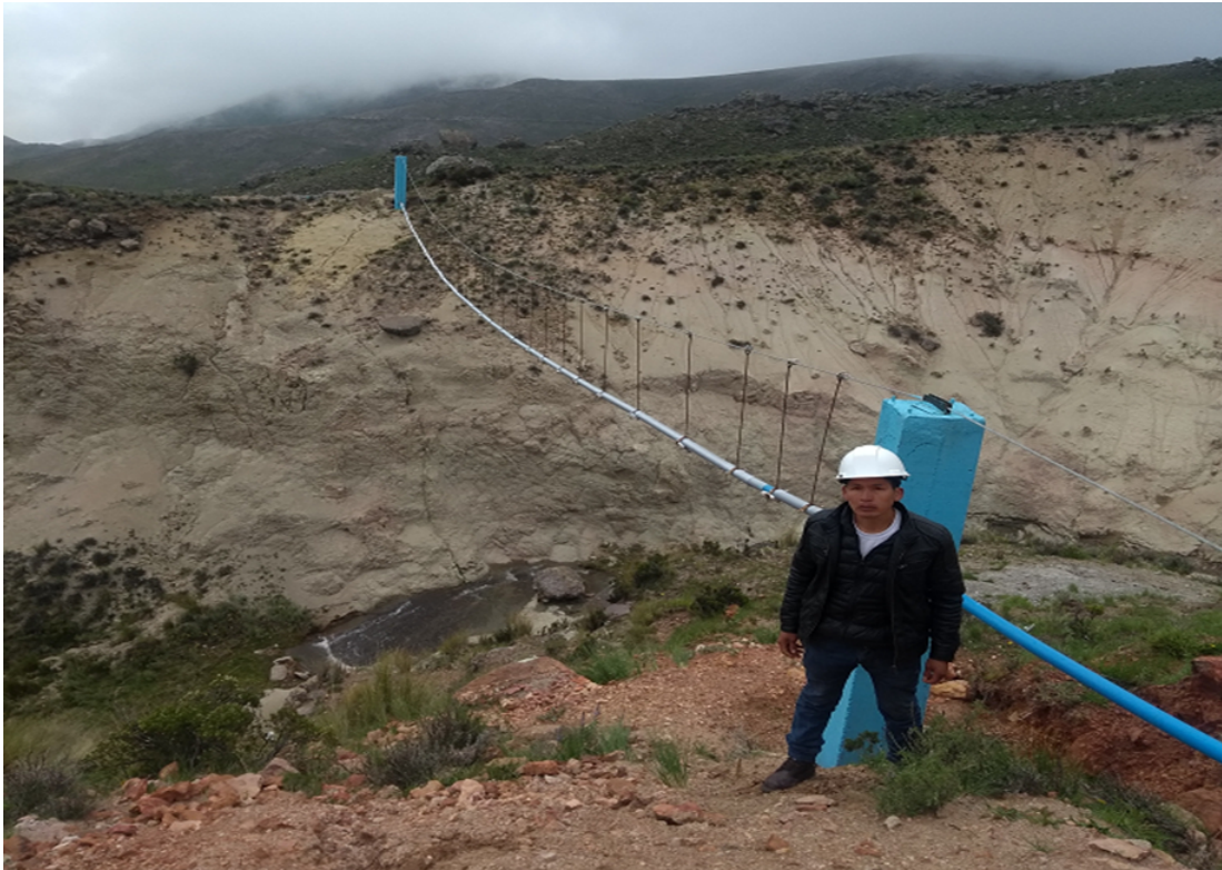
Fotografía 3: Cruce aéreo de la localidad de Challhualla.
