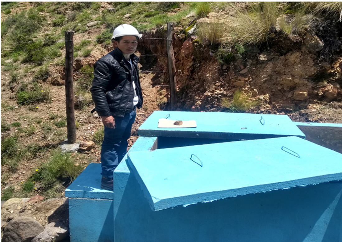
Fotografía 2: Tapa sanitaria de la Captación Sacaramayo.
