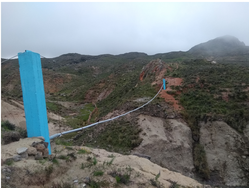
Figura 5.5: Vista frontal de un cruce aéreo. Fuente: Elaboración propia.
