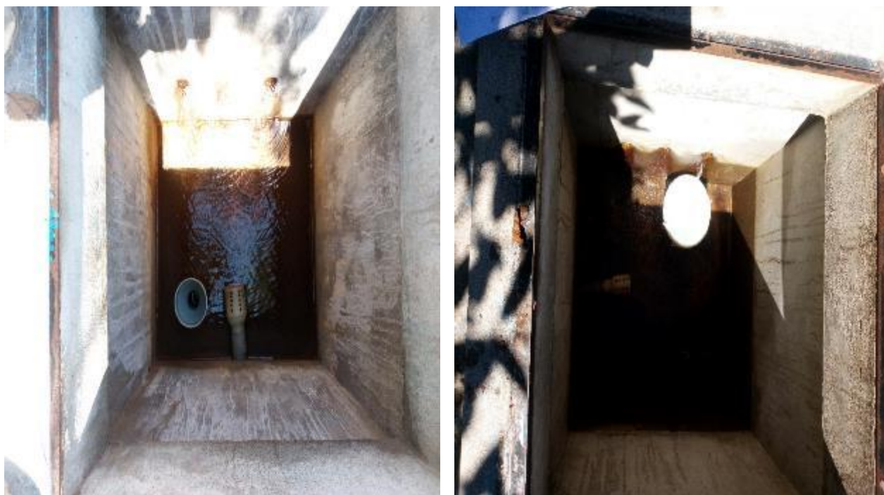
Fotografía 10. Sistema de Agua potable – Captación N° 05 (Parte Interna)
