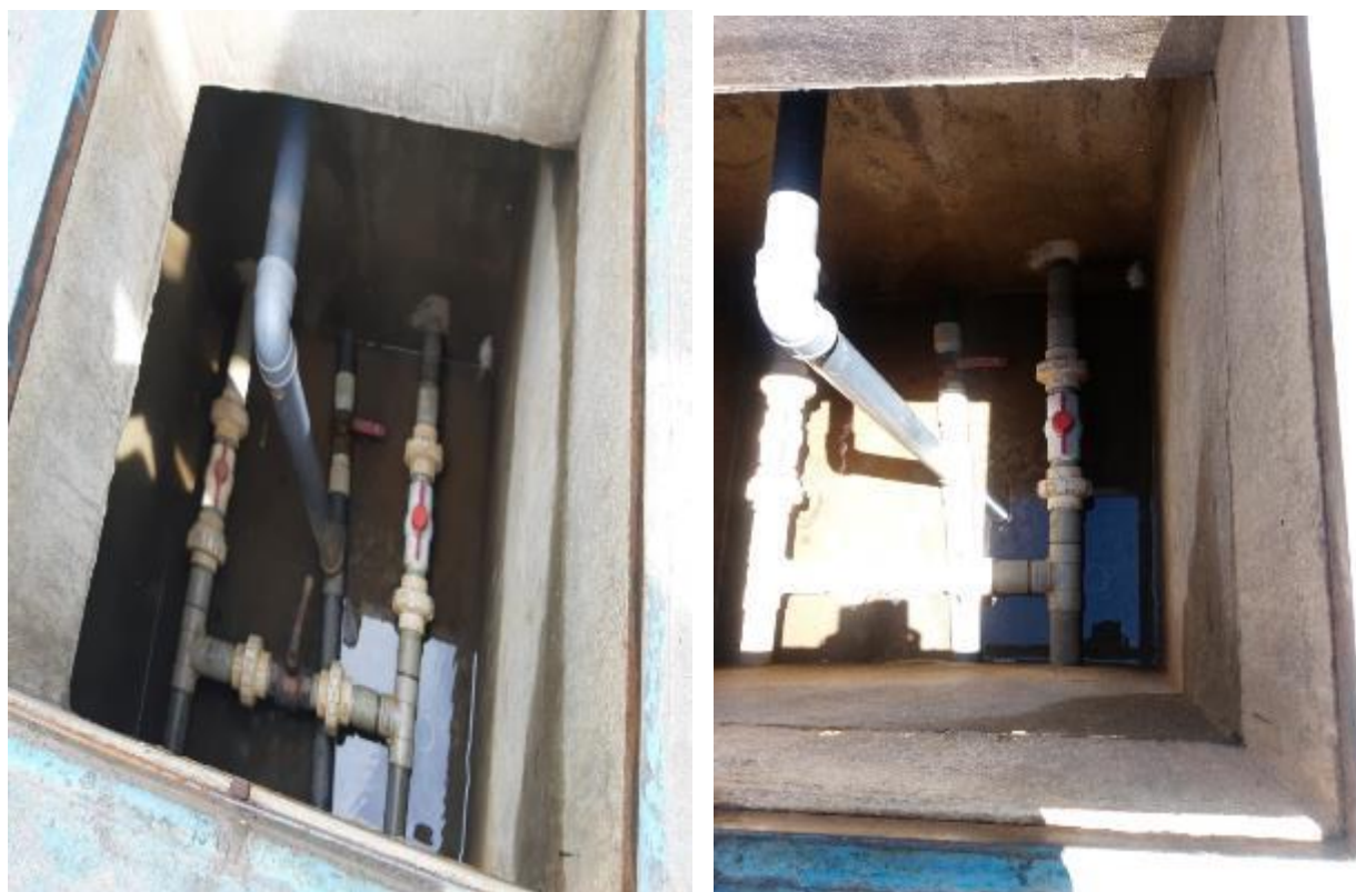
Fotografía 16. Sistema de Agua potable – Reservorio N° 01, Caja de válvulas parte interna
