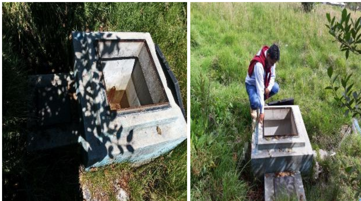
Fotografía 9. Sistema de Agua potable – Captación N° 05
