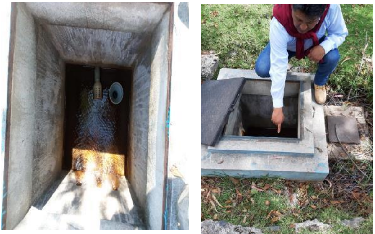
Fotografía 8. Sistema de Agua potable – Captación N° 04 (Parte Interna)
