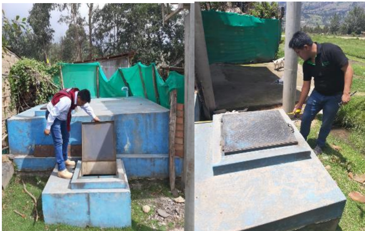
Fotografía 15. Sistema de Agua potable – Reservorio N° 01, Caja de válvulas
