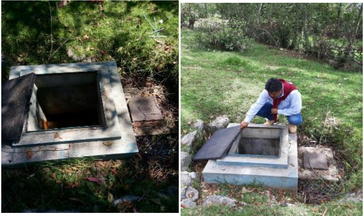
Fotografía 7. Sistema de Agua potable – Captación N° 04
