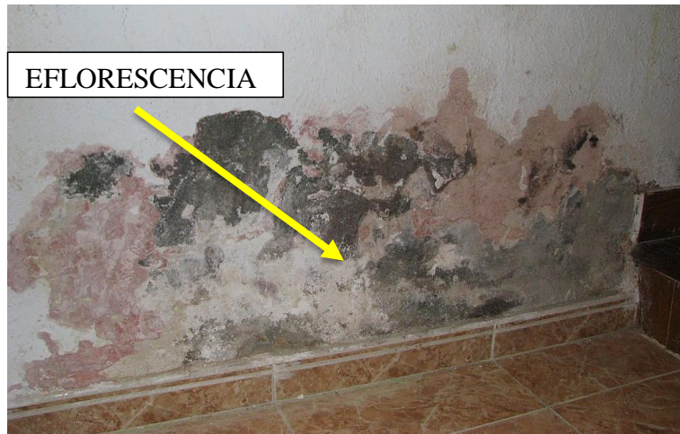
Gráfico 21. Patología eflorescencia. Fuente. Construcciones y reparaciones (2017).
