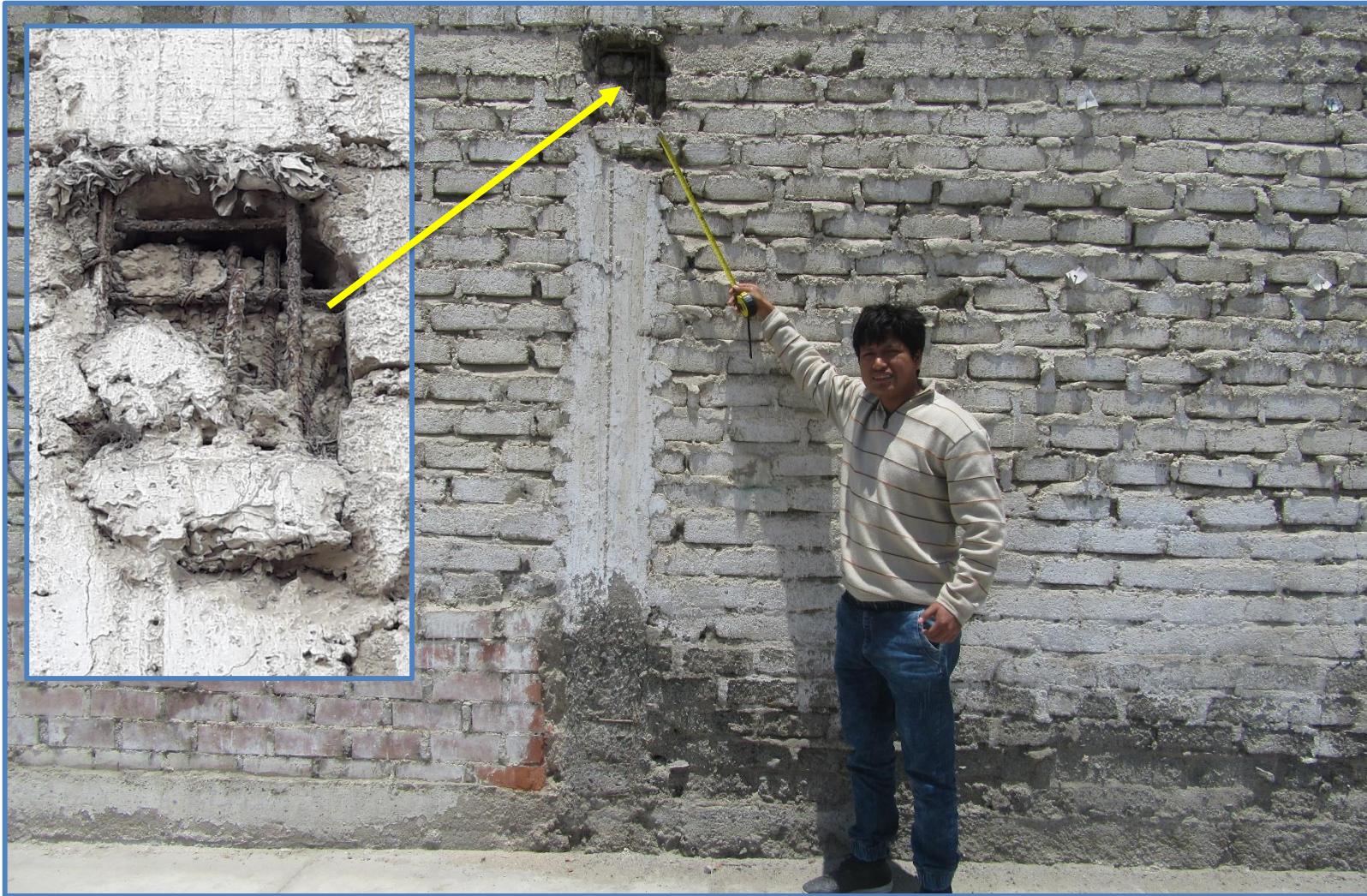
Fotografía 10: Se observa la patología corrosión, con nivel de daño medio y está localizado en la unidad de muestra 08.
