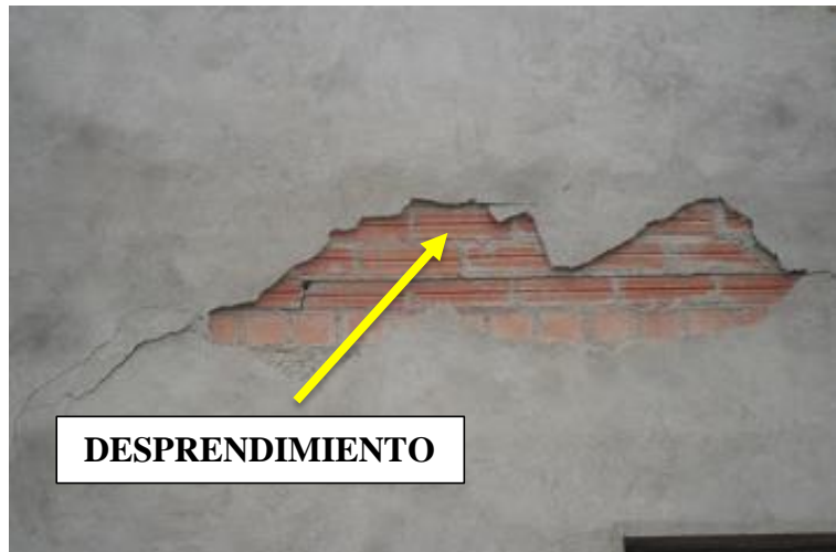
Gráfico 19. Patología desprendimiento. Fuente: Xavier Valderas (2017).
