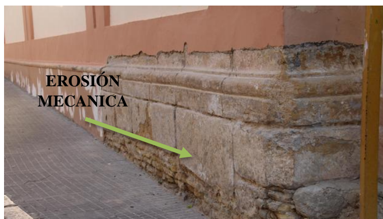
Gráfico 20. Patología erosión mecánica.
