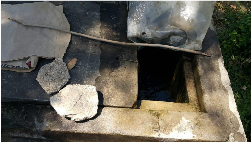
Vista de reservorio que se encuentra sin tapa sanitaria
