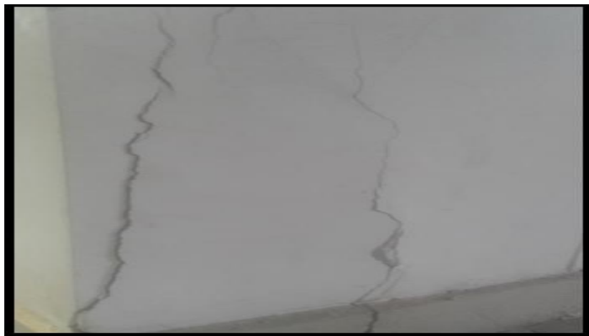
Gráfico 7: falla mecánica en muro.
