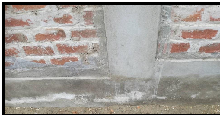
Gráfico 8: Eflorescencia en un muro de Albañilería.
