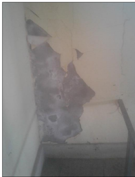
Gráfico 70: Presencia de humedad.
