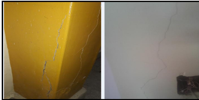
Gráfico 6: patología por agrietamiento.
