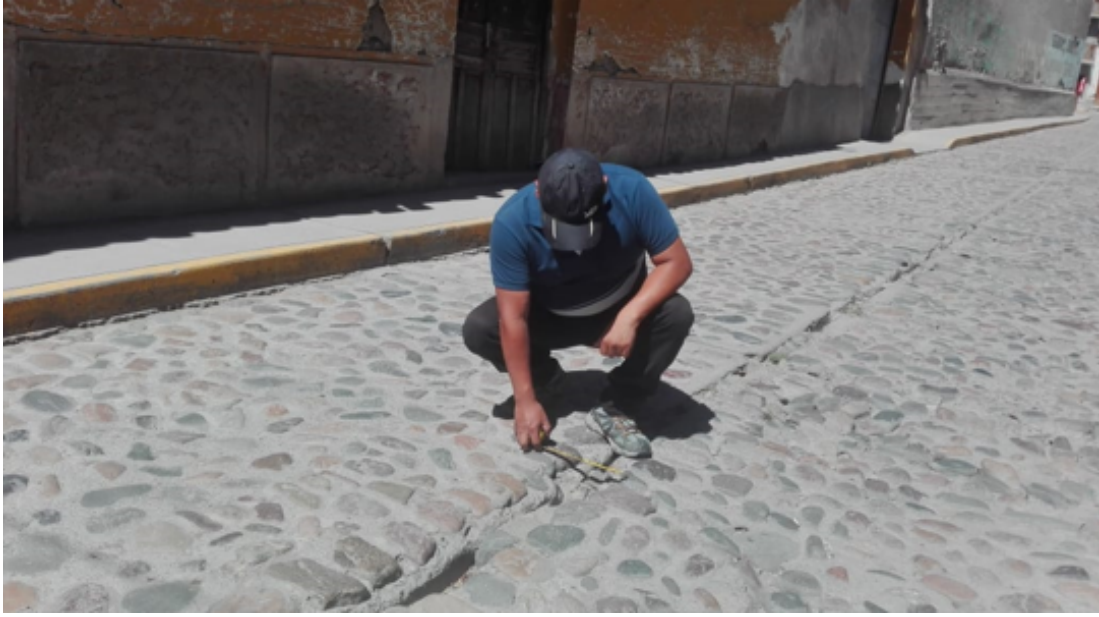
Fotografía 1: Fotografía de la patología hallada.
