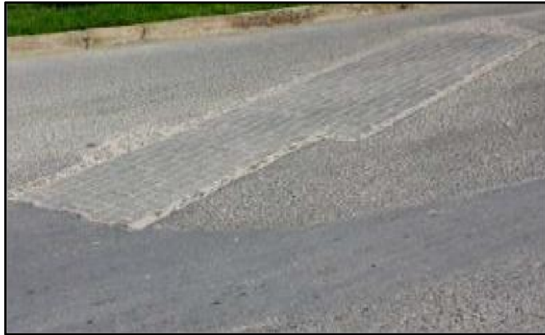
Figura 2.15: Patología por parcheo.
