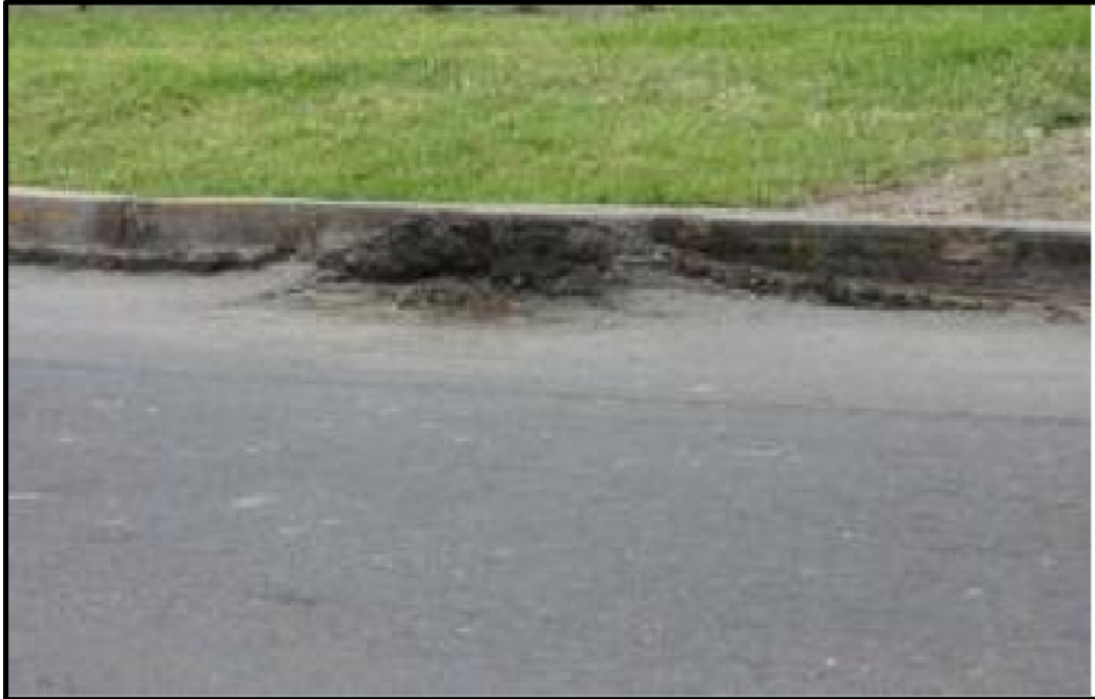
Figura 2.22: Patología por hinchamiento.
