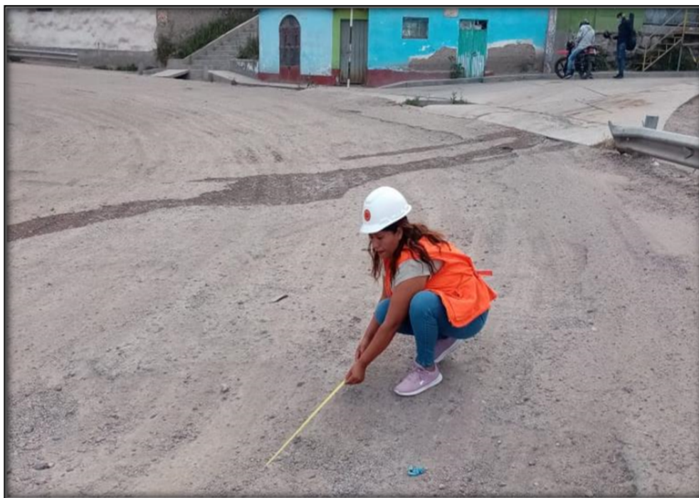
Fotografía 3: Falla tipo desprendimiento de los agregados encontrado en el Km 00+610 de la carretera Emp. Pe-3s (Ayacucho)-Socos.
