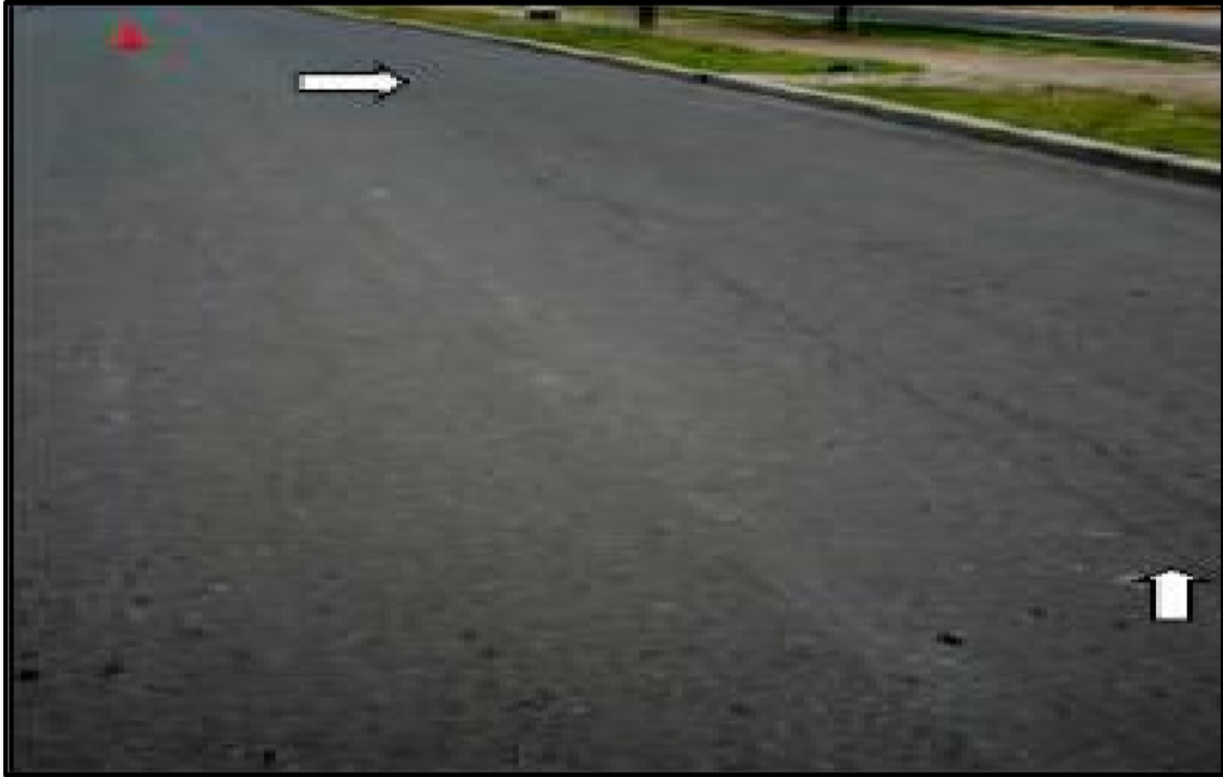
Figura 2.19: Patología por ahuellamiento.
