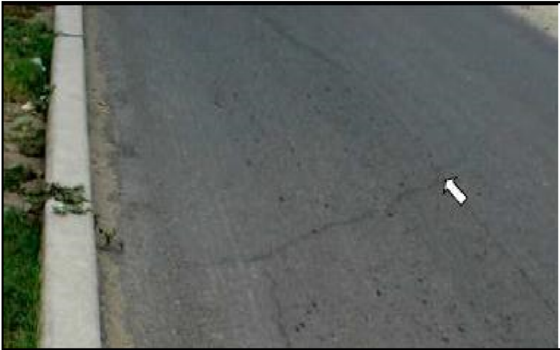
Figura 2.21: Patología por Grieta parabólica.
