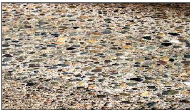
Figura 2.16: Patología por pulimento de agregados.
