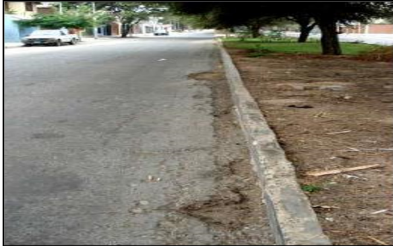
Figura 2.11: Patología por grieta de borde.
