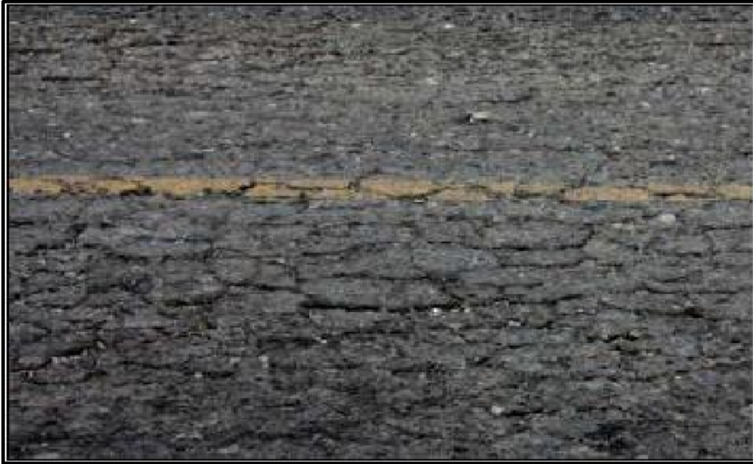
Figura 2.5: Patología piel de cocodrilo.
