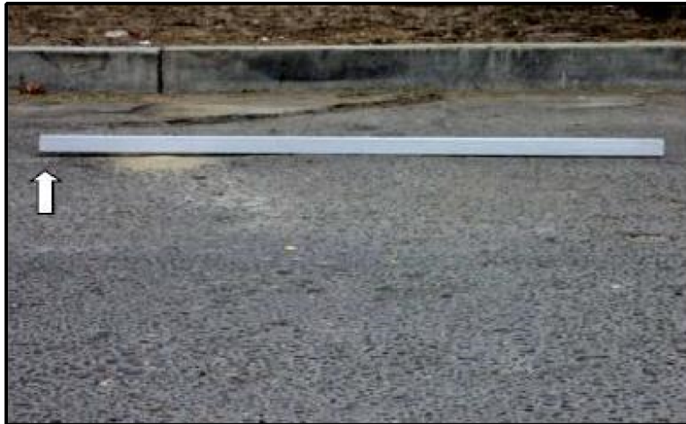
Figura 2.8: Patología por abultamiento y hundimiento.
