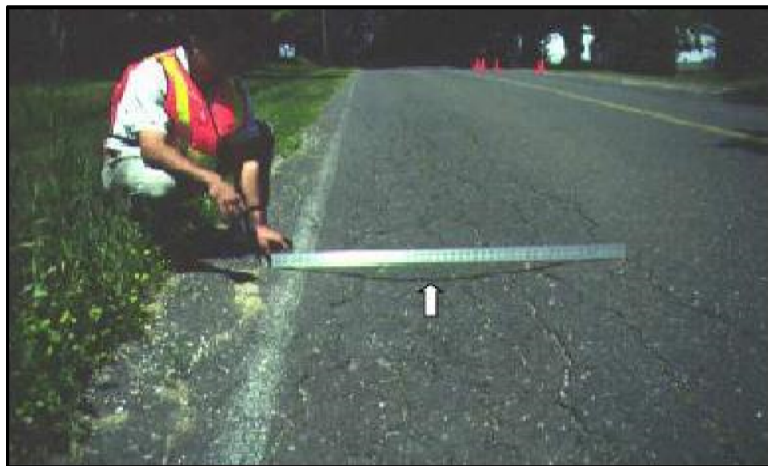
Figura 2.10: Patología por depresión.
