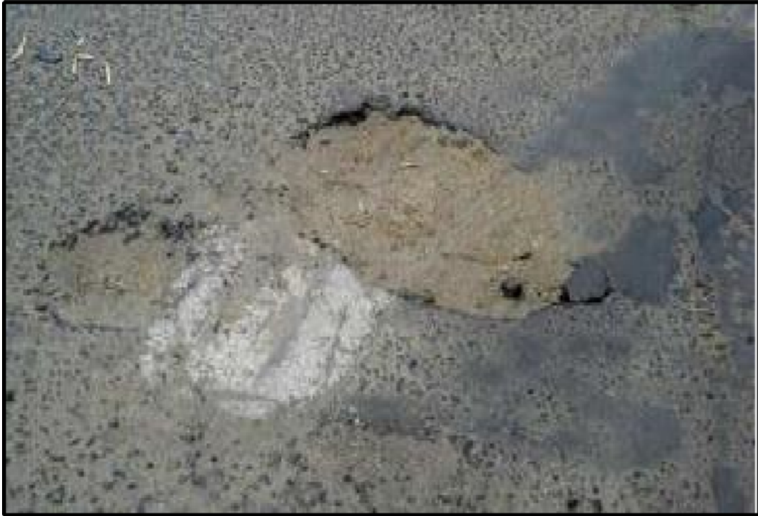
Figura 2.17: Patología por baches. Fuente: (Luis Vásquez, (2002)).
