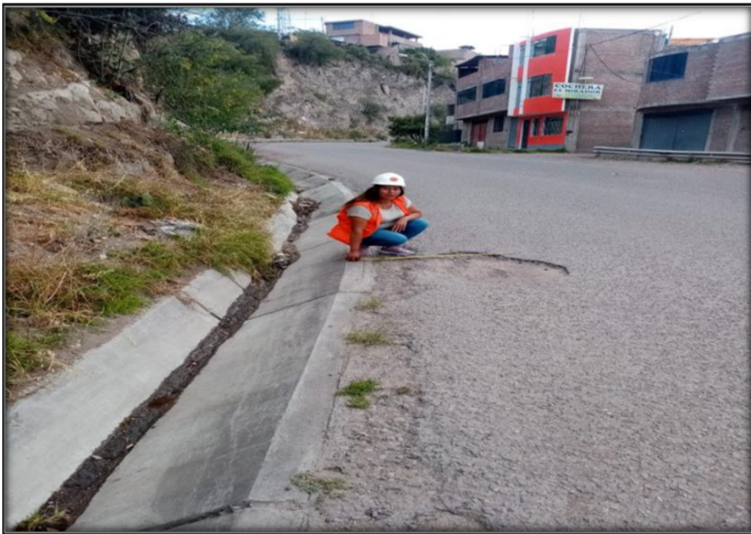
Fotografía 6: Falla tipo baches encontrado en el Km 001+350 la carretera Emp. Pe-3s (Ayacucho)-Socos.
