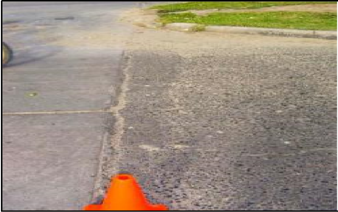
Figura 2.20: Patología por desplazamiento.
