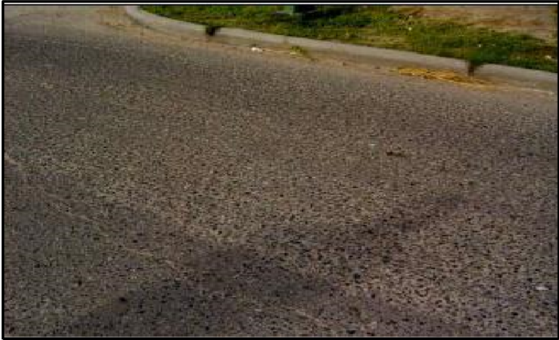
Figura 2.23: Patología por desprendimiento de agregados.
