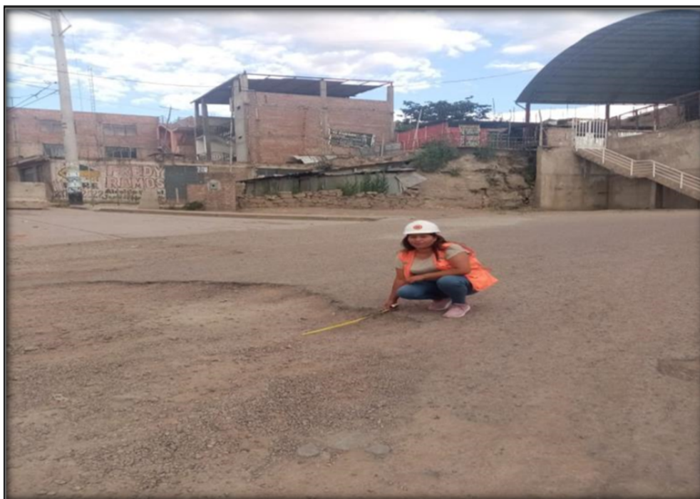
Fotografía 1: Falla tipo baches encontrado en el Km 00+514 de la carretera Emp. Pe-3s (Ayacucho)-Socos.
