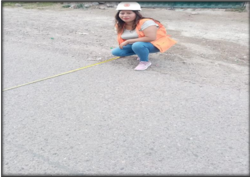
Fotografía 5: Falla tipo pulimiento de los agregados encontrado en el Km 000+890 de la carretera Emp. Pe-3s (Ayacucho)-Socos.
