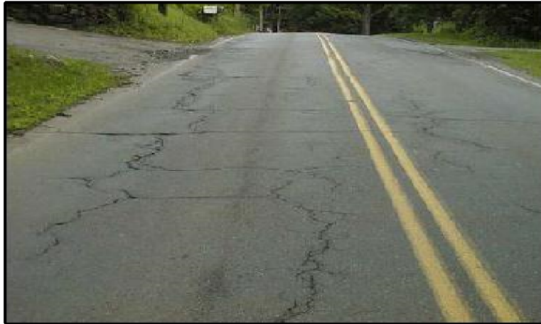
Figura 2.7: Patología por agrietamiento en bloque.
