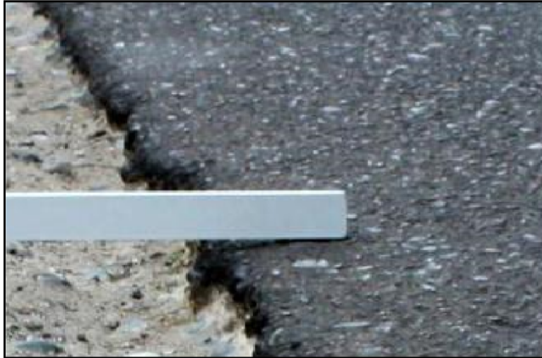
Figura 2.13: Patología por desnivel carril-berma.
