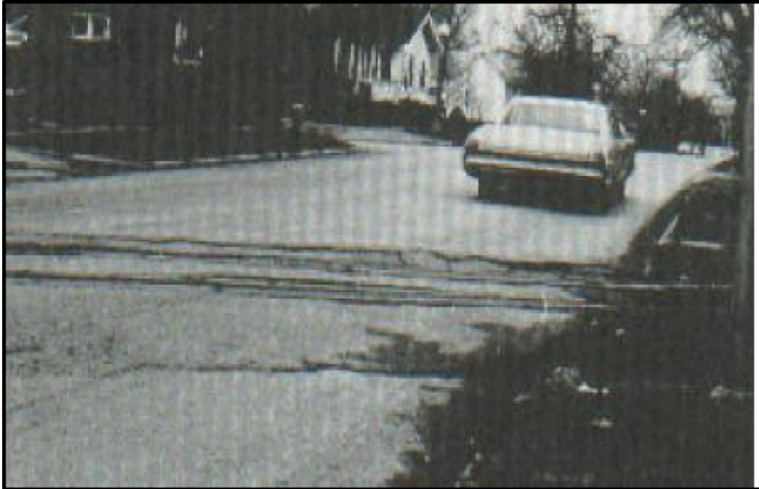
Figura 2.18: Patología por cruce de vía férrea.
