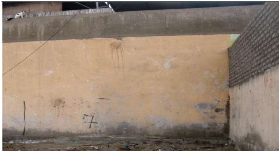
Imagen 5: Fotografía de la Unidad de Muestra 1, Muro con Patologías Fuente: Tesis en mención
