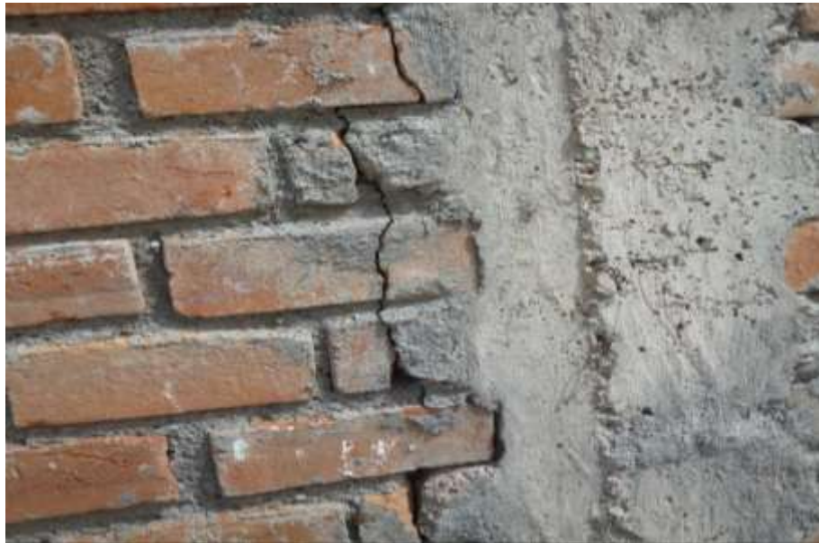
Imagen 8: Muro confinado con Presencia de Patologías Fuente: Tesis en mención
