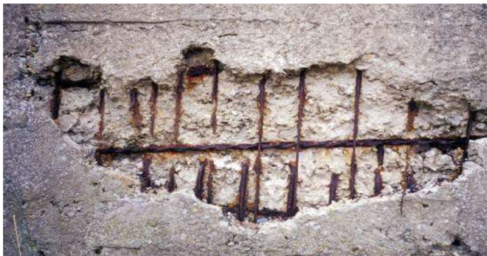
Imagen 4: Corrosión del Acero Estructural Fuente: Tesis en mención
