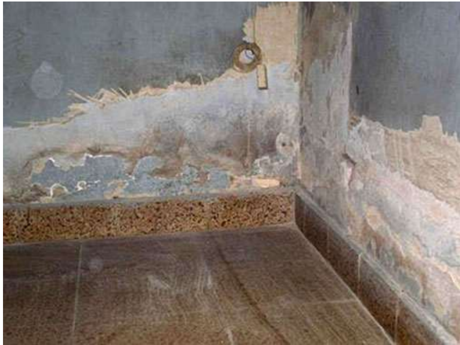
Imagen 2: Vivienda con patologías ocasionados por la humedad Fuente: Tesis en mención
