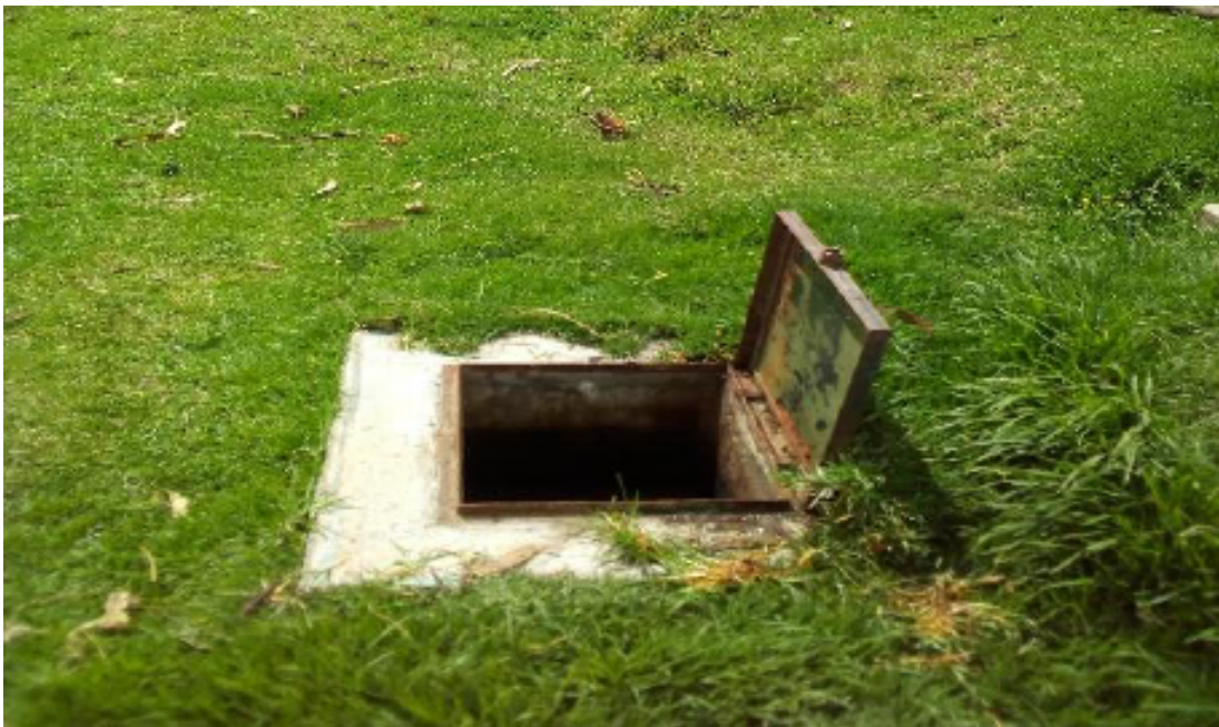
Figura 5.2: Caja de válvula de control existente.
