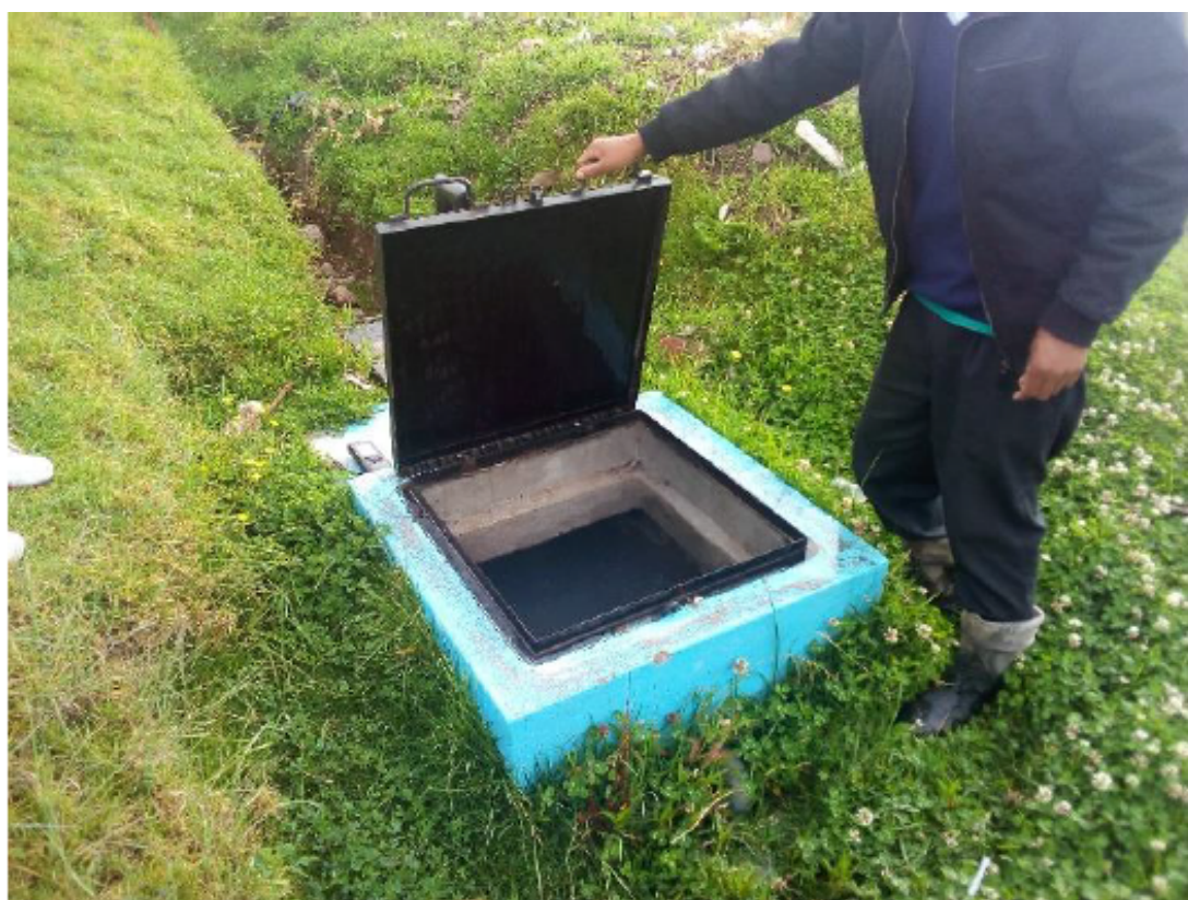
Figura 5.7: Cámara rompe presión.
