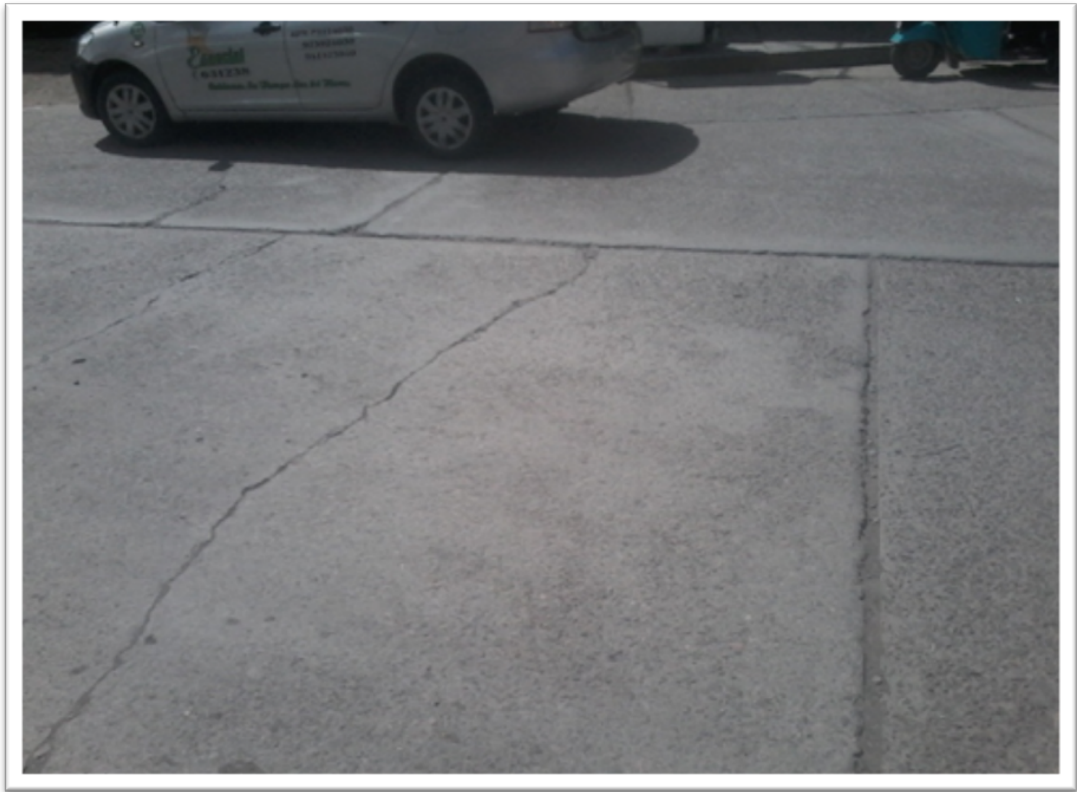
Fotografía 5: Patología de tipo losa dividida (8va cuadra).
