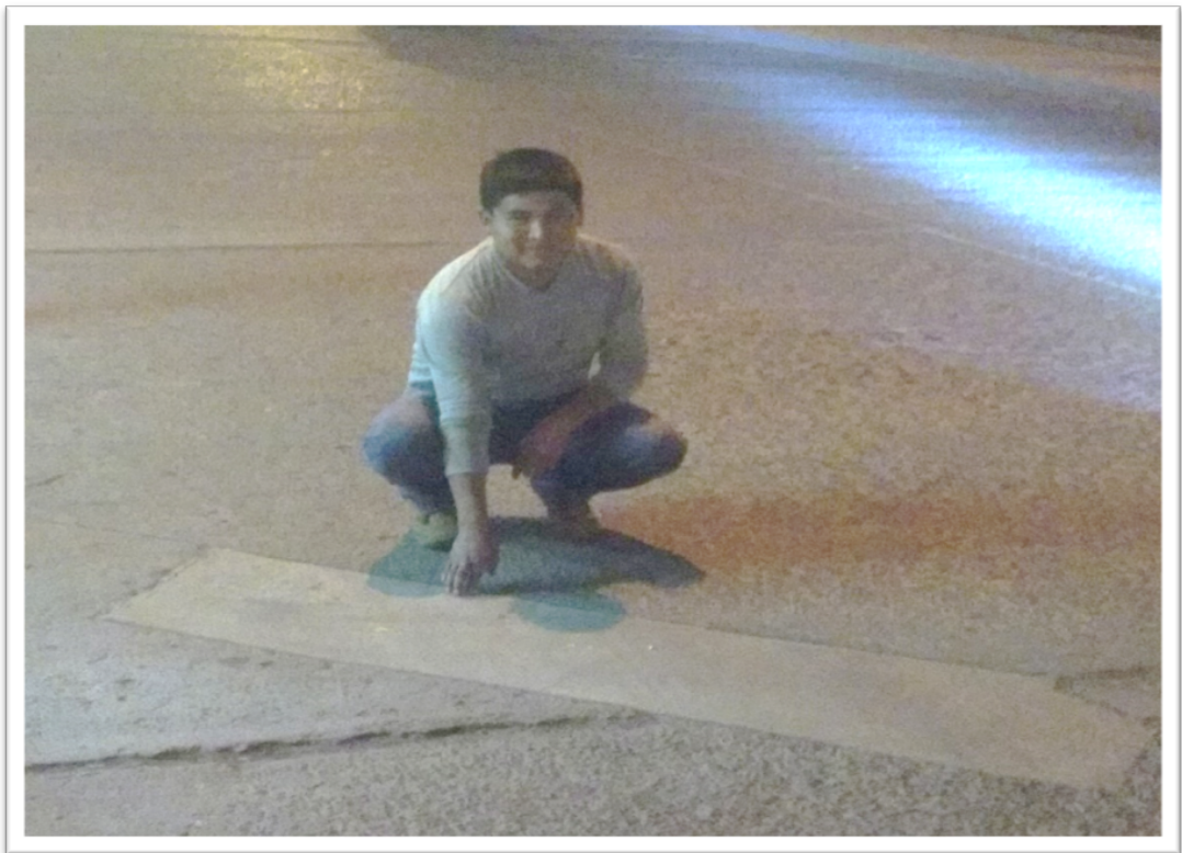
Fotografía 4: Patología del tipo parche (8va cuadra).
