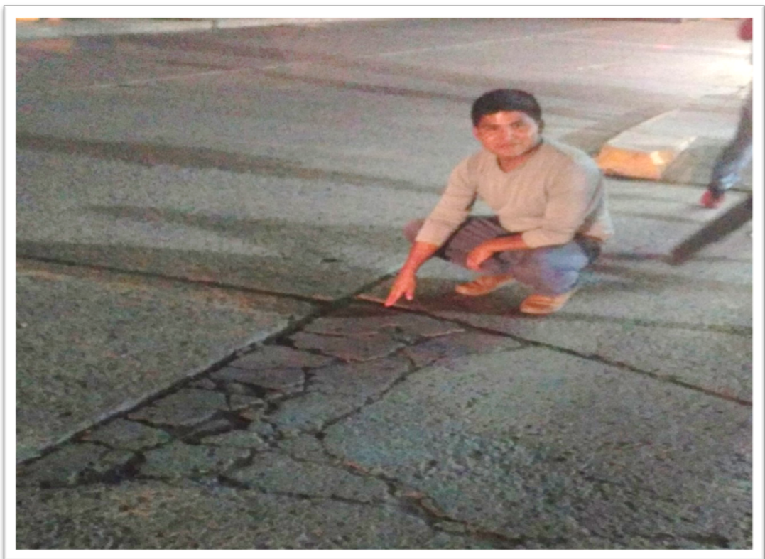
Fotografía 2: Patología tipo descascaramiento y descascaramiento de juntas (7ma cuadra).
