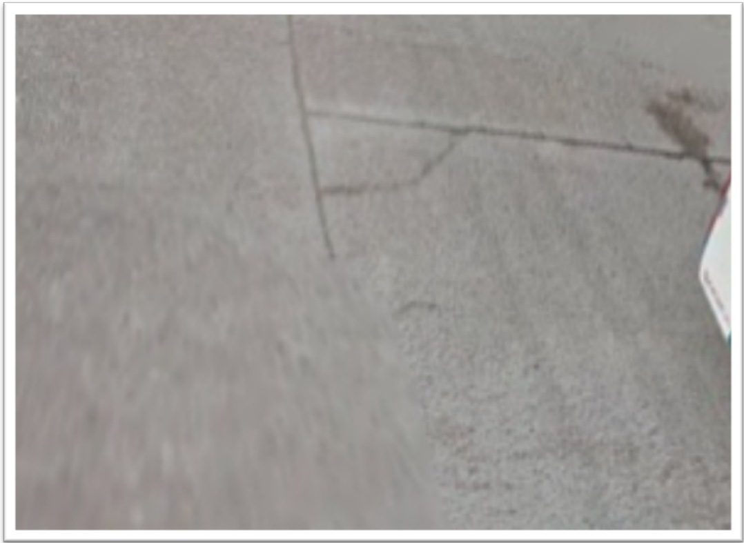
Fotografía 3: Patología de tipo grietas de esquinas (7ta cuadra).
