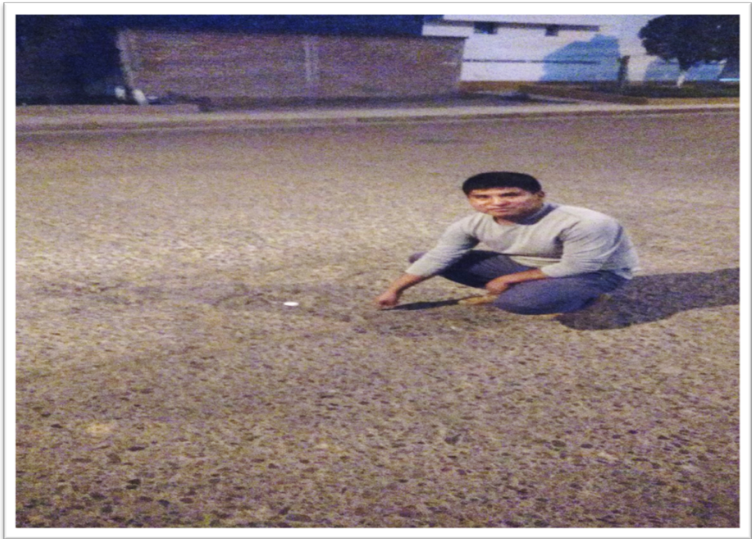
Fotografía 1: Patología tipo pulimento del agregado (6ta cuadra).
