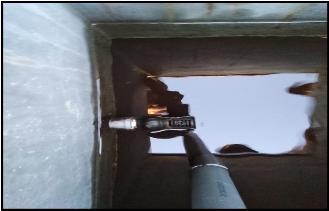
Imagen 18: Canastilla en la cámara humedad, que impide el ingreso de elementos no propios del agua, para no obstruir la línea de conducción.
