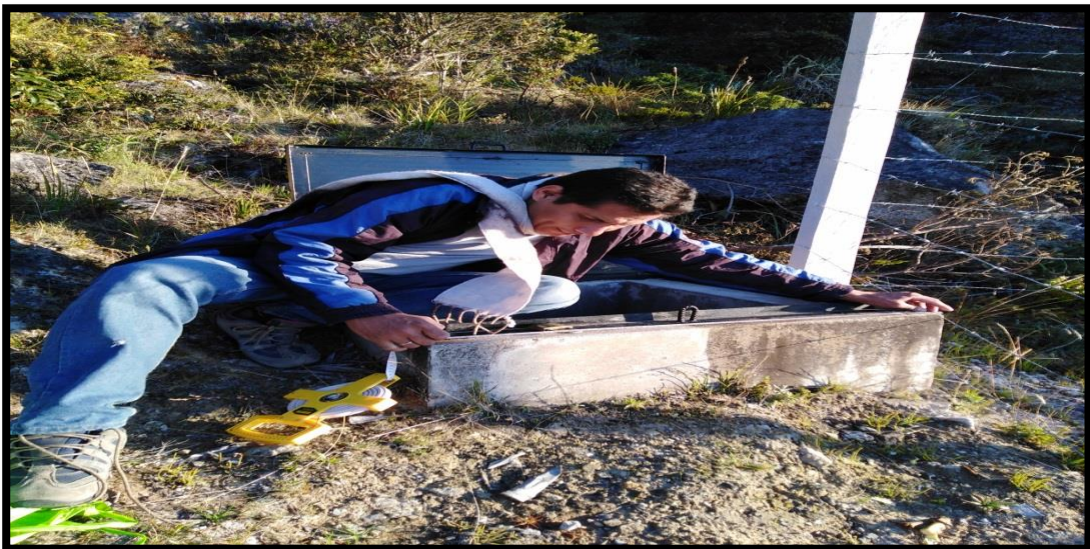
Imagen 13: Caja de concreto armado de la Válvula de control
