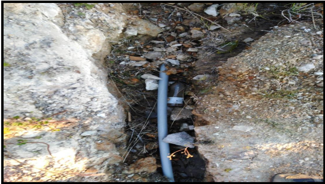
Imagen 12: Tubería expuesta de la línea de conducción
