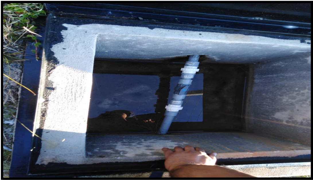
Imagen 14: Válvula de Control
