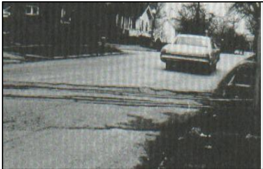
Imagen N° 18: Patología por cruce de vía férrea.
