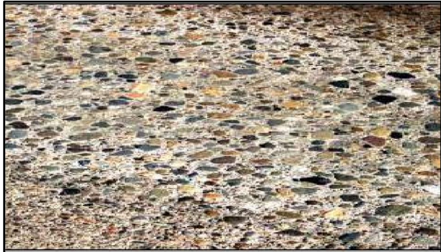
Imagen N° 16: Patología por pulimento de agregados Fuente: Rodríguez. E.- Cálculo del índice de condición del pavimento flexible en la av. Luis Montero, distrito de Castilla. (2009).
