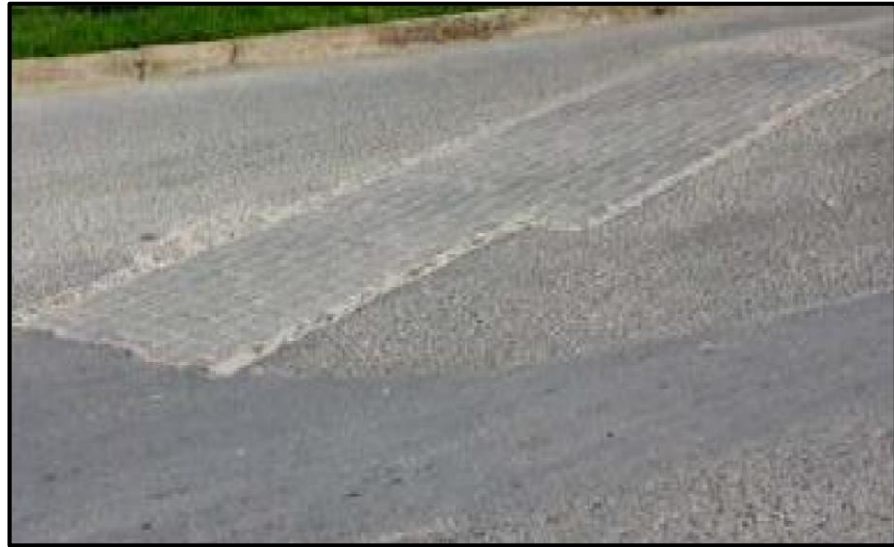
Imagen N° 15: Patología por parcheo
