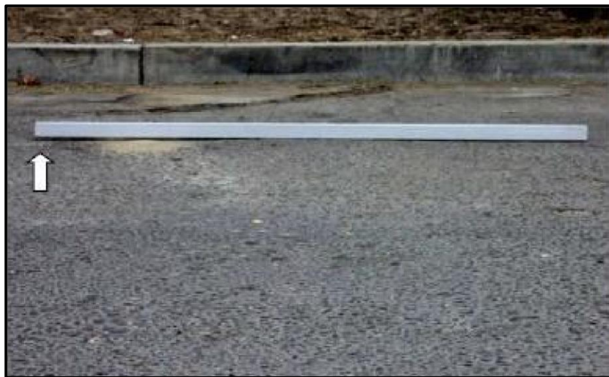
Imagen N° 8: Patología por abultamiento y hundimiento.
