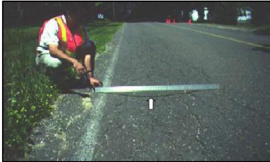
Imagen N° 10: Patología por depresión
