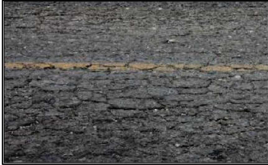
Imagen N° 5: Patología piel de cocodrilo.
