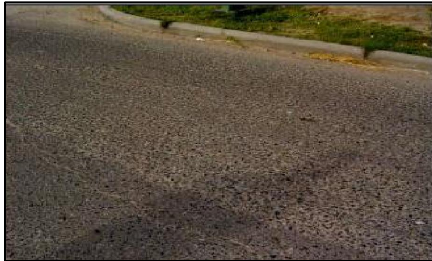
Imagen N° 23: Patología por desprendimiento de agregados. Fuente: Rodríguez. E.- Cálculo del índice de condición del pavimento flexible en la av. Luis Montero, distrito de Castilla. (2009).
