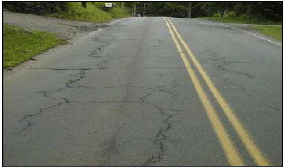
Imagen N° 7: Patología por agrietamiento en bloque.
