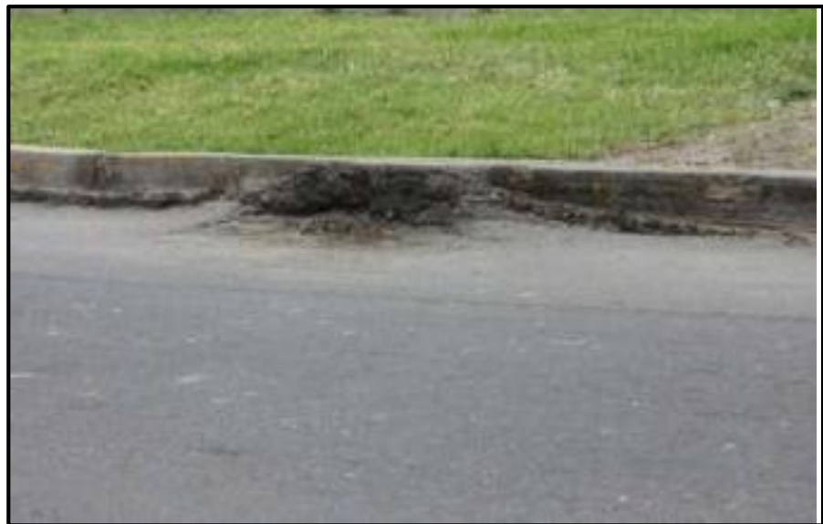
Imagen N° 22: Patología por hinchamiento Fuente: Rodríguez. E.- Cálculo del índice de condición del pavimento flexible en la av. Luis Montero, distrito de Castilla. (2009).
