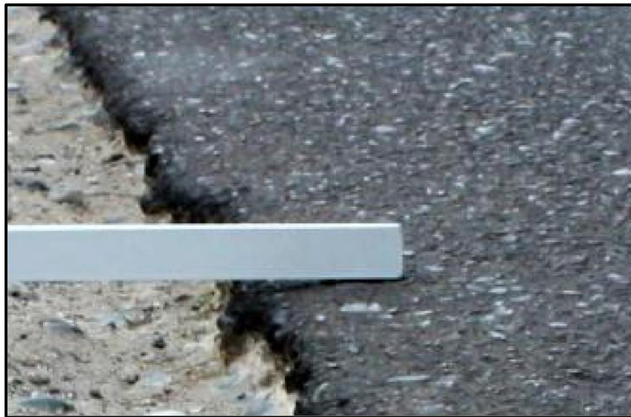
Imagen N° 13: Patología por desnivel carril-berma. Fuente: Rodríguez. E.- Cálculo del índice de condición del pavimento flexible en la av. Luis Montero, distrito de Castilla. (2009).
