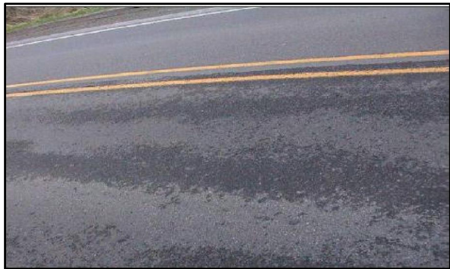
Imagen N° 6: Patología por exudación.
