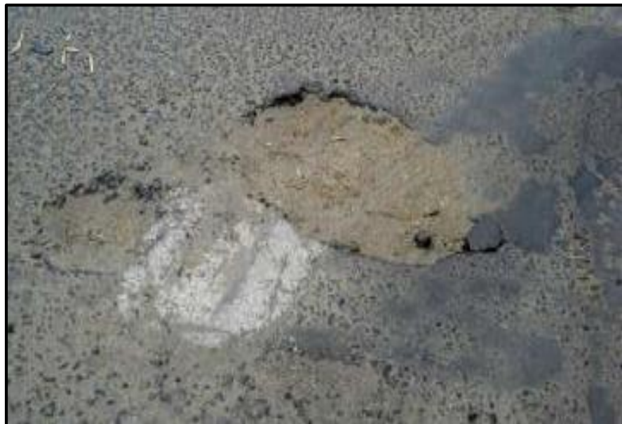
Imagen N° 17: Patología por baches.
