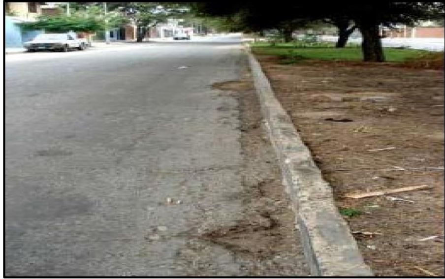
Imagen N° 11: Patología por grieta de borde.
