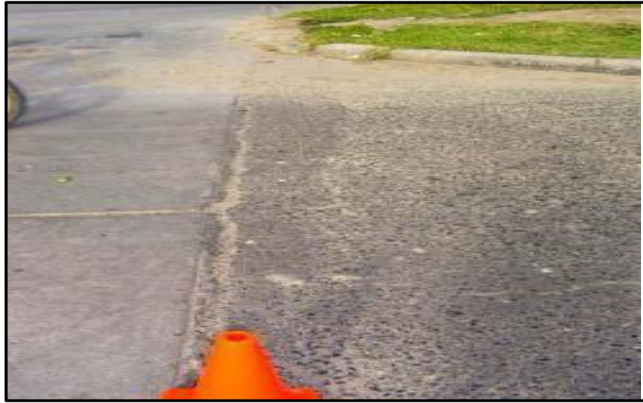
Imagen N° 20: Patología por desplazamiento Fuente: Rodríguez. E.- Cálculo del índice de condición del pavimento flexible en la av. Luis Montero, distrito de Castilla. (2009).
