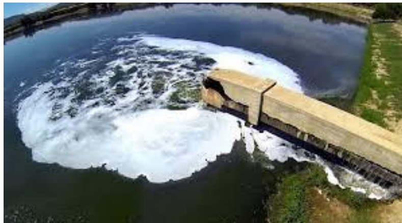
Imagen 2: laguna de oxidación.
