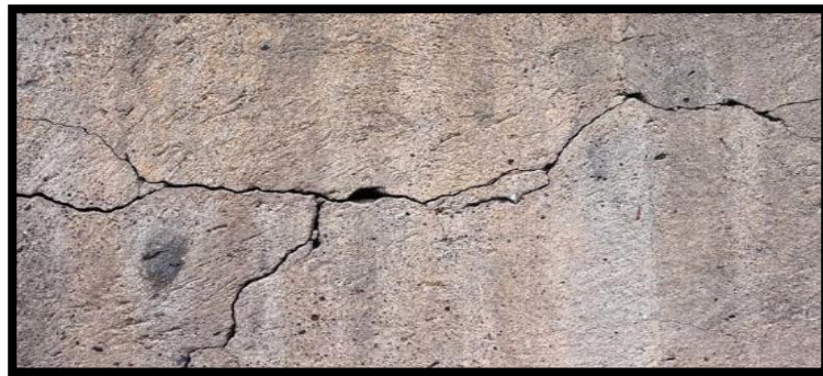
Gráfico 13: Grietas en muros Fuente: Vexlan (2017).
