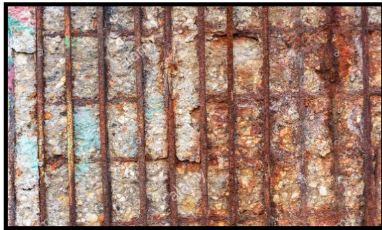
Gráfico 16: Corrosión en barras de acero Nota: Alamy (2019).
