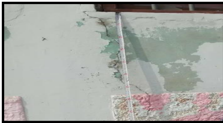
Gráfico 12: Fisura en muro Fuente: Elaboración propia (2018).
