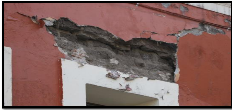
Gráfico 15: Desprendimiento en vigas por corrosión. Nota: SCJ Cuernavaca (2018)
