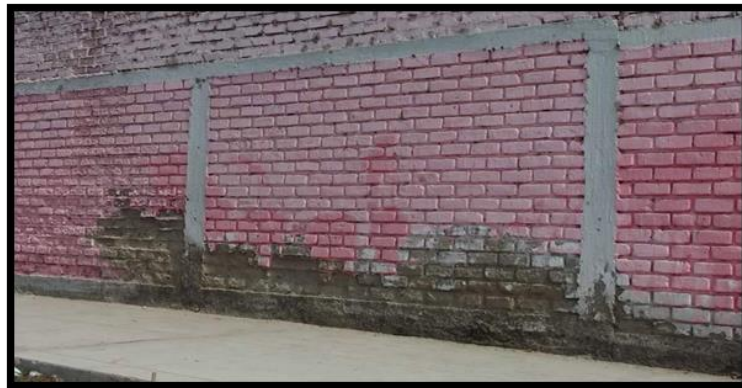
Gráfico 9: Erosión en muro de albañilería Fuente: Elaboración propia (2018)
