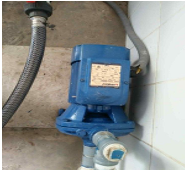
Imagen 7: Sistema de Bombeo existente.
