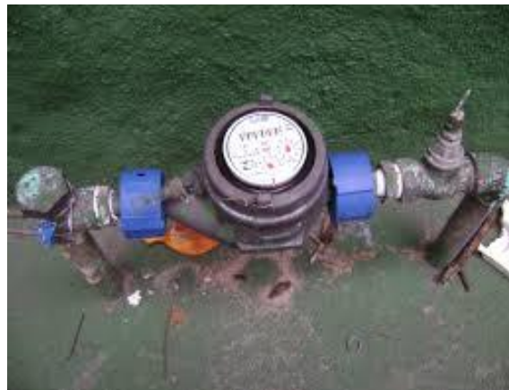
Figura 10: Medidor de consumo de agua domiciliario
