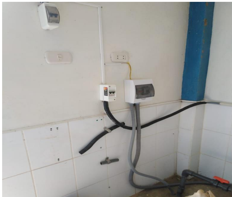
Imagen 8: Sistema de cableado Eléctrico.
