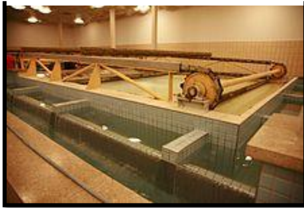
Figura 8: Planta de Tratamiento de agua.
