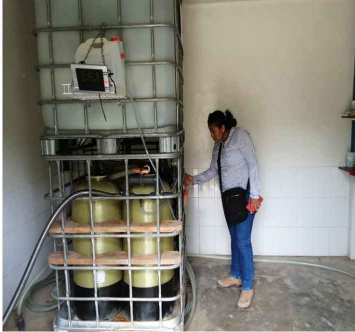
Imagen 2: Sistemas de filtros de agua existentes
