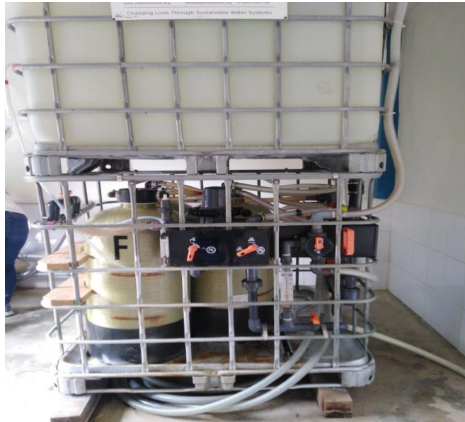
Imagen 9: Sistema de Filtrado de agua existente
