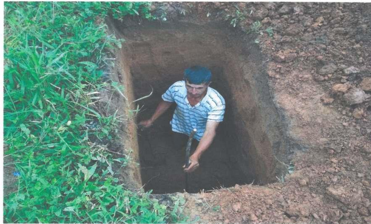
VISTA DE LA CALICATA N°26, H=2.00m – PREFILTRO DE LA PLANTA DE TRATAMIENTO DE AGUA POTABLE (PTAP)
