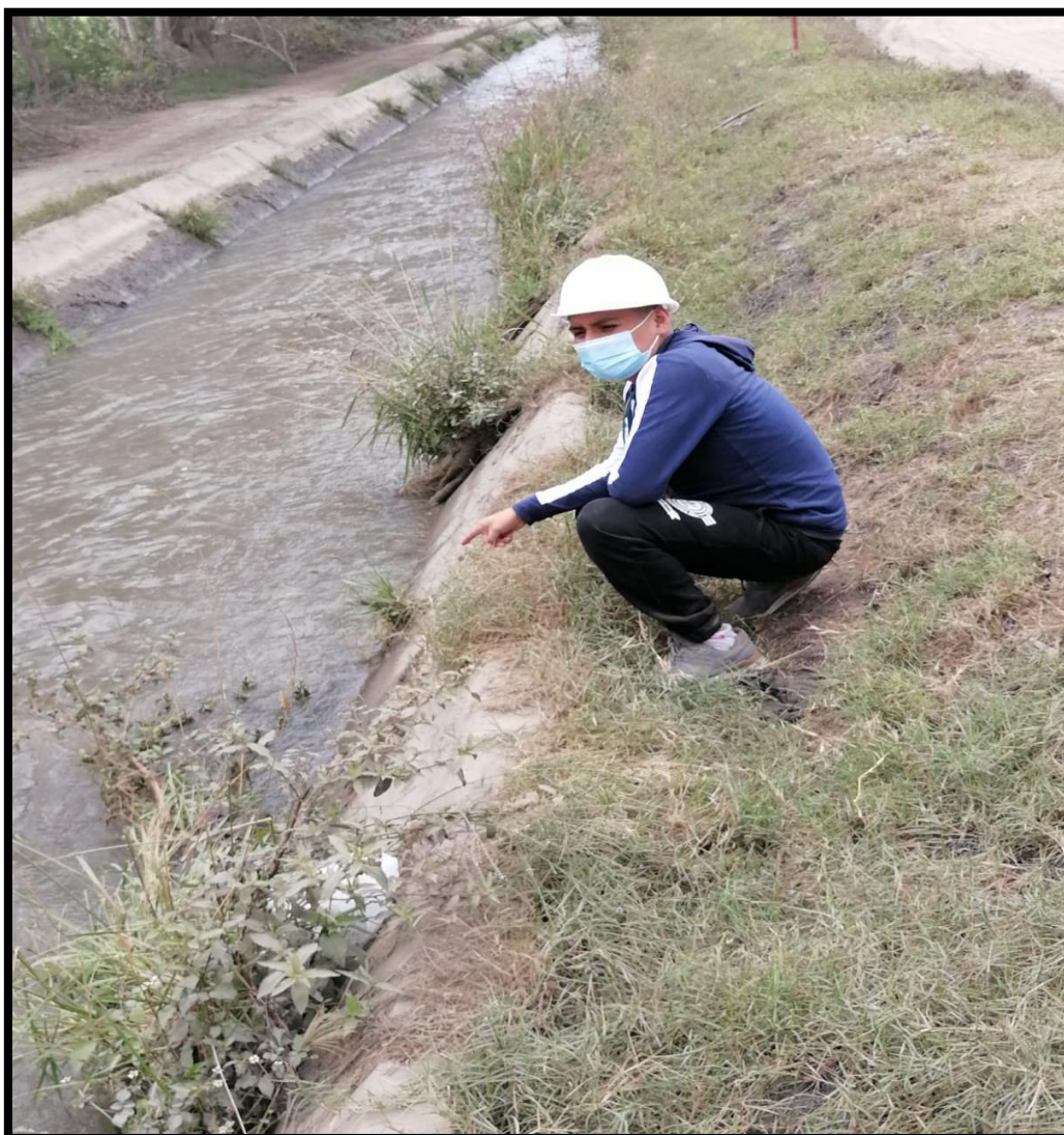
Figura 4: se observa falla de vegetación en el canal
