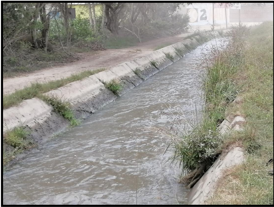
Figura 5: se observa falla de vegetación en el canal
