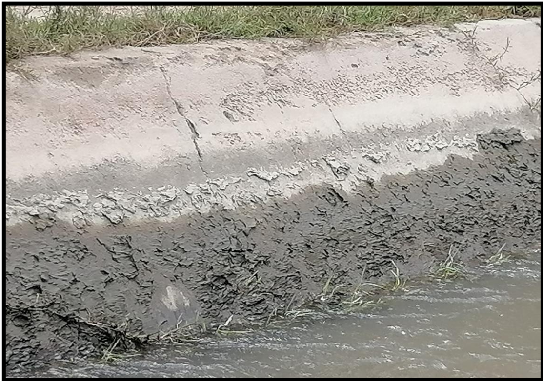
Figura 6: se observa falla de moho en el canal
