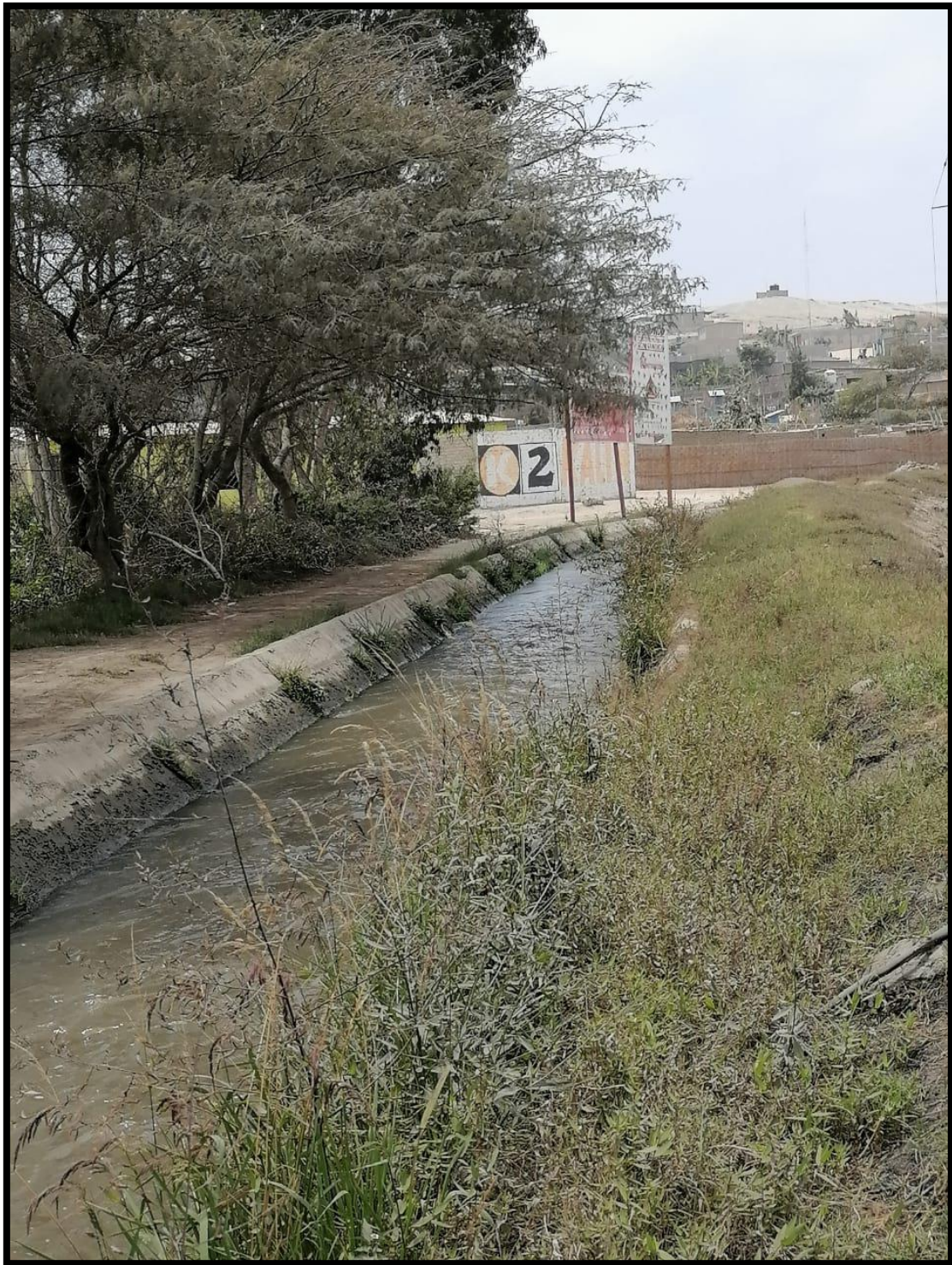
Figura 7: se observa falla de vegetación en el lado derecho del canal
