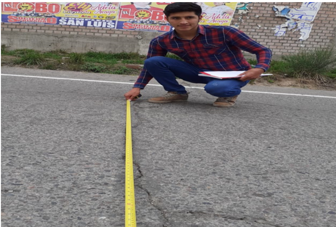
Fotografía 4: Grietas longitudinales y transversales km 326+500.
