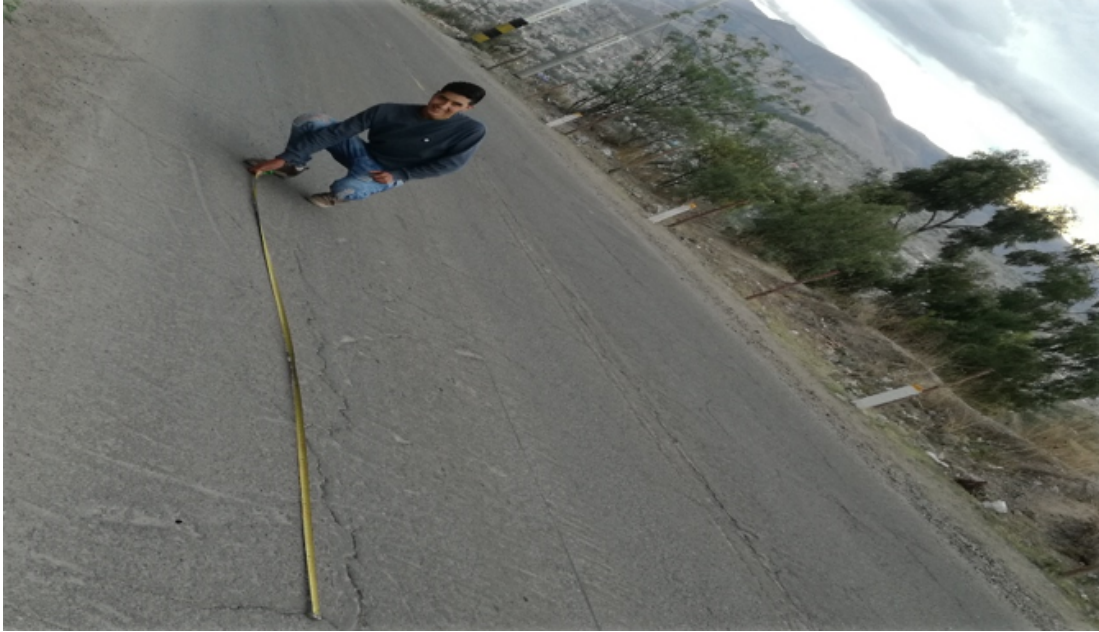
Fotografía 3: Grietas longitudinales y transversales.
