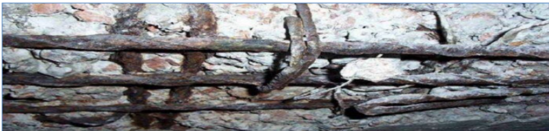
Figura 2.11: Corrosión de acero. Fuente:(Tomada desde (CivilGeeks2011))
