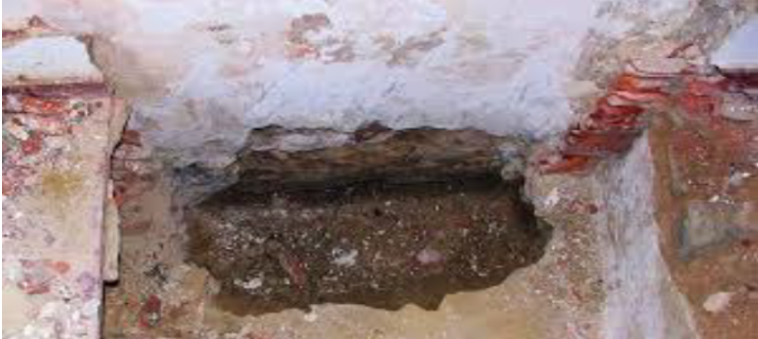
Figura 2.12: Humedad en construcción. Fuente: (Tomada desde (patologiasconstruccion2014))
