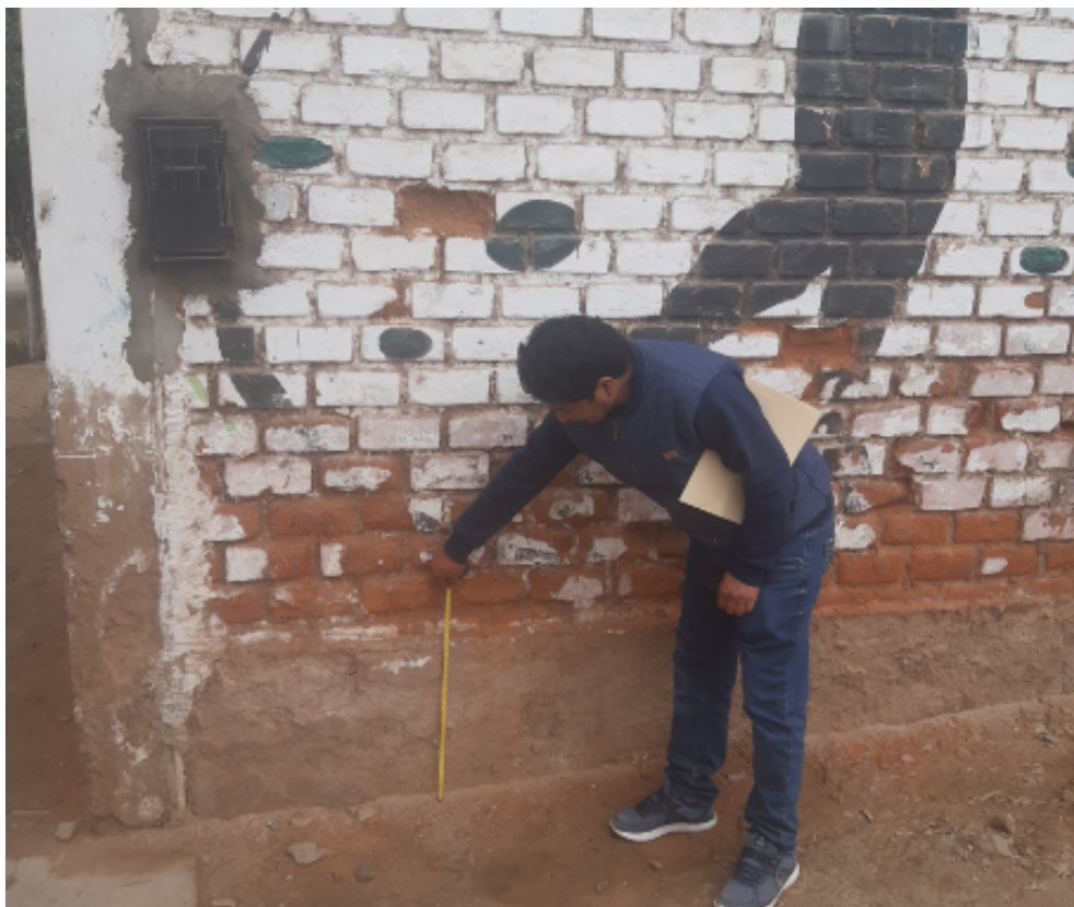
Fotografía 3: Patologías halladas en el muro calle Los Incas.
