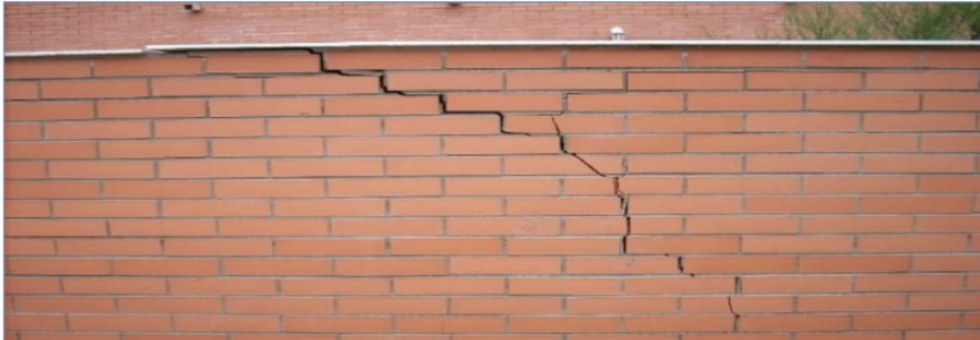
Figura 2.9: Grieta en muro.
