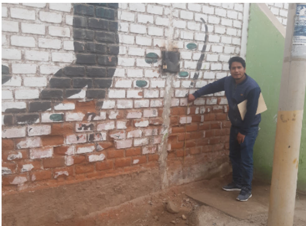
Fotografía 4: Patologías halladas en el muro calle Los Incas.
