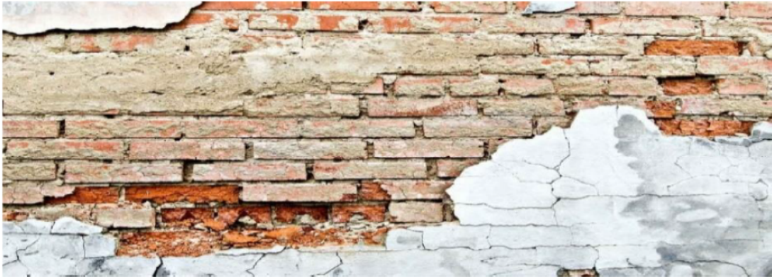
Figura 2.7: Erosión de muro. Fuente:(Tomada desde (Gutierrez 2017))
