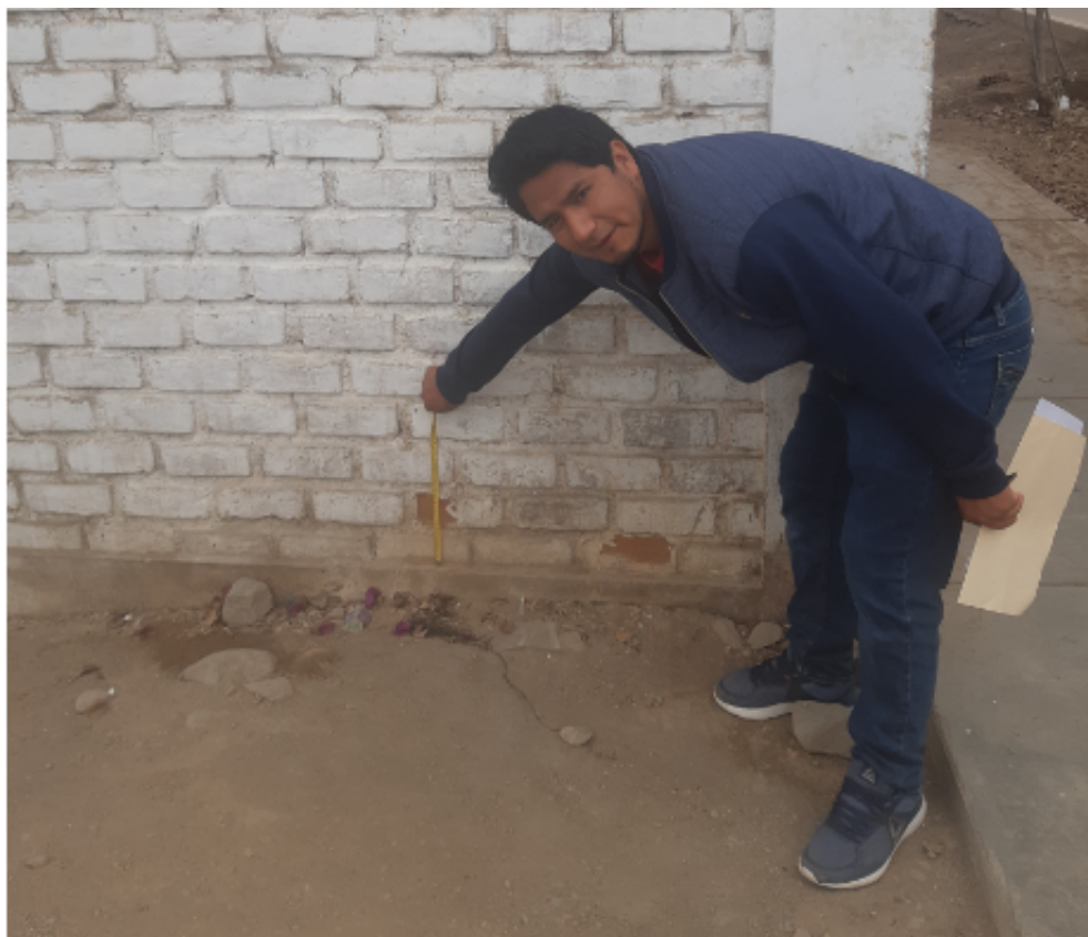
Fotografía 7: Patologías halladas en el muro calle Los Incas.
