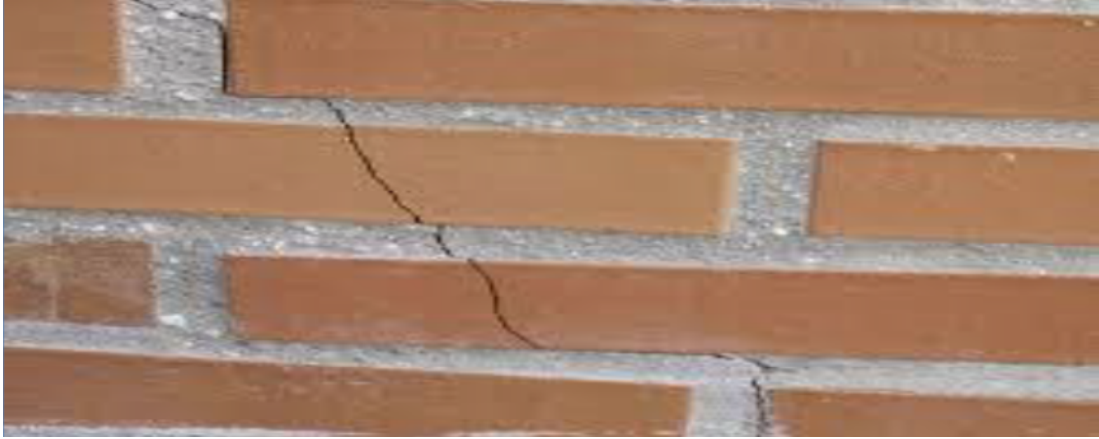
Figura 2.10: Fisura en muro. Fuente:(Tomada desde (sosclubertas2015))
