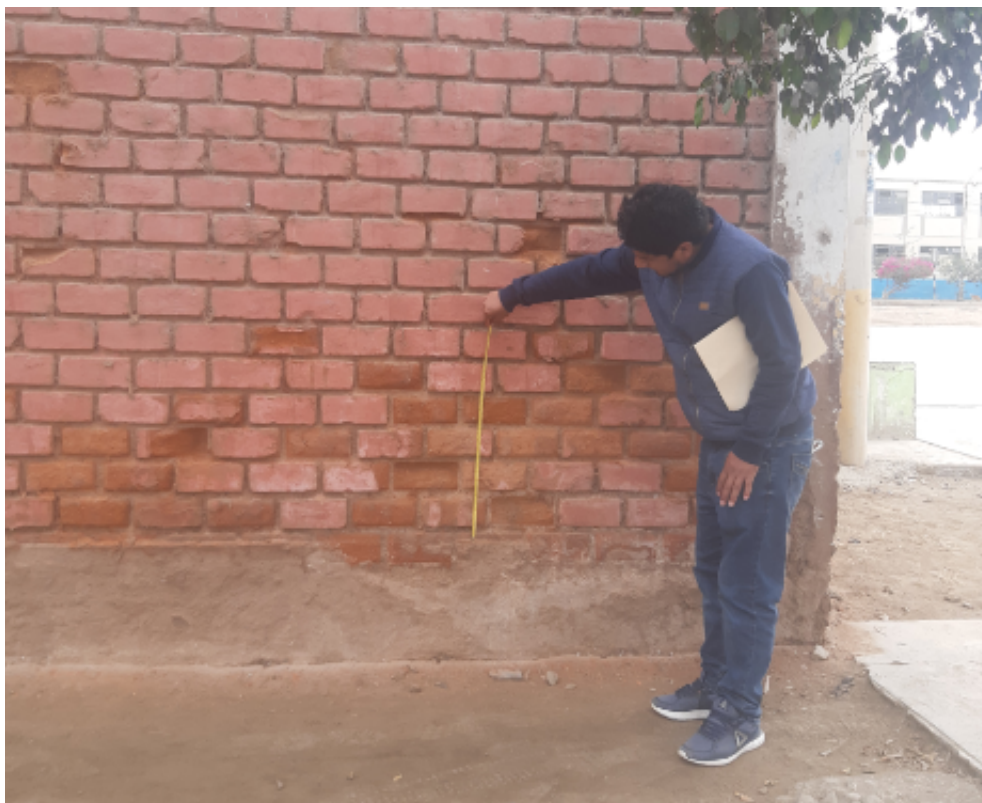
Fotografía 5: Patologías halladas en el muro calle Catilla.
