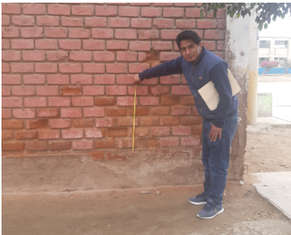
Fotografía 6: Patologías halladas en el muro calle Castilla.
