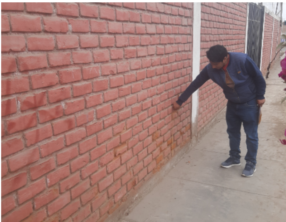
Fotografía 8: Patologías halladas en el muro calle Colon.
