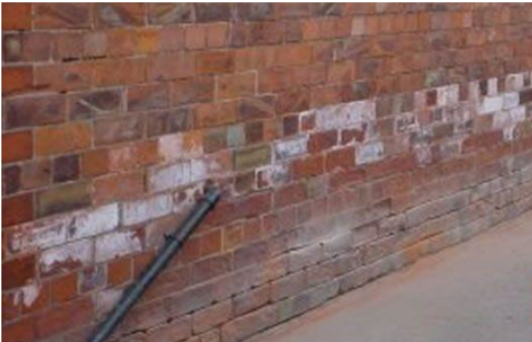
Figura 2.8: Eflorescencia en muro. Fuente:(Tomada desde (Gutierrez 2017).)
