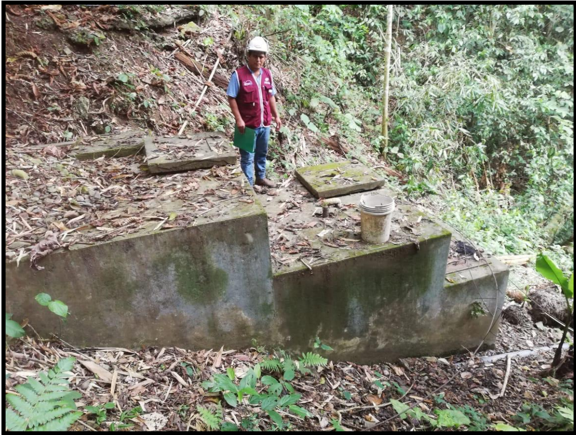
fotografía 1: captación existente no usada
