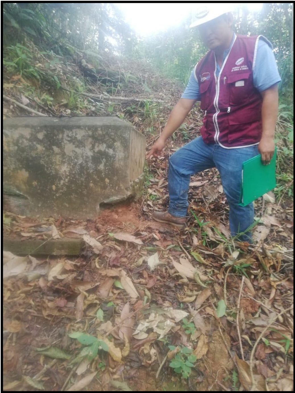
fotografía 3: daños en la estructura de una cámara rompe presión
