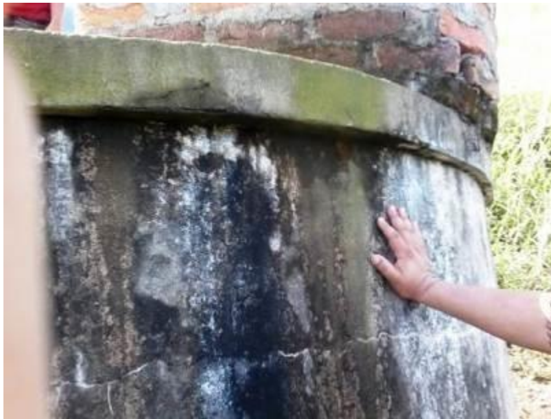
Tanque existente en mal estado de conservación
