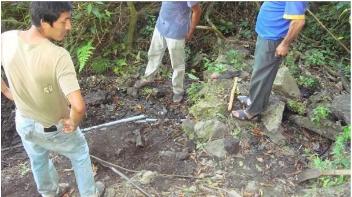
CONEXIÓN EN MAL ESTADO
