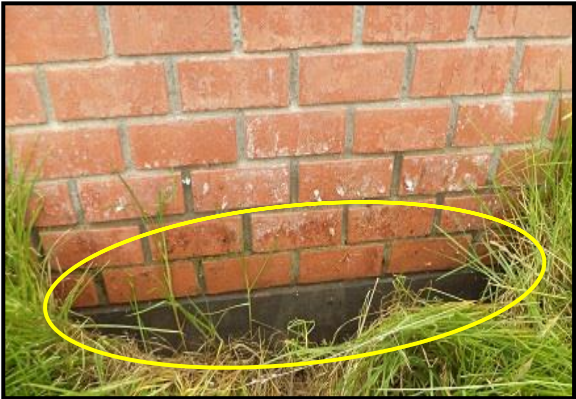
Foto 08: Vista panorámica de la Patología – Humedad
