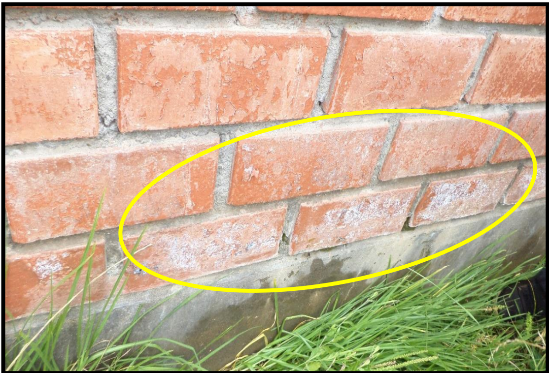
Foto 11: Vista panorámica de la Patología – Eflorescencia
