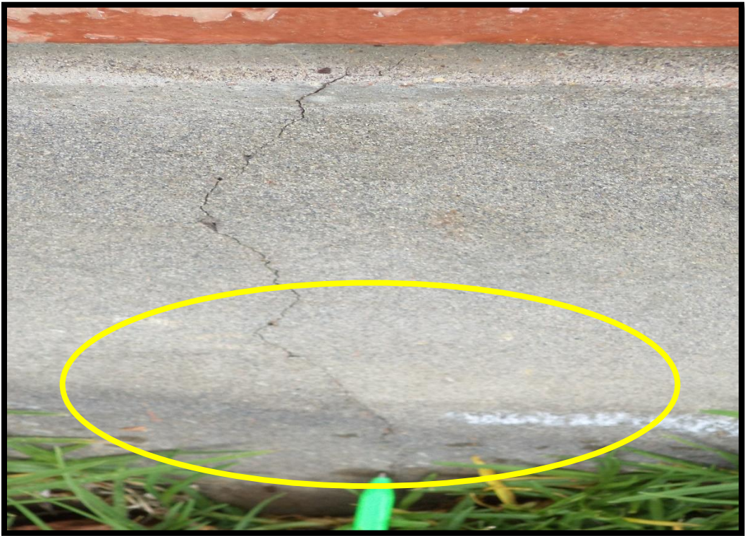
Foto 12: Vista panorámica de la Patología – Picadura
