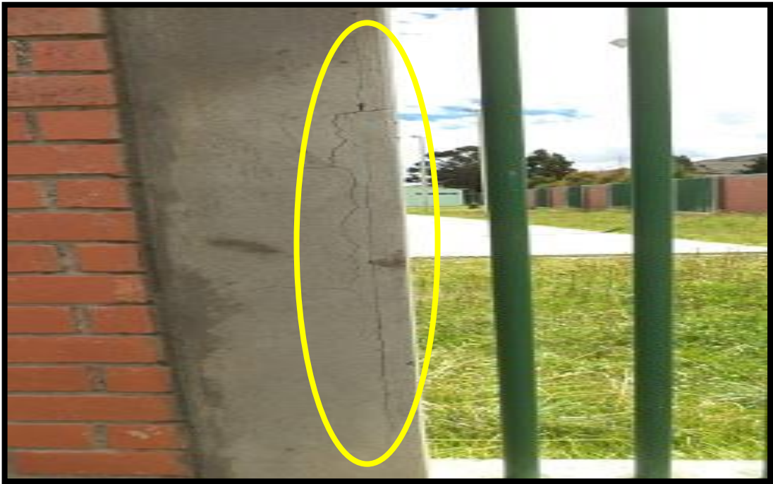
Foto 10: Vista panorámica de la Patología – Fisura
