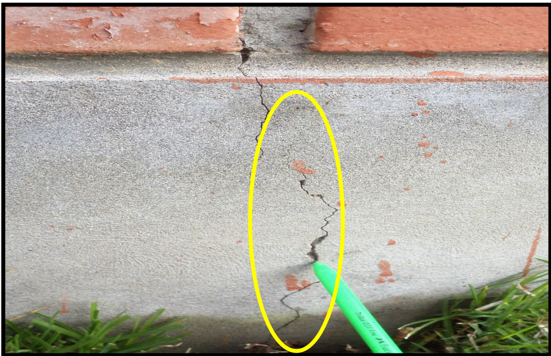
Foto 09: Vista panorámica de la Patología – Grieta
