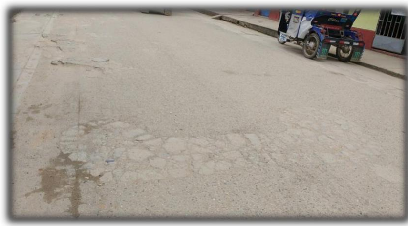
Figura 150. Parches de severidad alta (U-03)
