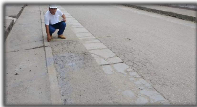
Figura 134. Piel de cocodrilo y parche, ambas de severidad alta (U-01)
