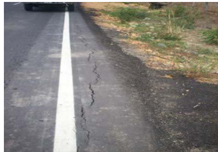
Figura 29. Falla de severidad media (grietas de borde)
