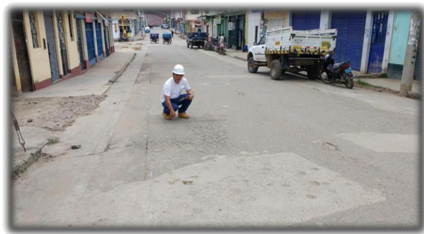
Figura 141. Piel de cocodrilo de severidad media (U-02)
