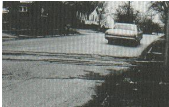
Figura 48. Falla de severidad alta (cruce vía férrea)
