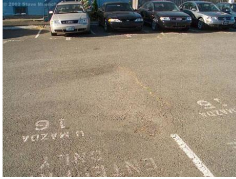
Figura 20. Falla de severidad media (abultamientos y hundimientos)
