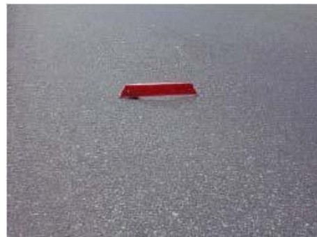
Figura 26. Falla de severidad media (depresión)
