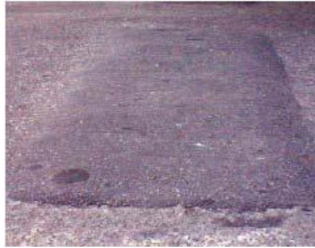
Figura 56. Falla de severidad baja (hinchamiento)
