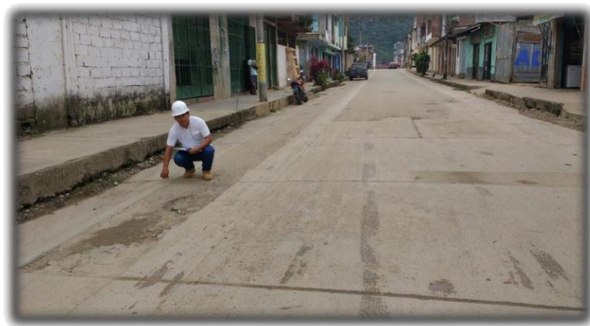
Figura 131. Huecos de severidad baja (U-01)
