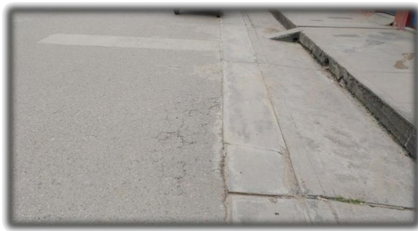
Figura 149. Grietas longitudinales y transversales de severidad media (U-03)
