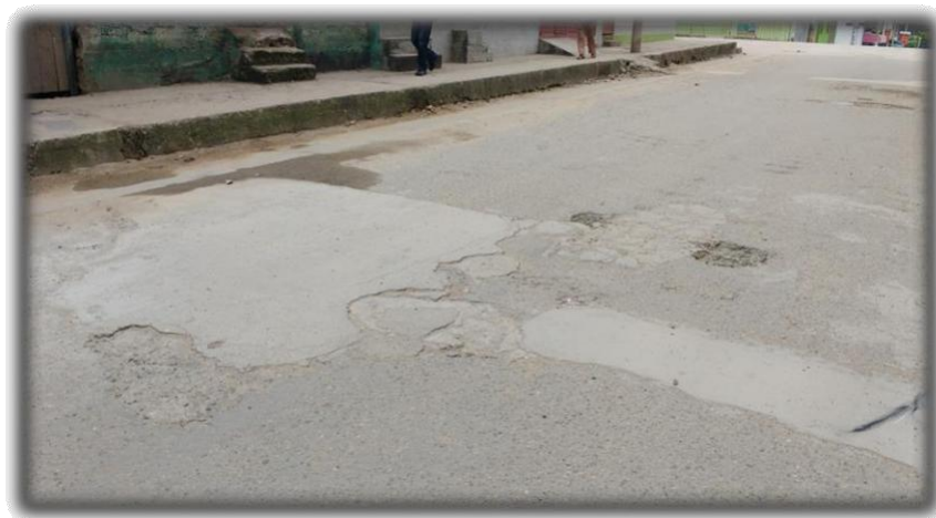
Figura 153. Parches de severidad alta (U-03)
