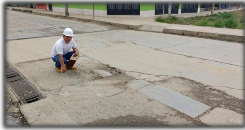
Figura 129. Abultamientos y hundimientos de severidad alta (U-01)
