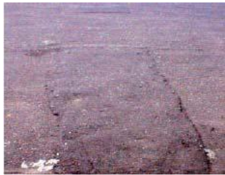
Figura 57. Falla de severidad media (hinchamiento)
