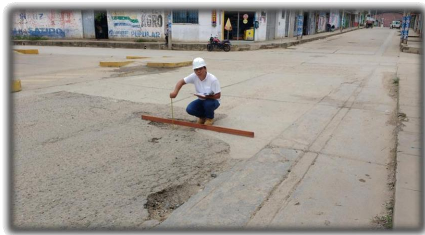
Figura 145. Huecos de severidad alta (U-02)
