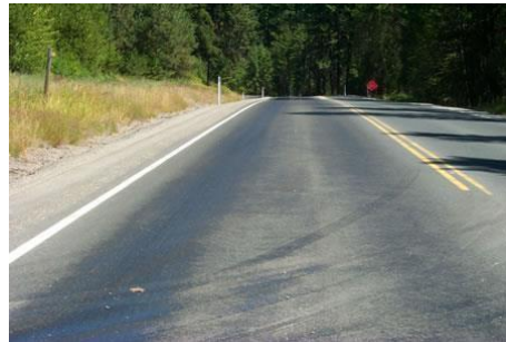
Figura 13. Falla de severidad baja (exudación)
