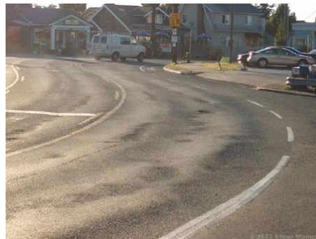
Figura 52. Falla de severidad baja (desplazamientos)
