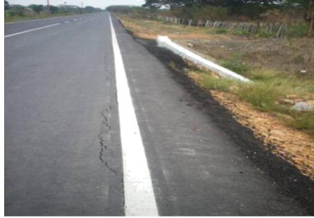
Figura 28. Falla de severidad baja (grietas de borde)
