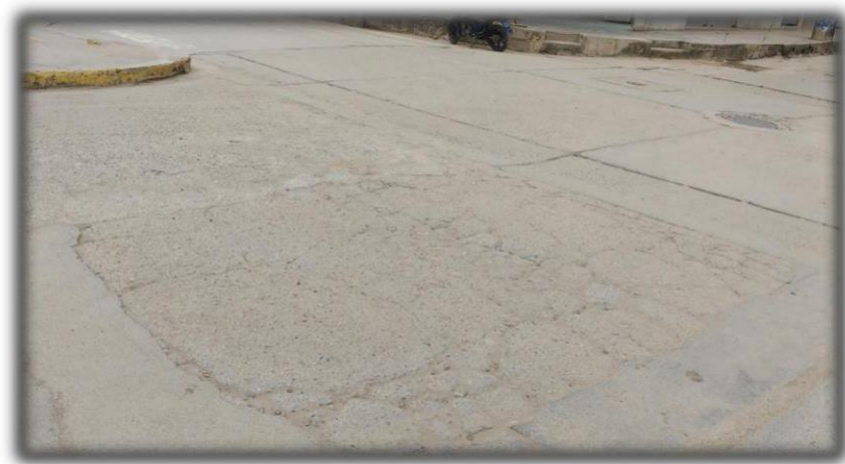
Figura 146. Piel de cocodrilo de severidad alta (U-02)
