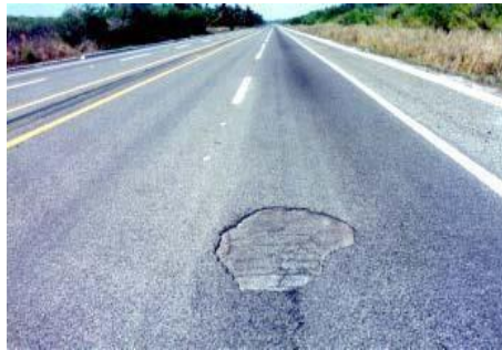
Figura 44. Falla de severidad media (huecos)
