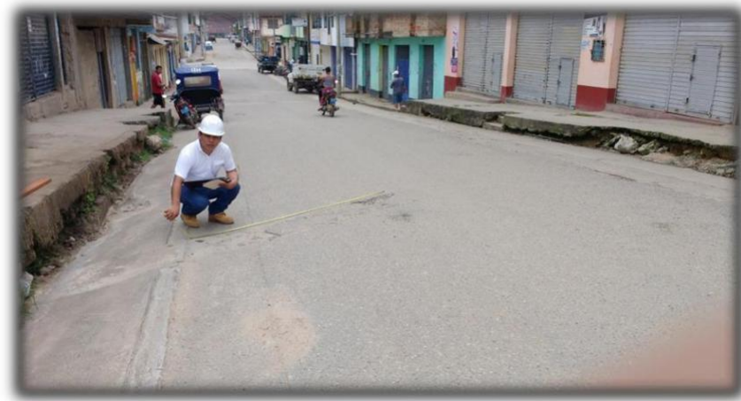
Figura 138. Parches de severidad media (U-02)
