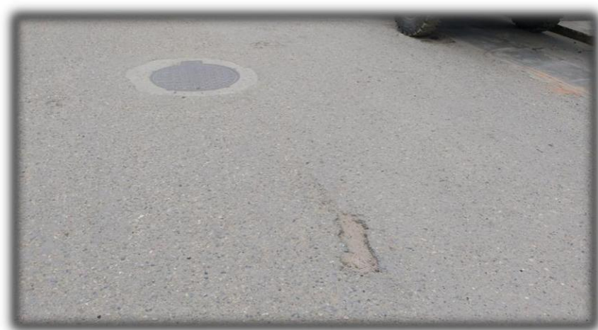
Figura 142. Huecos de severidad baja (U-02)
