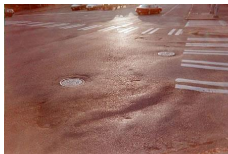
Figura 53. Falla de severidad media (desplazamientos)
