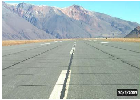
Figura 31. Falla de severidad baja (grietas)
