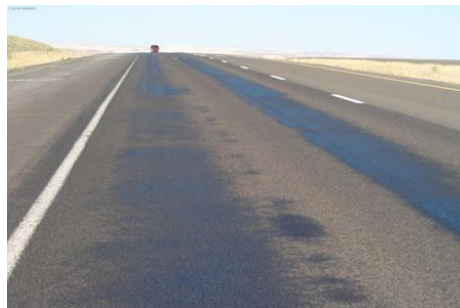
Figura 14. Falla de severidad media (exudación)
