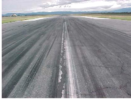
Figura 16. Falla de severidad baja (grietas en bloque)
