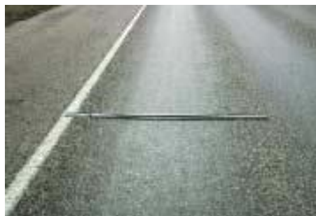
Figura 49. Falla de severidad baja (ahuellamiento)
