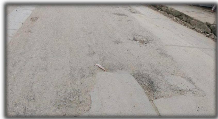
Figura 132. Huecos de severidad media (U-01)
