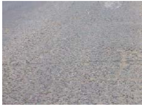
Figura 60. Falla de severidad baja (desprendimiento)
