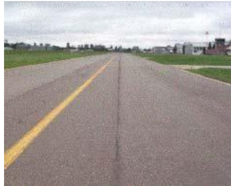
Figura 36. Falla de severidad baja (grietas longitudinales y transversales)
