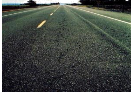
Figura 37. Falla de severidad media (grietas longitudinales y transversales)
