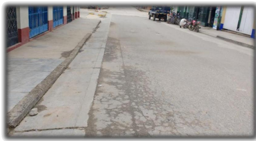
Figura 143. Piel de cocodrilo de severidad media (U-02)
