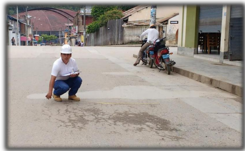
Figura 156. Piel de cocodrilo de severidad media (U-03)
