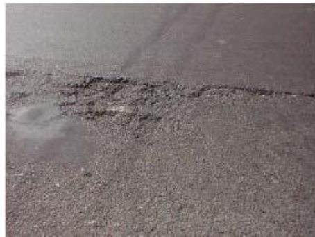
Figura 62. Falla de severidad alta (desprendimiento)
