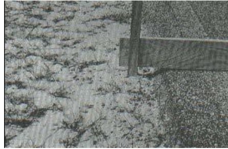
Figura 35. Falla de severidad media (berma)
