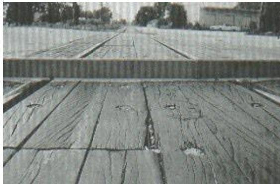
Figura 46. Falla de severidad baja (cruce vía férrea)
