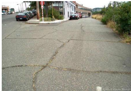
Figura 33. Falla de severidad alta (grietas)
