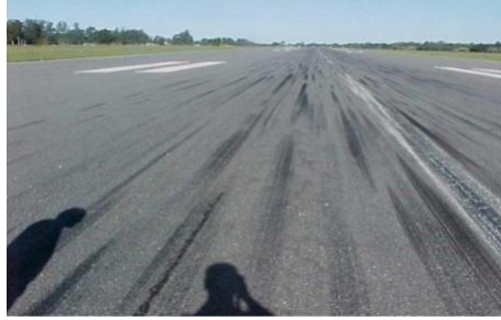
Figura 10. Falla de severidad baja (piel de cocodrilo)
