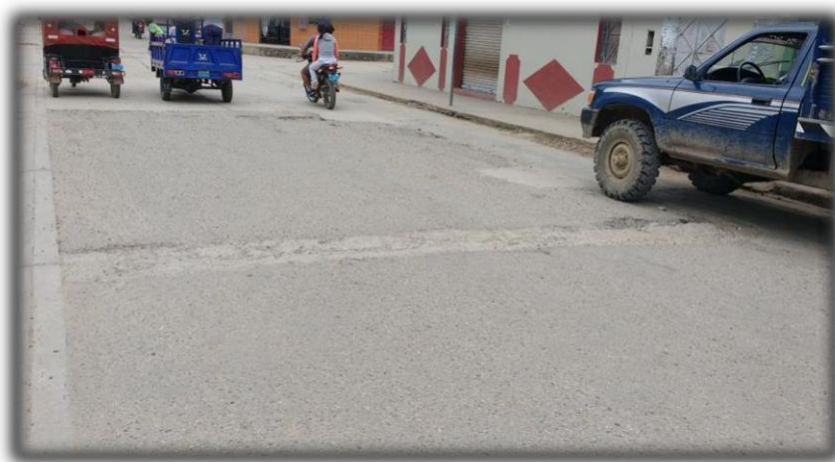
Figura 144. Parches de severidad alta (U-02)
