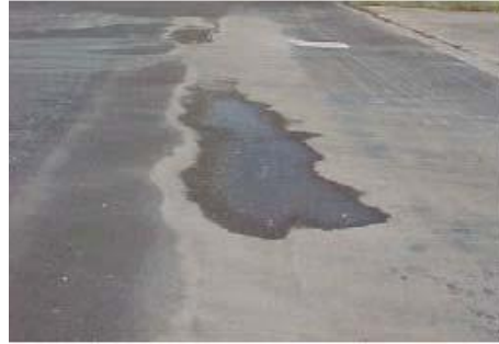
Figura 25. Falla de severidad baja (depresión)
