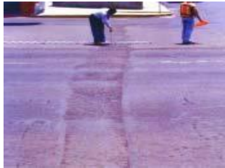
Figura 40. Falla de severidad media (parches.)
