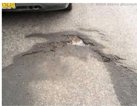
Figura 55. Falla de severidad media (grieta parabólica)
