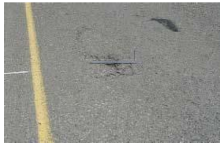
Figura 43. Falla de severidad baja (huecos)
