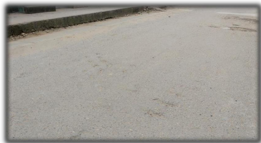
Figura 154. Huecos de severidad baja (U-03)
