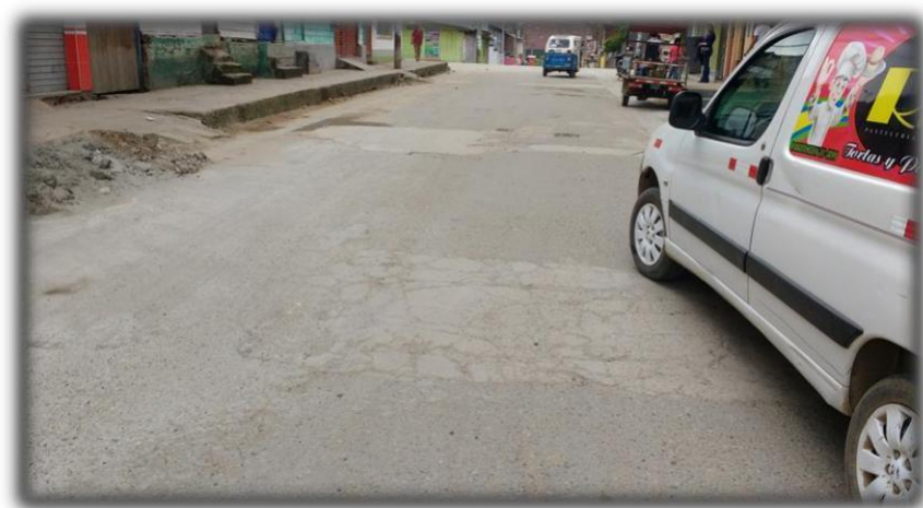
Figura 152. Parches de severidad alta (U-03)
