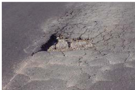
Figura 12. Falla de severidad alta (piel de cocodrilo)
