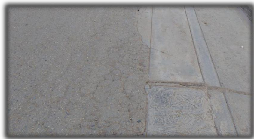
Figura 140. Piel de cocodrilo de severidad baja (U-02)
