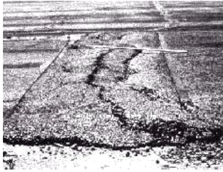
Figura 59. Falla de severidad alta (hinchamiento)
