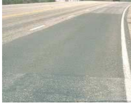
Figura 39. Falla de severidad baja (parches.)
