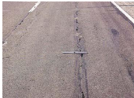
Figura 38. Falla de severidad alta (grietas longitudinales y transversales)
