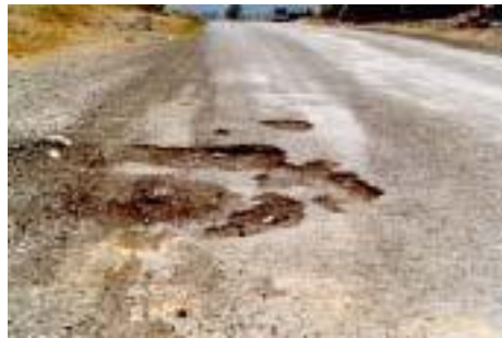
Figura 45. Falla de severidad alta (huecos)
