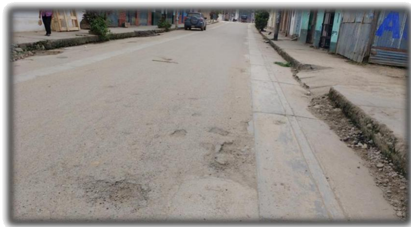
Figura 133. Huecos de severidad baja (U-01)
