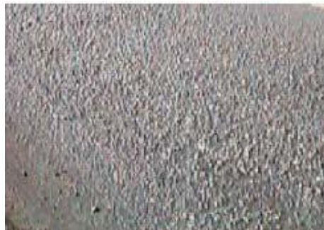
Figura 61. Falla de severidad media (desprendimiento)
