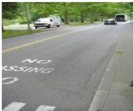
Figura 54. Falla de severidad baja (grieta parabólica)
