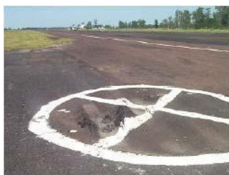
Figura 51. Falla de severidad alta (ahuellamiento)
