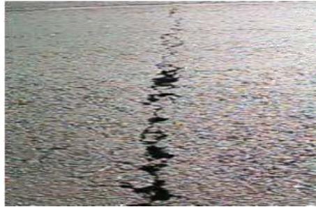
Figura 32. Falla de severidad media (grietas)
