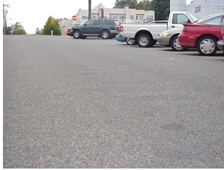
Figura 22. Falla de severidad baja (corrugación)
