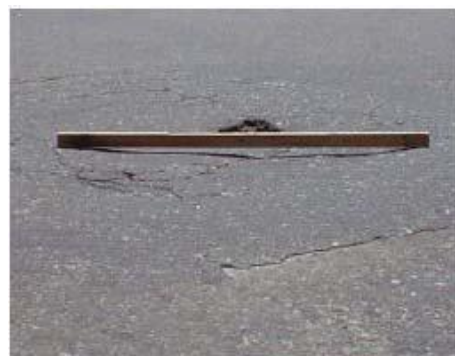
Figura 27. Falla de severidad alta (depresión)
