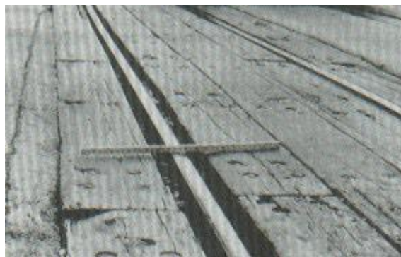
Figura 47. Falla de severidad media (cruce vía férrea)
