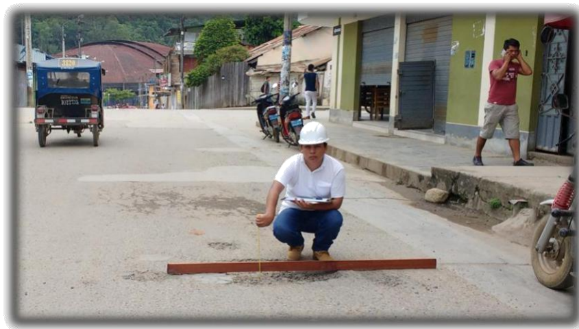
Figura 155. Huecos de severidad alta (U-03)
