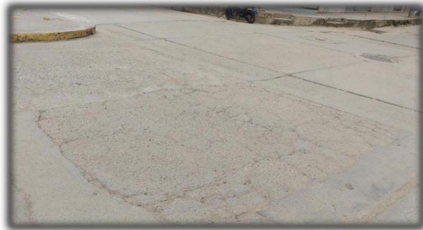
Figura 99. Parches de severidad alta en la unidad de muestra U-02
