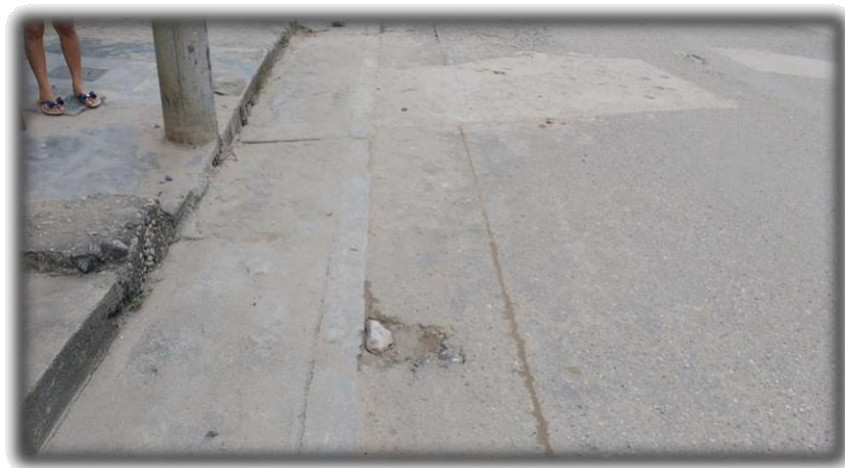
Figura 139. Huecos de severidad baja (U-02)
