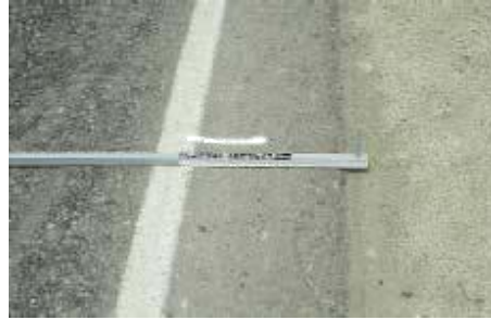
Figura 34. Falla de severidad baja (berma)
