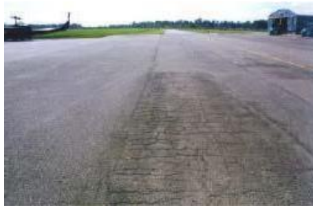
Figura 11. Falla de severidad media (piel de cocodrilo)
