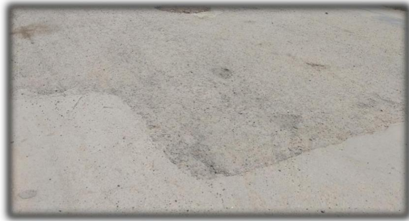
Figura 147. Huecos de severidad baja (U-03)
