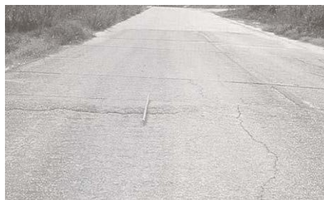
Figura 58. Falla de severidad media (hinchamiento)
