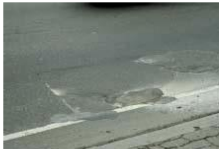
Figura 41. Falla de severidad alta (parches)
