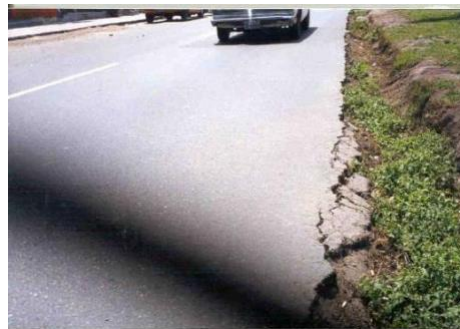
Figura 30. Falla de severidad alta (grietas de borde)
