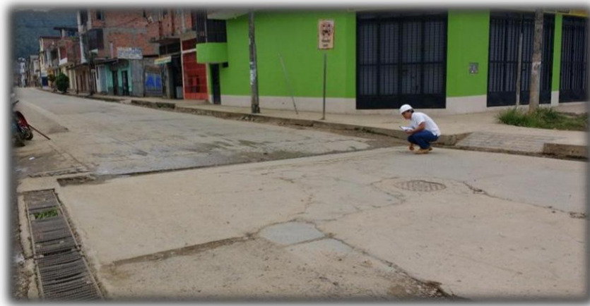
Figura 130. Parches de severidad media (U-01)
