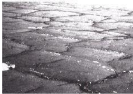
Figura 18. Falla de severidad alta (grietas en bloque)
