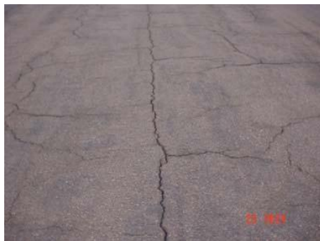
Figura 17. Falla de severidad media (grietas en bloque)
