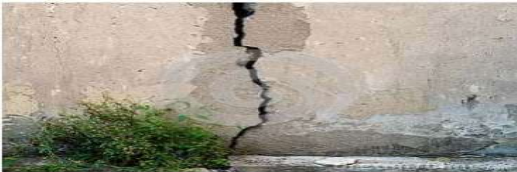
Gráfico 8: Grietas en el concreto.
