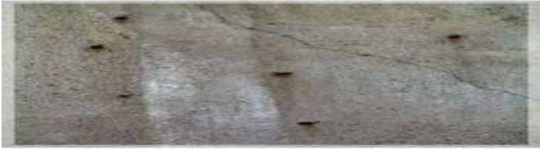
Gráfico 7: Fisura en el concreto.
