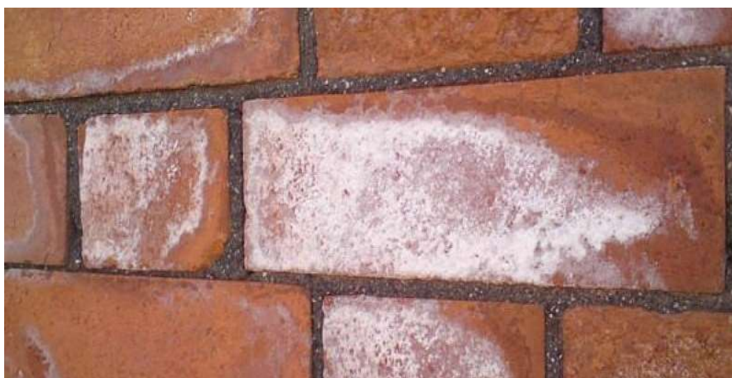
Gráfico 11: Eflorescencia en muro.
