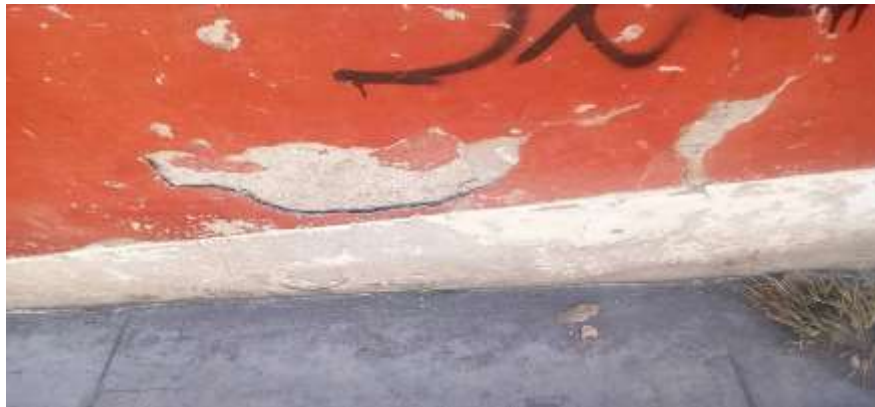
Gráfico 12: Desprendimiento de revoque.
