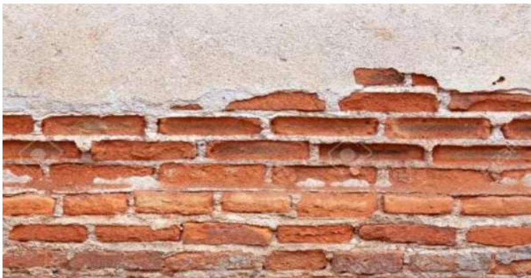
Gráfico 10: Erosión en muro.
