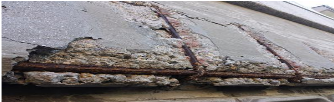
Gráfico 5. Muestra Corrosión del Acero y Desprendimiento de Concreto.
