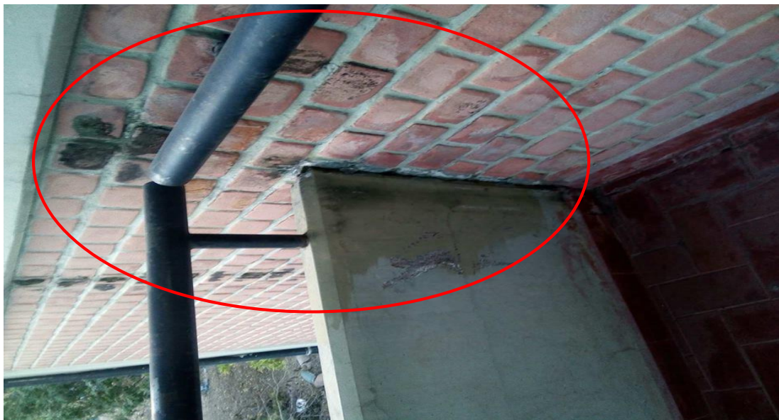
FOTOGRAFÍA 02: Muestra humedad con eflorescencias en los muros de albañilería. MU-03
