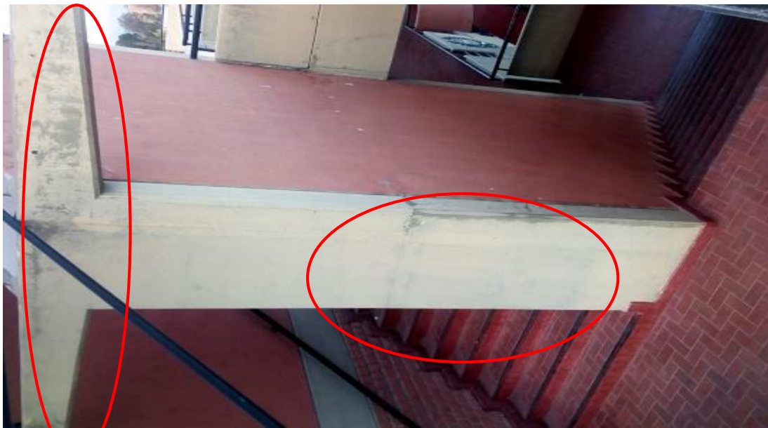
FOTOGRAFÍA 01: Muestra fallas en las columnas con fisuras y vigas fisuras y eflorescencia.MU-03
