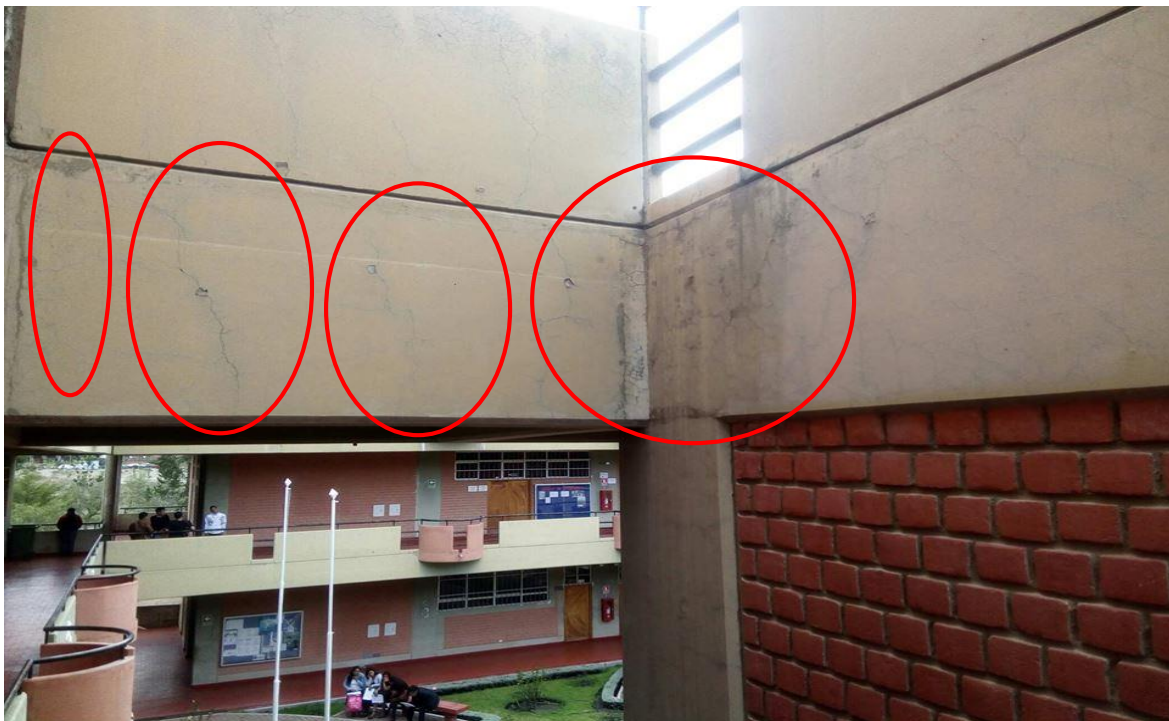
FOTOGRAFÍA 04: Muestra eflorescencia y fisuras en las vigas en la UM-09.
