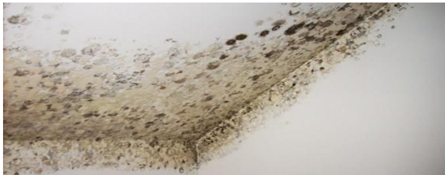
Figura 24. Moho en esquina de vivienda
