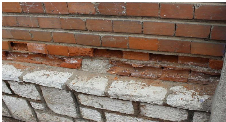
Figura 19. Erosión en muros de albañilería Nota. Fuente: (Monjo J. 1997) 22
