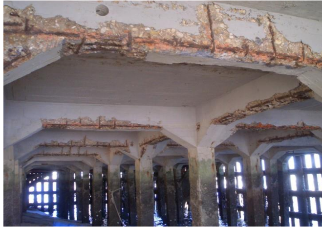
Figura 18. Corrosión en losa aligerada Nota. Fuente: (León A. 2015) 21
