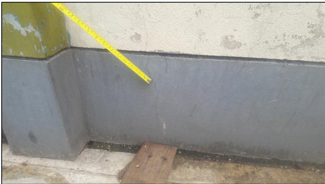
Fotografía 2: se observa en el zócalo y muro la grieta del cerco perimétrico casa comunal vinchos.
