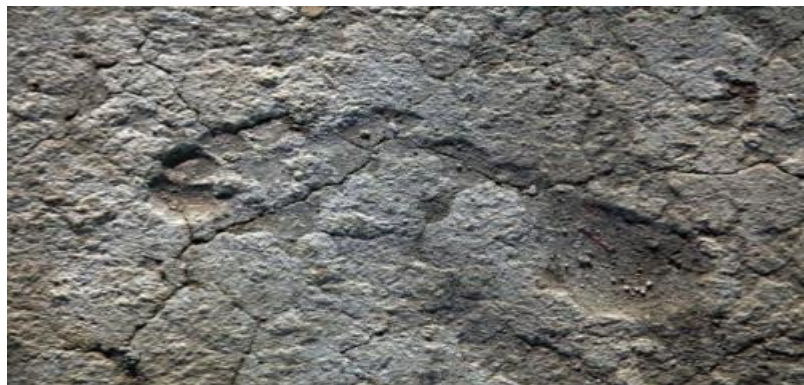
Figura 26 desintegración del concreto
