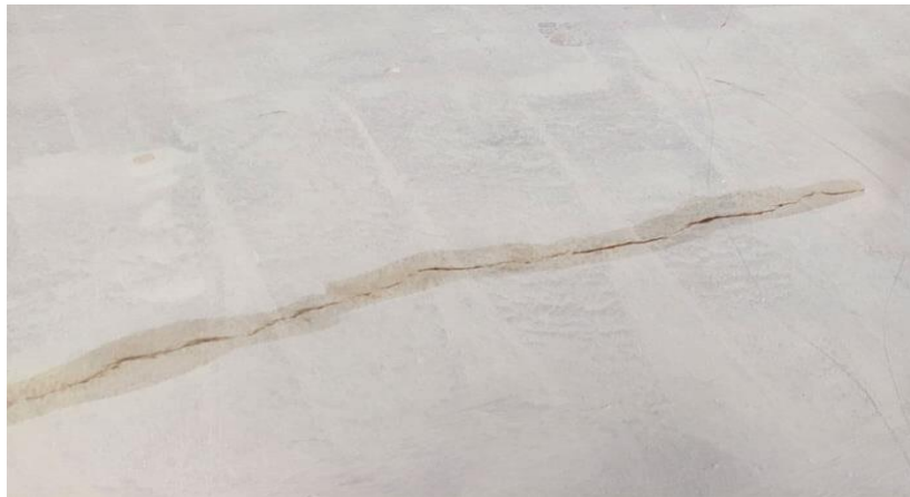
Figura 20. Fisura en muro de albañilería
