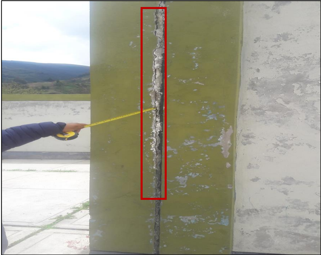
Fotografía 5: Desprendimiento en columna del cerco perimétrico de la casa comunal.
