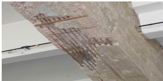
Figura 17. Patología en viga peraltada Nota. Fuente: (Casas O. 2011) 19
