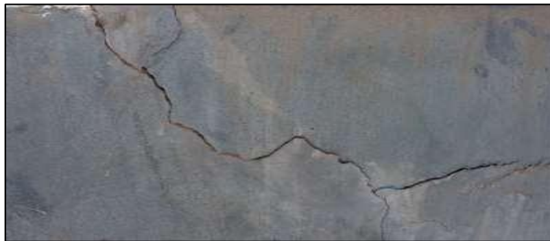
Figura 22. Grietas longitudinales Nota. Fuente: (Clarín A. 2012) 25
