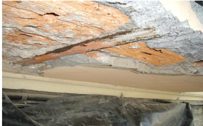
Figura 16. Patología en losa Nota. Fuente: (Trevino E. 1998) 18
