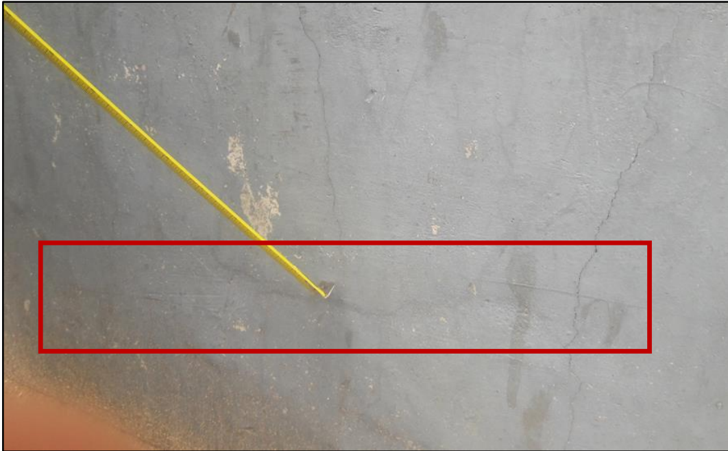
Fotografía 1: Grieta en muro del cerco perimétrico de la casa comunal.
