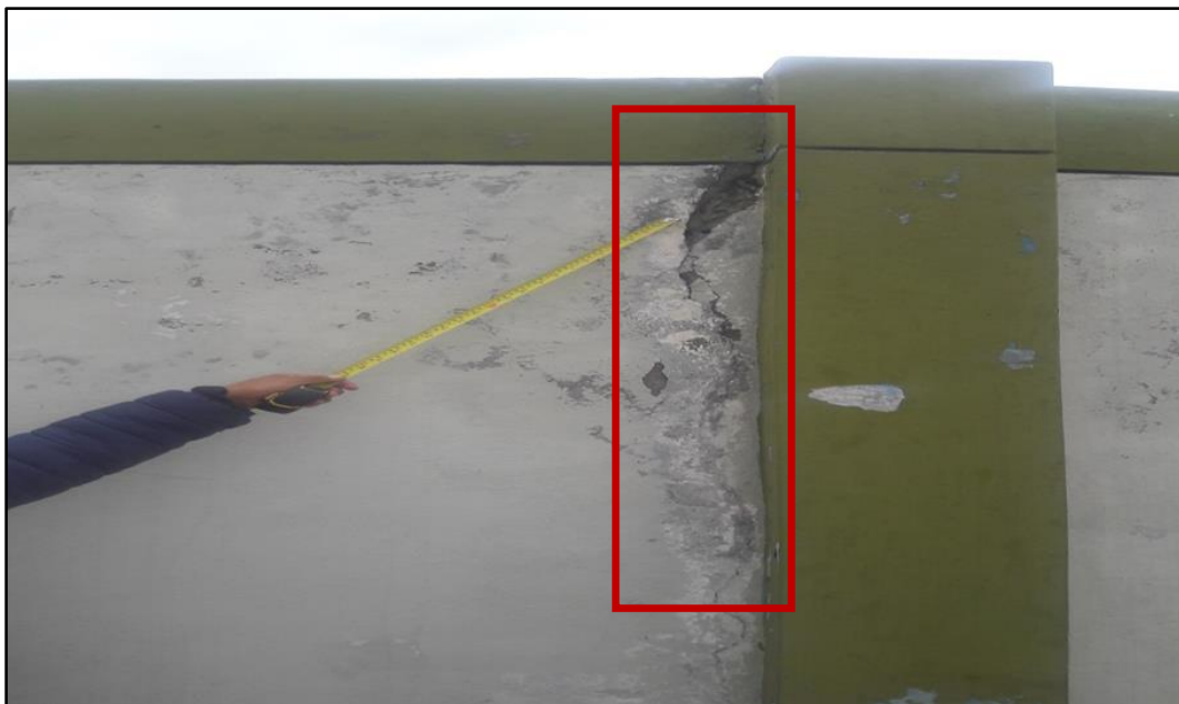
Fotografía 4: Desintegración en muro del cerco perimétrico de la casa comunal.
