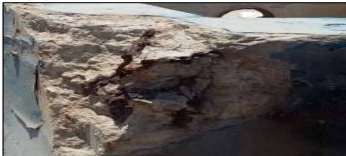
Figura 23. Desprendimiento en la esquina de una columna Nota. Fuente: (Castillo S, André C, Falcón C, Felpe L. 2015) 26
