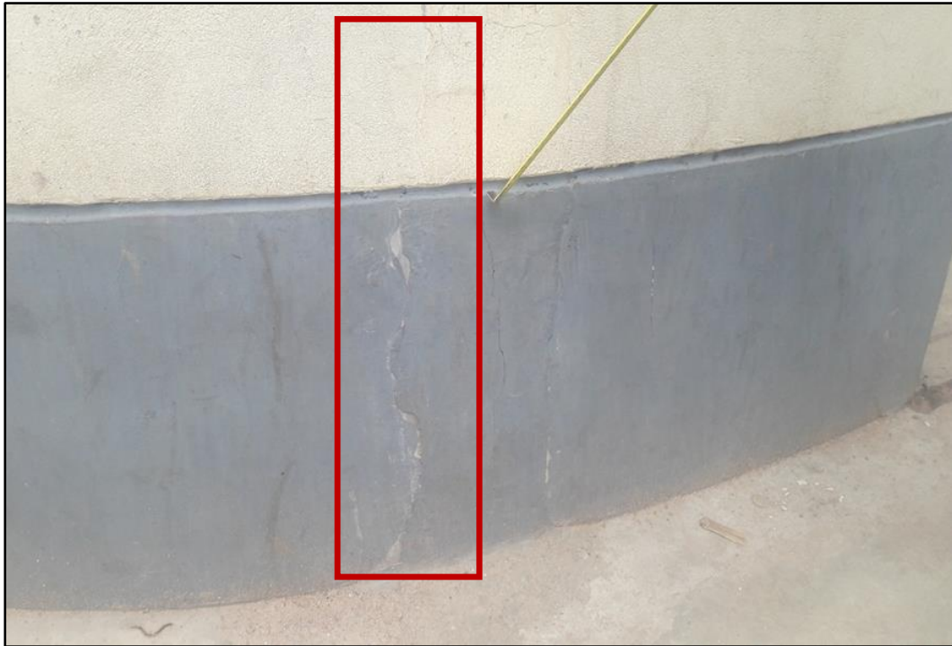
Fotografía 3: se observa la grieta en el cerco perimétrico del muro de la casa comunal Vinchos.
